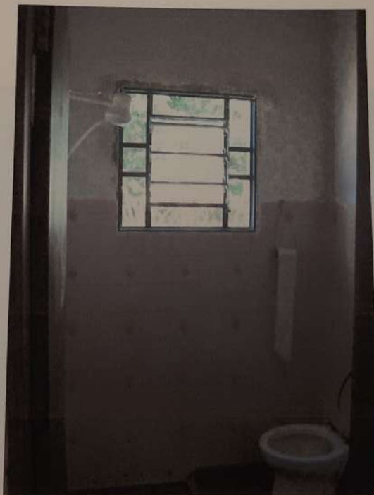
VISTA DO BANHEIRO DO IMÓVEL OBJETO DA PRESENTE AÇÃO.
