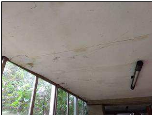
Foto 47 – Forro de gesso da passarela.
