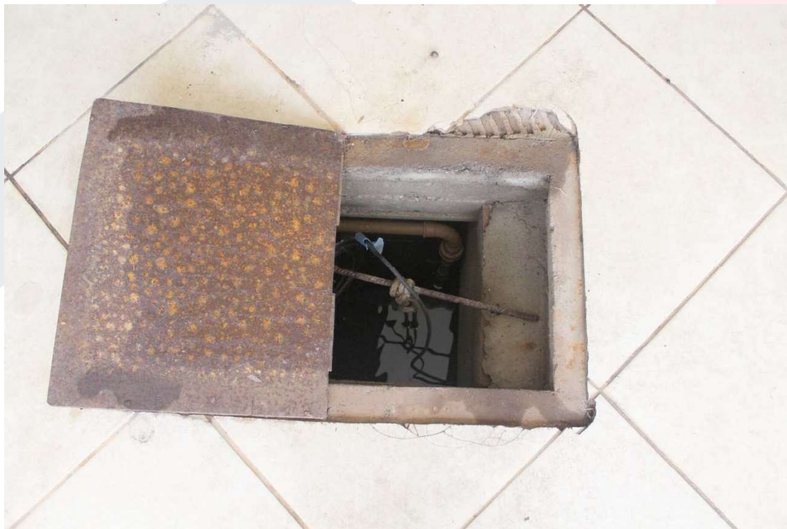
VISTA DA CISTERNA DE CAPTAÇÃO DE AGUA DE CHUVA.
