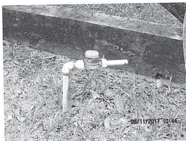
Vista de hidrômetro sem ligação de água para o imóvel
