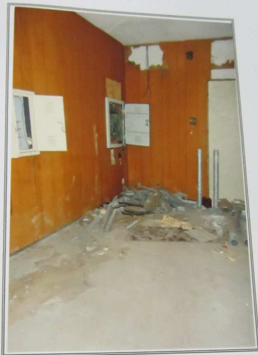
FOTO 11 - Vista de outra sala podendo ver o quadro de luz do conjunto em lide.
