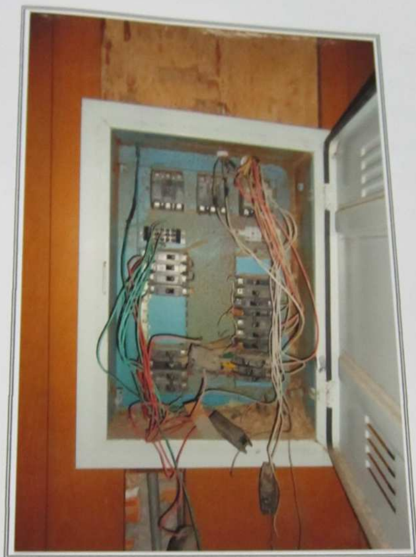
FOTO 12 - Vista em detalhe do quadro de luz.
