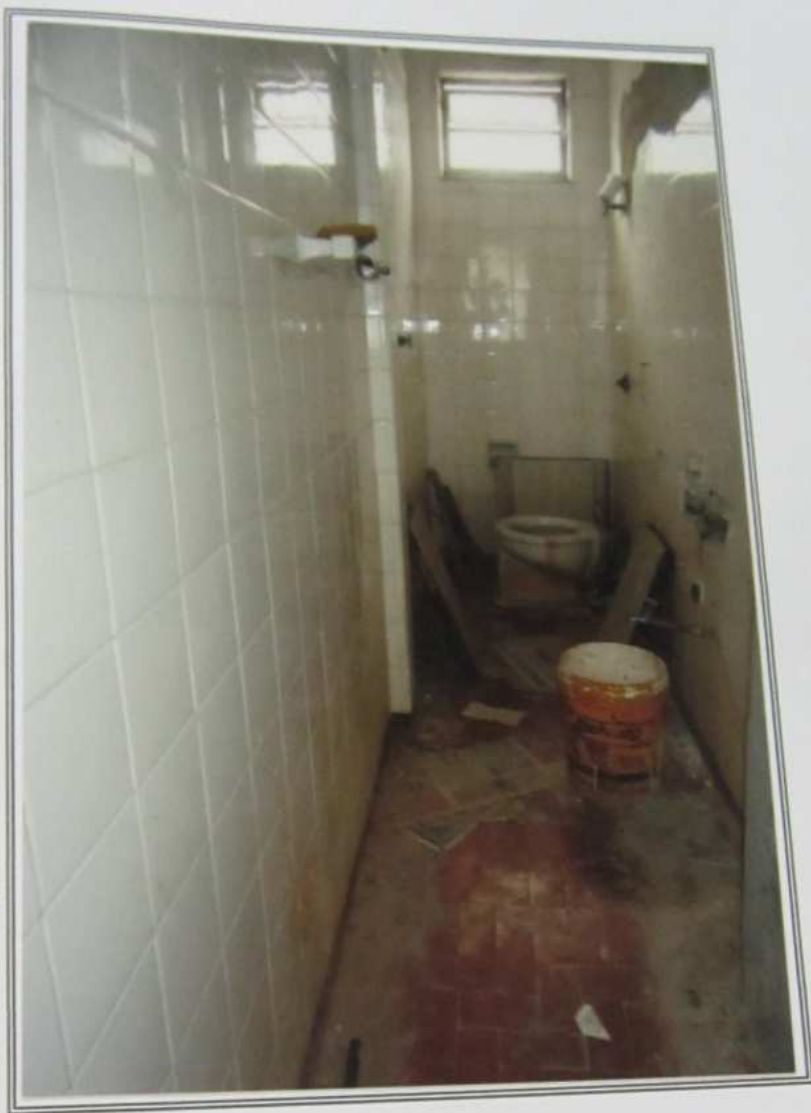
FOTO 08 - Vista de outro banheiro com acabamentos idênticos aos da foto retratada anteriormente.
