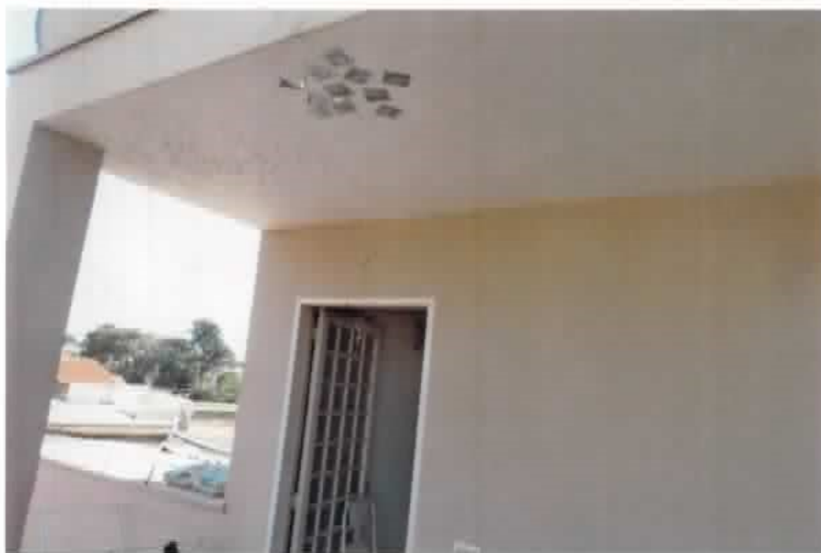
FOTO- 14 – VISTA EXTERNA DA COBERTURA DO APARTAMENTO Nº 12, MATRICULA Nº 31.251, DESTAQUE PARA ÁREA C.E LAZER , TETO E PORTA DE ACESSO. DATA: 27 DE MAIO DE 2019.
