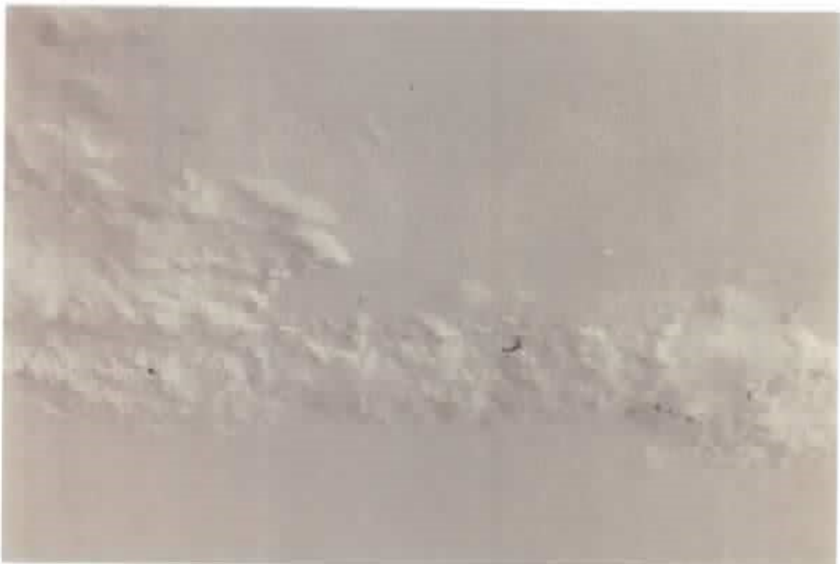
FOTO- 16 - VISTA EXTERNA DA COBERTURA DO APARTAMENTO Nº 12, MATRICULA Nº 31.251. DESTAQUE PARA INFILTRAÇÕES NO TETO E DANOS NA PINTURA. DATA: 27 DE MAIO DE 2019.
