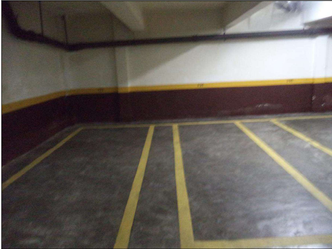
A imagem ilustra as garagens da unidade em questão.
