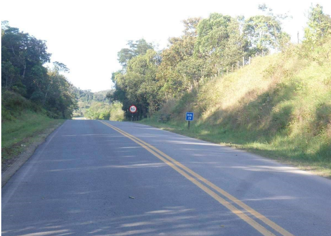
Km 19, sentido Sete Barras/Juquiá (foto 02)
