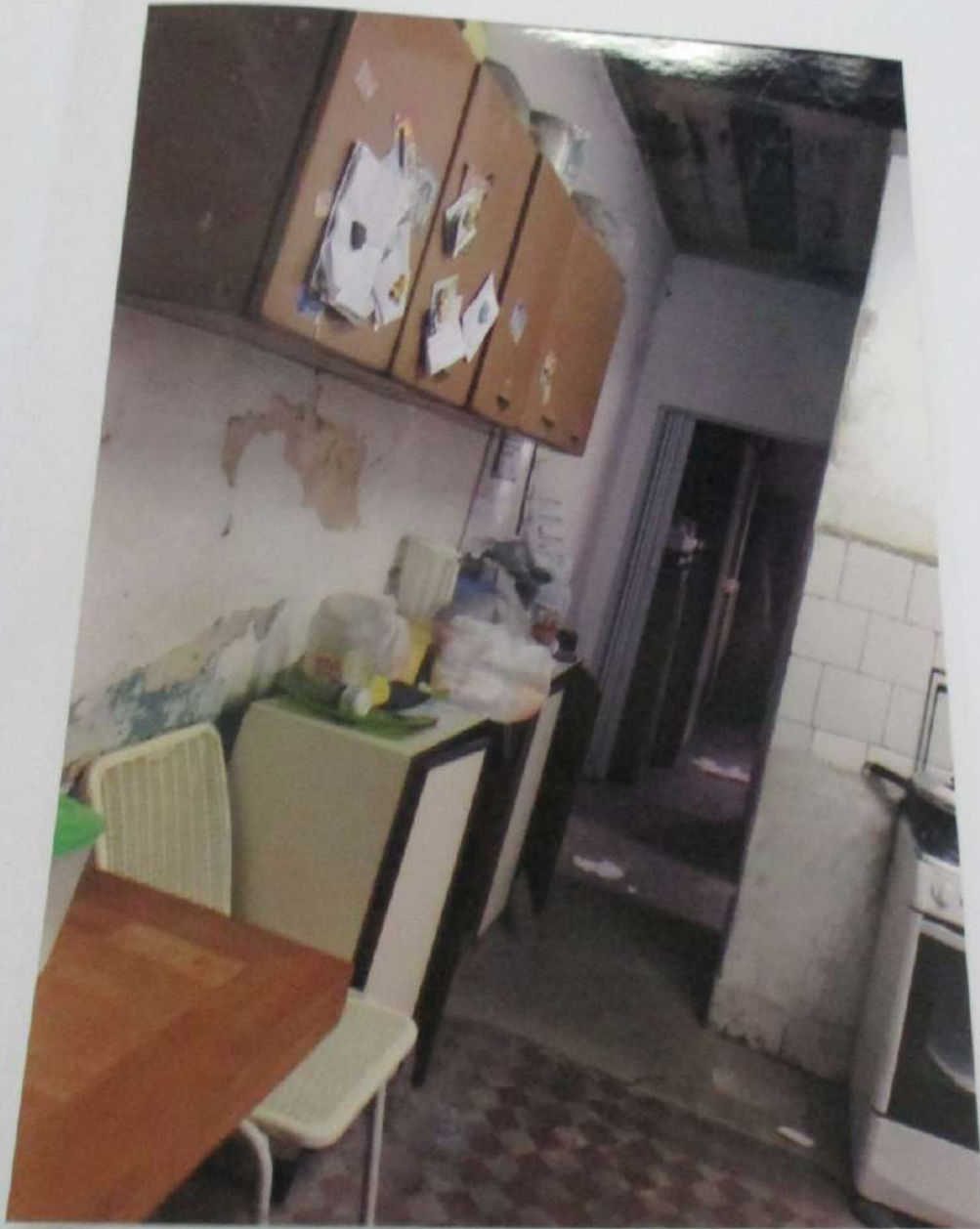
Foto Parede da cozinha
