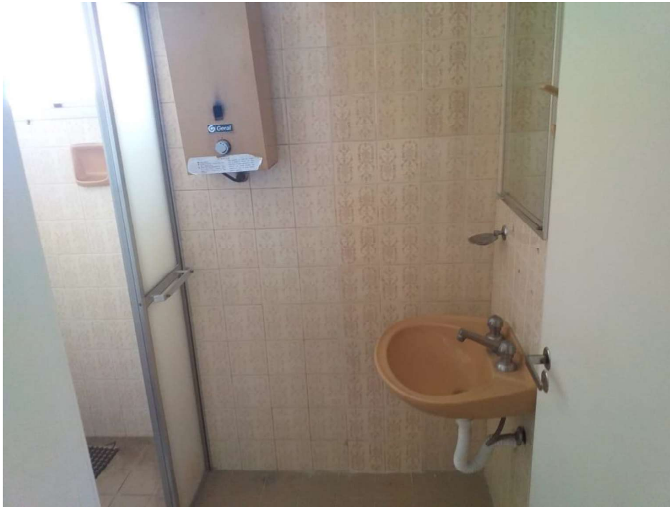
Banheiros com instalações hidráulicas básica com peças sanitárias e respectivos componentes de padrão comercial.
