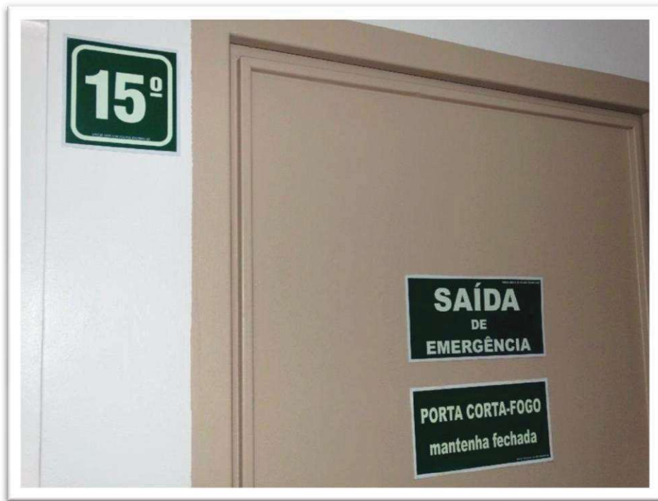
Foto nº 42 - Vista da porta corta-fogo no hall de elevadores, no 15º andar do “EDIFÍCIO BASE DAS CANOAS”.
