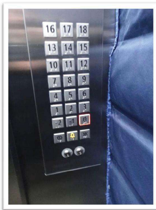
Foto nº 8 - Vista da botoeira do elevador do “EDIFÍCIO BASE DAS CANOAS”.
