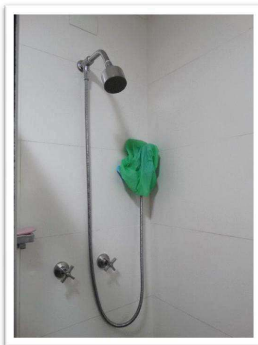
Foto nº 33 - Outra vista parcial do banheiro social do imóvel objeto da presente vistoria.
