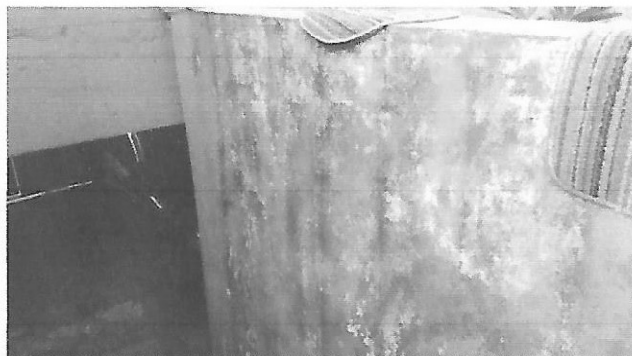
Foto 10: Acesso da garagem (manchas na parede)
