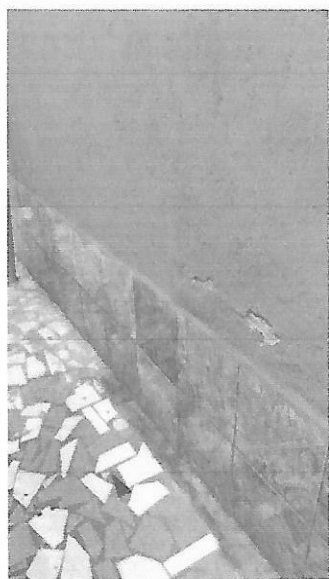
Foto 11: Corredor/Parede da casa térrea (pintura descascando em ponto isolado)
