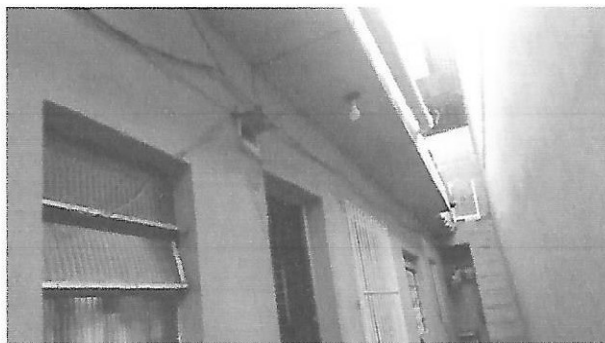
Foto 9: Corredor/Entrada da casa 1 e acesso a casa 2 (Fiação exposta)
