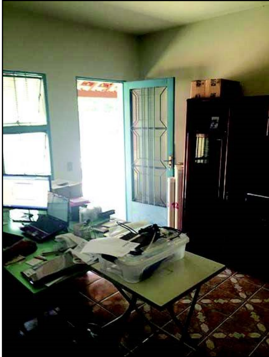
VISTA DA SALA - EDÍCULA (PAREDES APRESENTAM TRINCAS)
