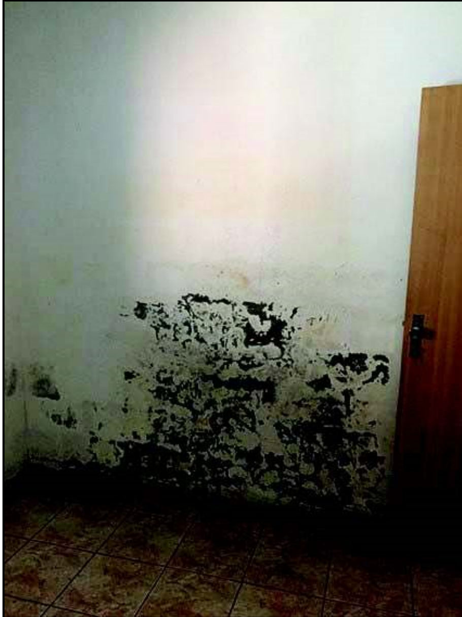
DETALHE DO DORMITÓRIO 02 - EDÍCULA (PAREDES APRESENTAM TRINCAS E PONTOS DE UMIDADE)
