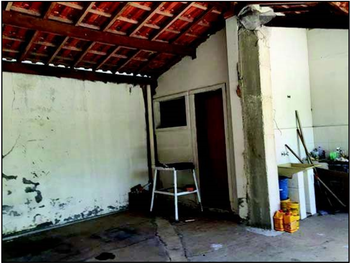
VISTA GERAL DA GARAGEM E LOCALIZAÇÃO DO BANHEIRO EXTERNO - EDÍCULA (PAREDES DO BANHEIRO APRESENTAM RACHADURAS)
