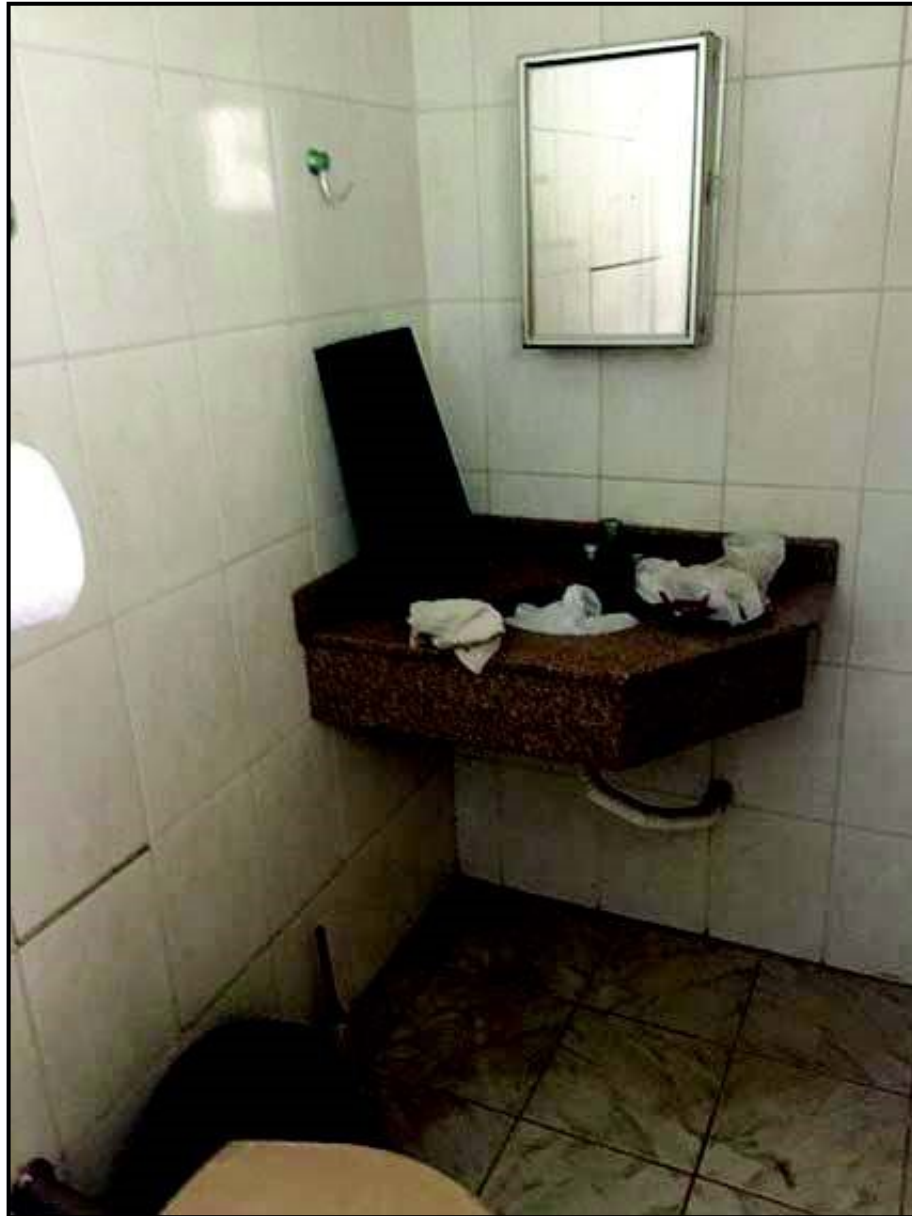
VISTA DO BANHEIRO - EDÍCULA (PAREDES APRESENTAM TRINCAS)
