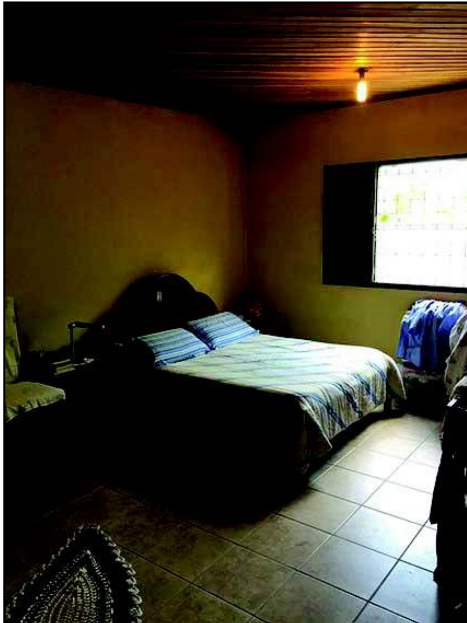
VISTA DO DORMITÓRIO DA SUÍTE - CASA PRINCIPAL (PAREDE E TETO APRESENTAM MANCHAS DE UMIDADE)
