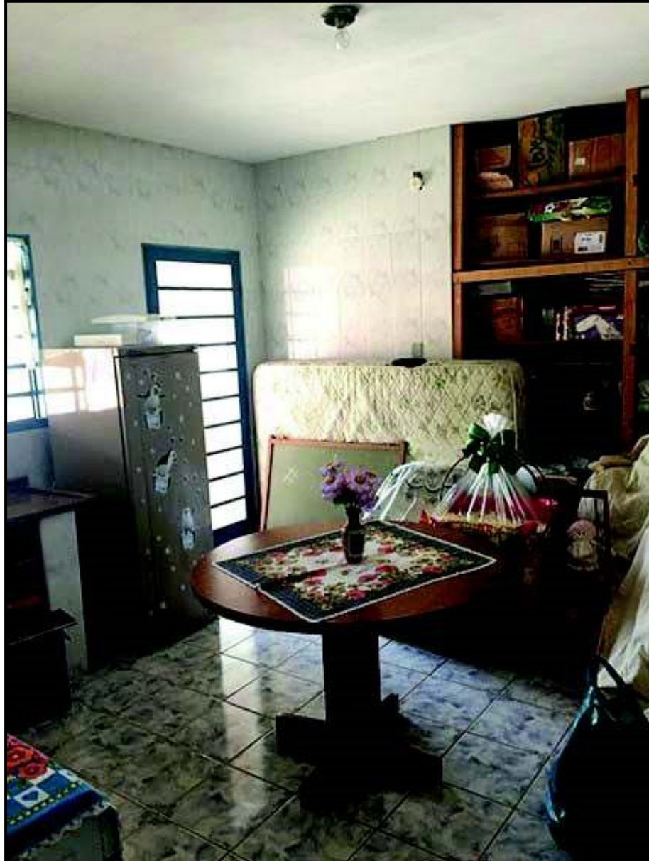
VISTA DA COZINHA - EDÍCULA (PAREDES APRESENTAM TRINCAS)
