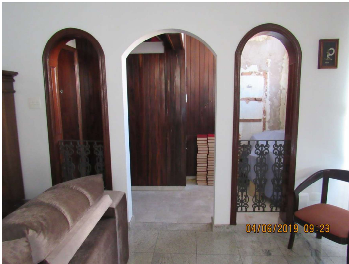
Imagem 25: vista para hall de entrada da unidade: a direita, pontos de umidade ao centro, revestimento de madeira deteriorado
