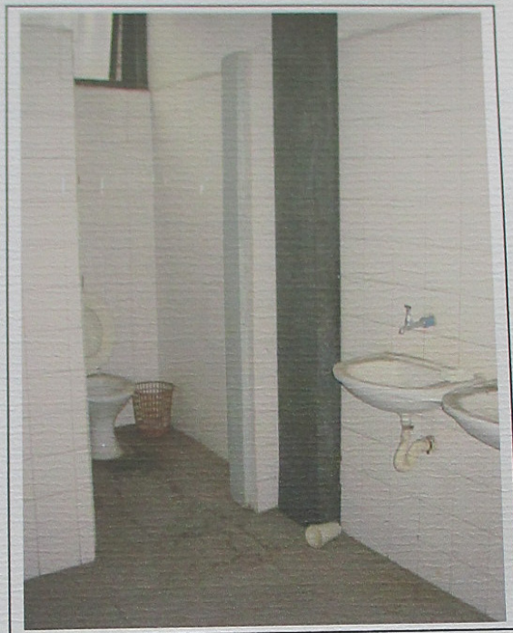
Foto 13: Rua Águas de Xapecó nº 330. Vista do banheiro feminino no piso inferior.
