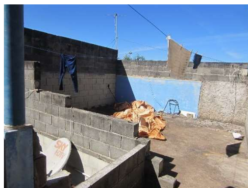
9. LAJE SEM COBERTURA.
