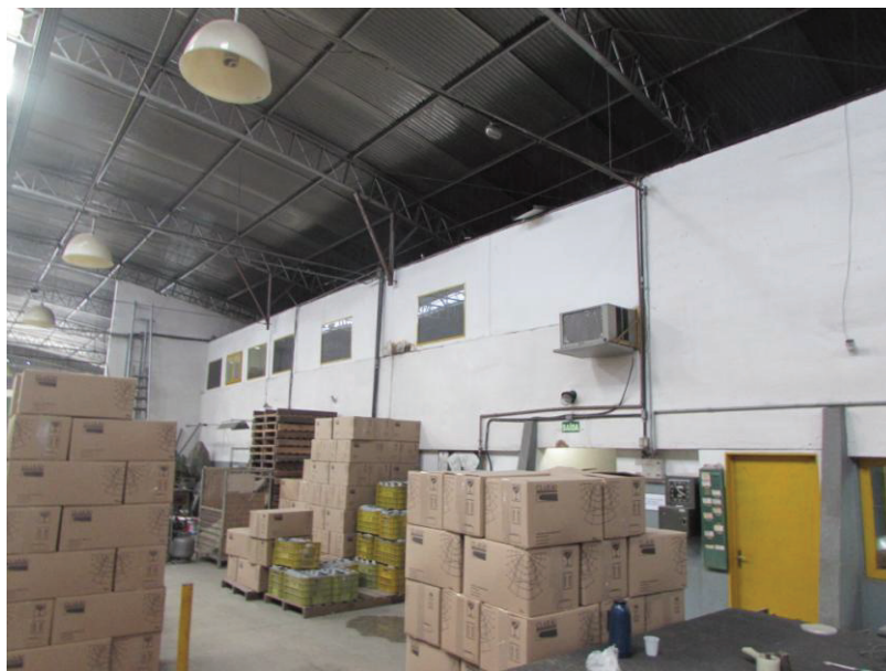
FOTO 3 – Nesta foto tem-se uma vista interna do referido galpão, podendo observar o piso de concreto, bem como a estrutura metálica da cobertura.
