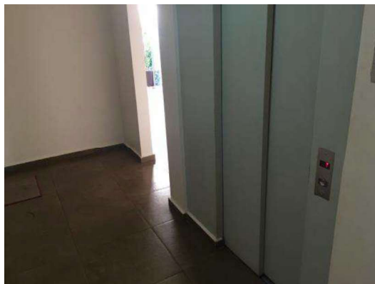
Foto 9 – Hall de elevador – Edifício Amazonas
