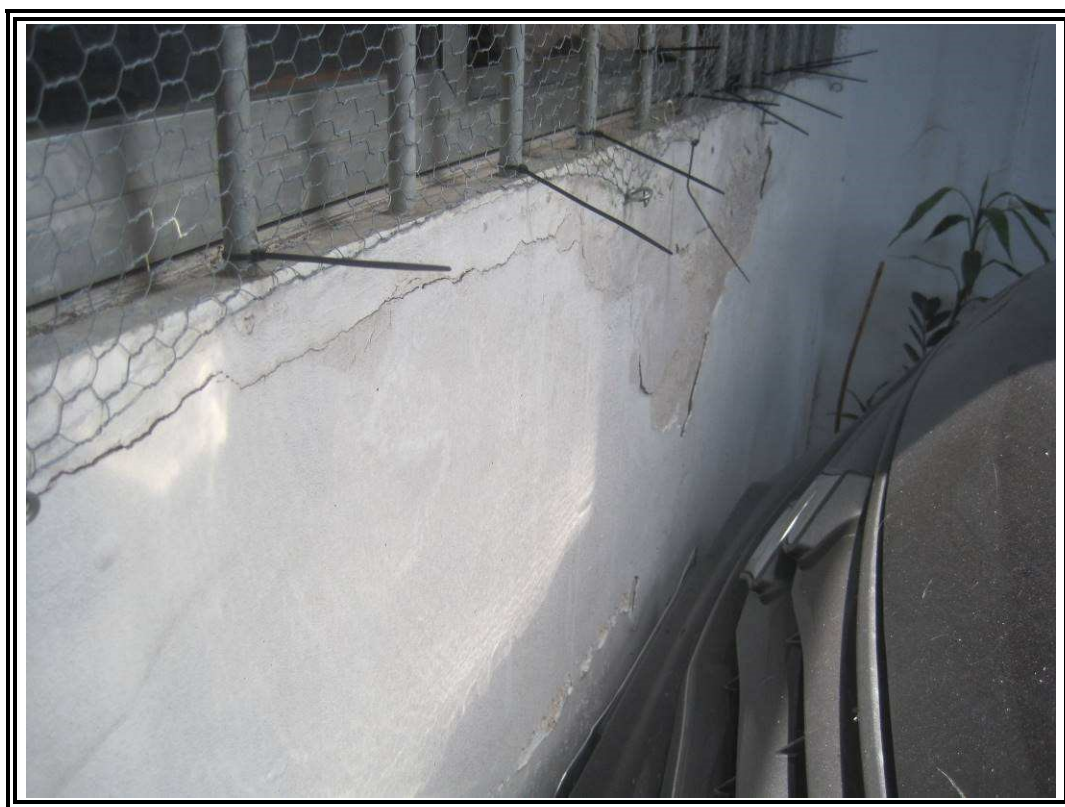
Foto nº 10: Detalhe da parede da garagem descascando e com trincas evidentes
