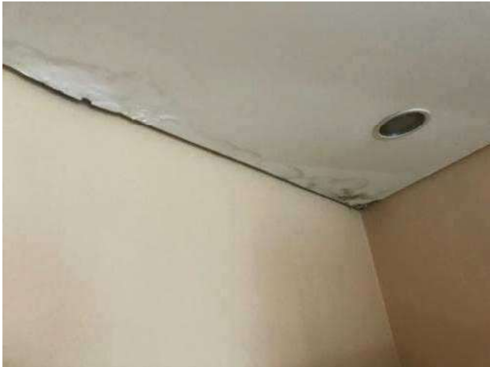
Foto 19: Vista das infiltrações no teto do salão - Segundo pavimento.
