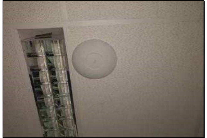
ITEM 1,392 - ANTENA WI-FI UBIKITI UNIFI LOCAL: SALA DE DESCOMPRESSÃO
