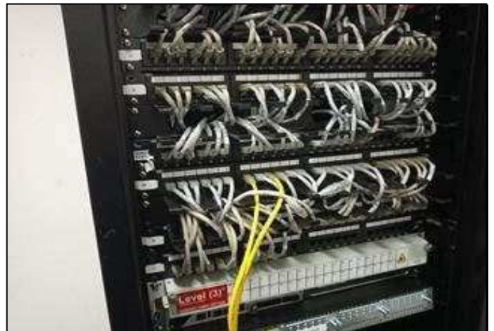
ITENS 1,432/1,437 - PATCH PANEL SOHO PLUS CAT5E LOCAL: SERVIDOR
