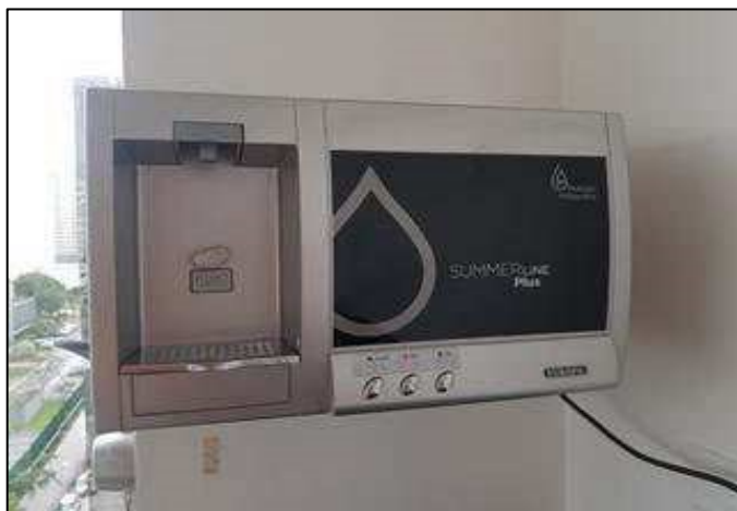
ITEM 2,271 - FILTRO DE ÁGUA EUROPA SUMMER LINE PLUS LOCAL: COPA 2
