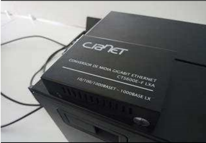
ITEM 1,415 - CONVERSOR MÍDIA GIGABIT ETHERNET CIANET LOCAL: SERVIDOR
