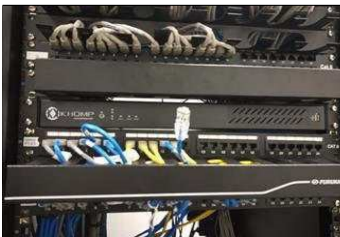
ITEM 1,407 - EBS SERVER KHOMP LOCAL: SERVIDOR
