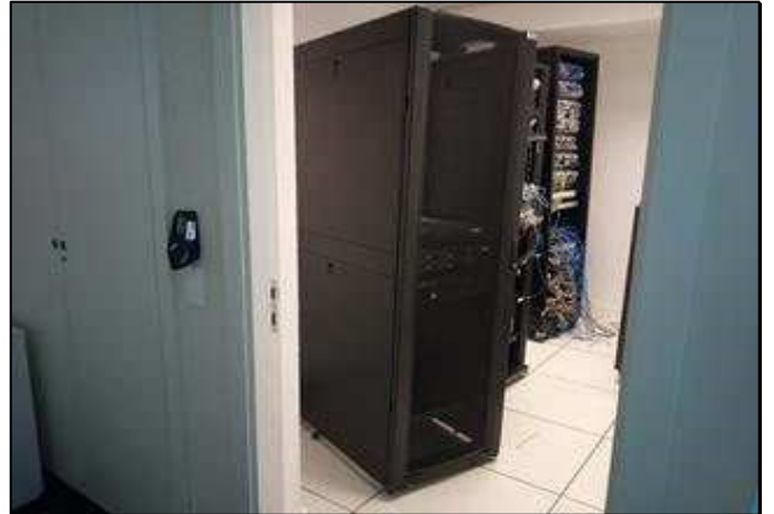
ITEM 1,398 - RACK SERVIDOR APC LOCAL: SERVIDOR
