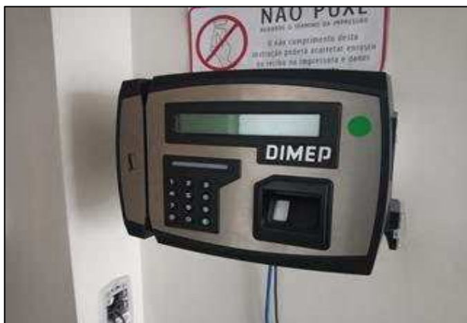
ITEM 1,443 - RELÓGIO DE PONTO DIMEP PRINT POINT II V2 BB LOCAL: CORREDOR
