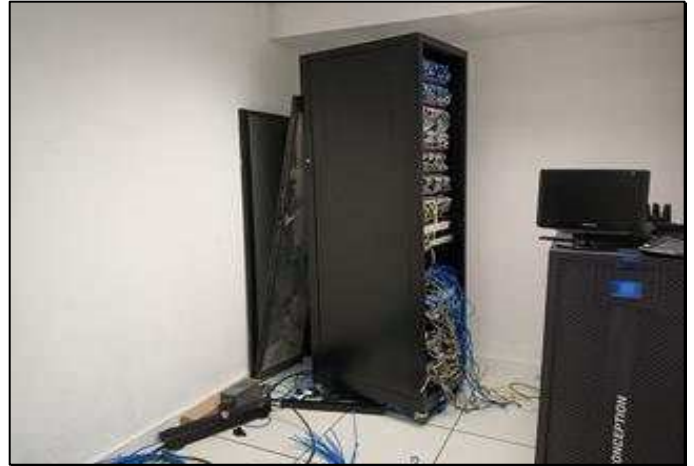
ITEM 1,416 - RACK SERVIDOR GRANDE LOCAL: SERVIDOR
