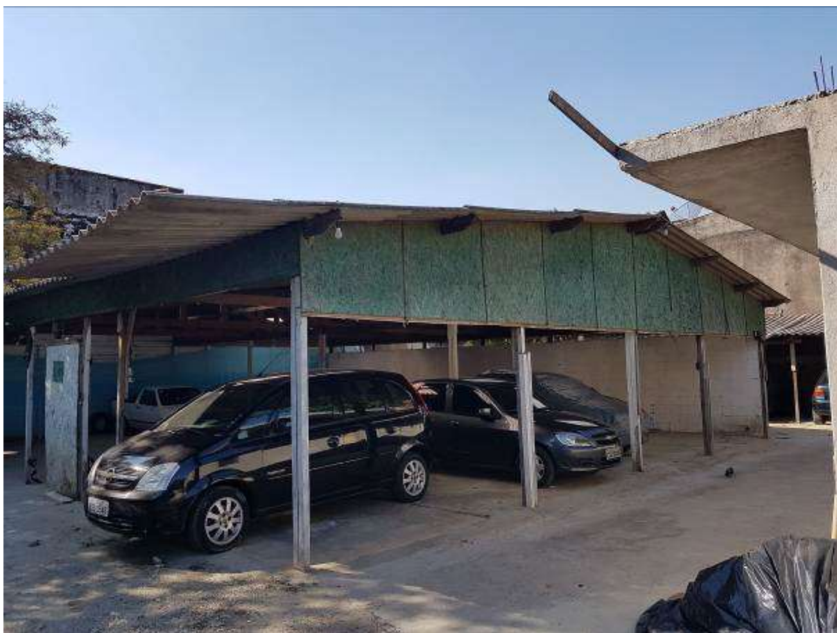
FOTO 44: OUTRA VISTA DAS EDIFICAÇÕES IRREGULARES INSERIDAS SOBRE O LOTE 27.
