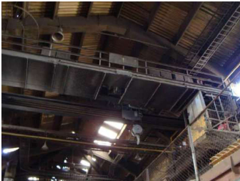
Ponte rolante 10 ton
