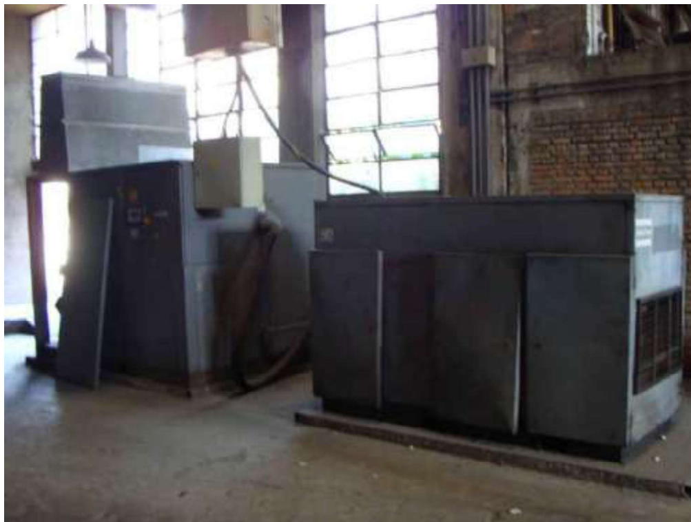
Compressores estacionários ATLAS COPCO - GA160
