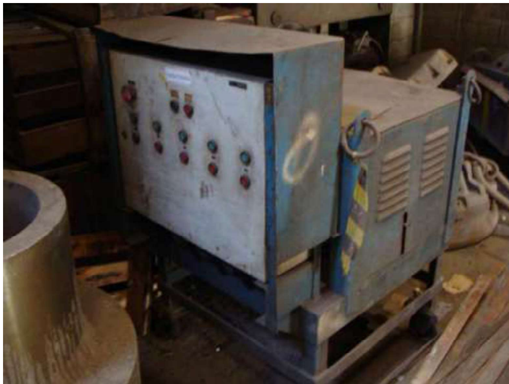
Transformador s/ marca aparente modelo MG2737
