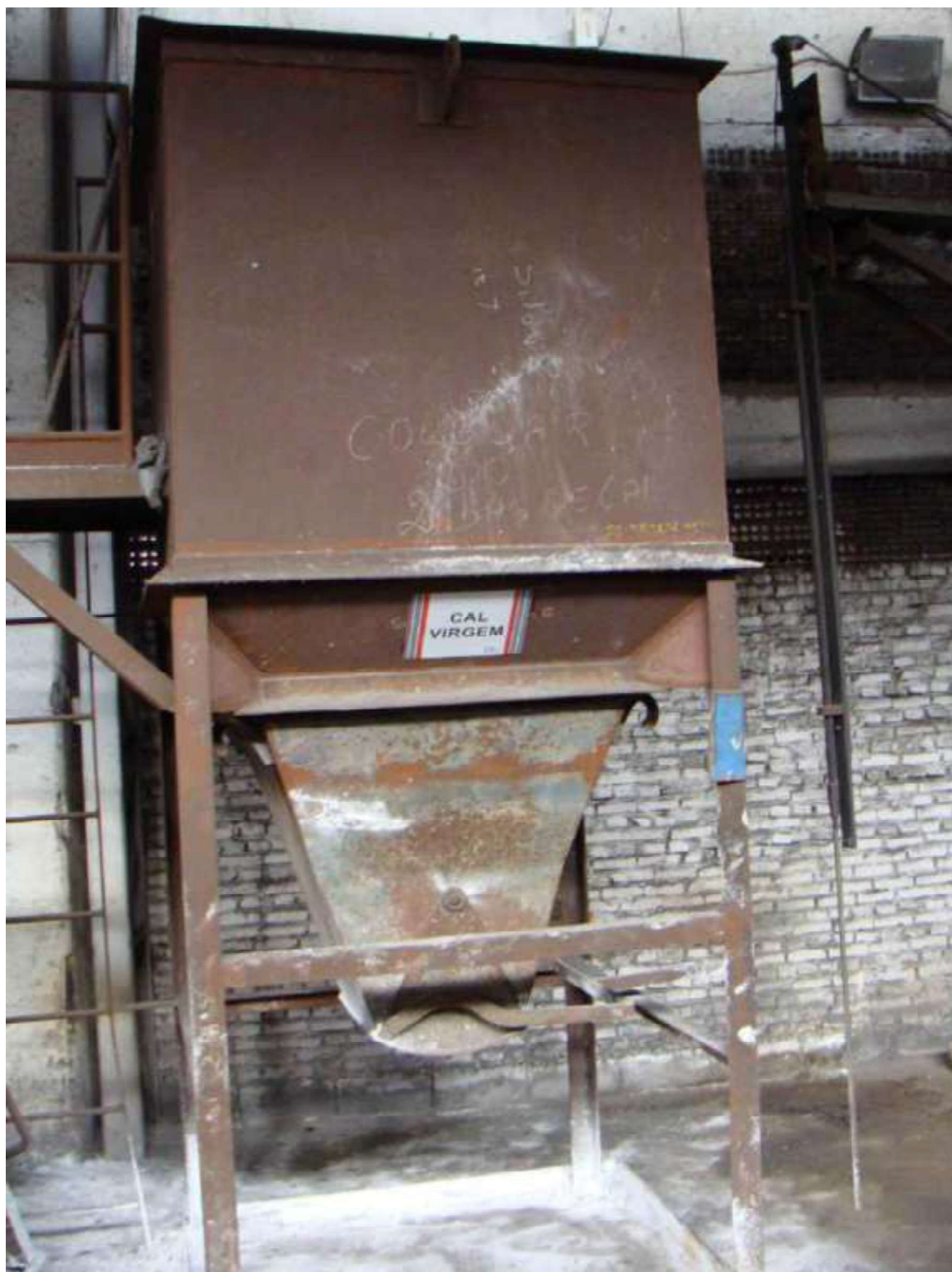
Silo de cal
