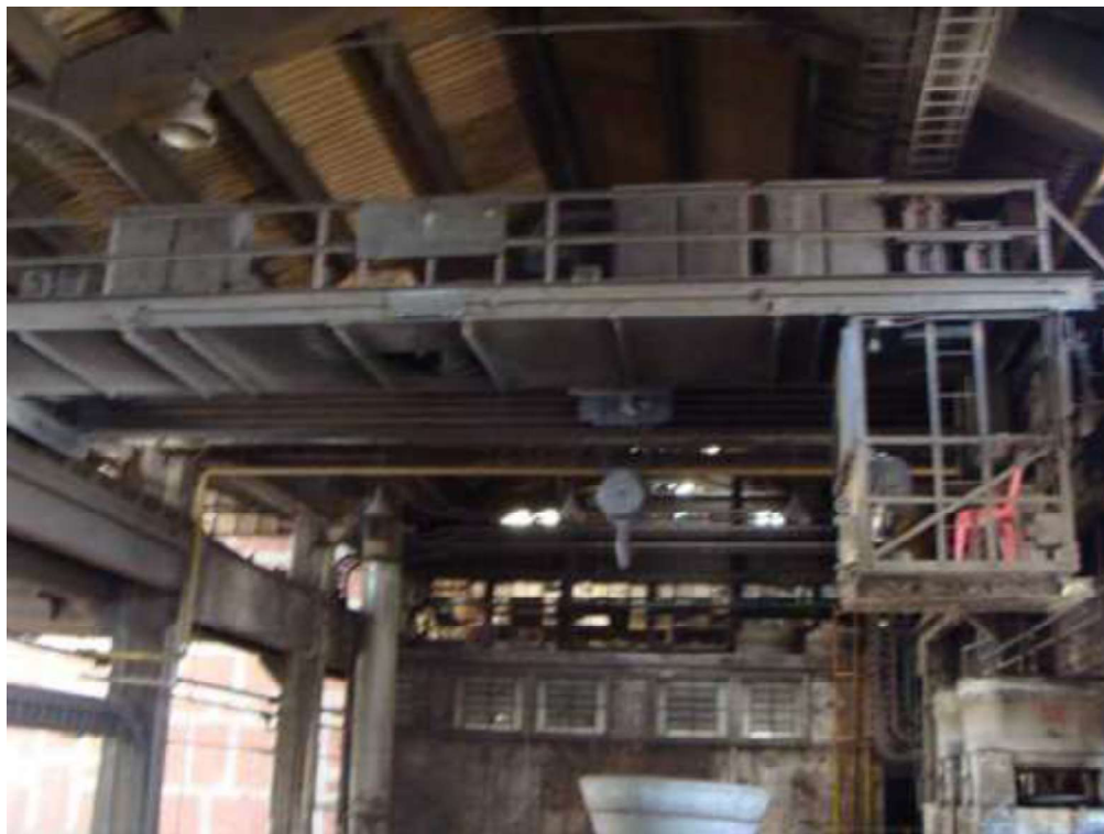
Ponte rolante 10 ton
