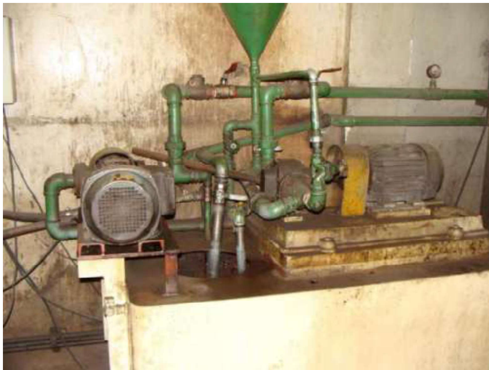
Bomba hidráulica com 2 motores acoplados
