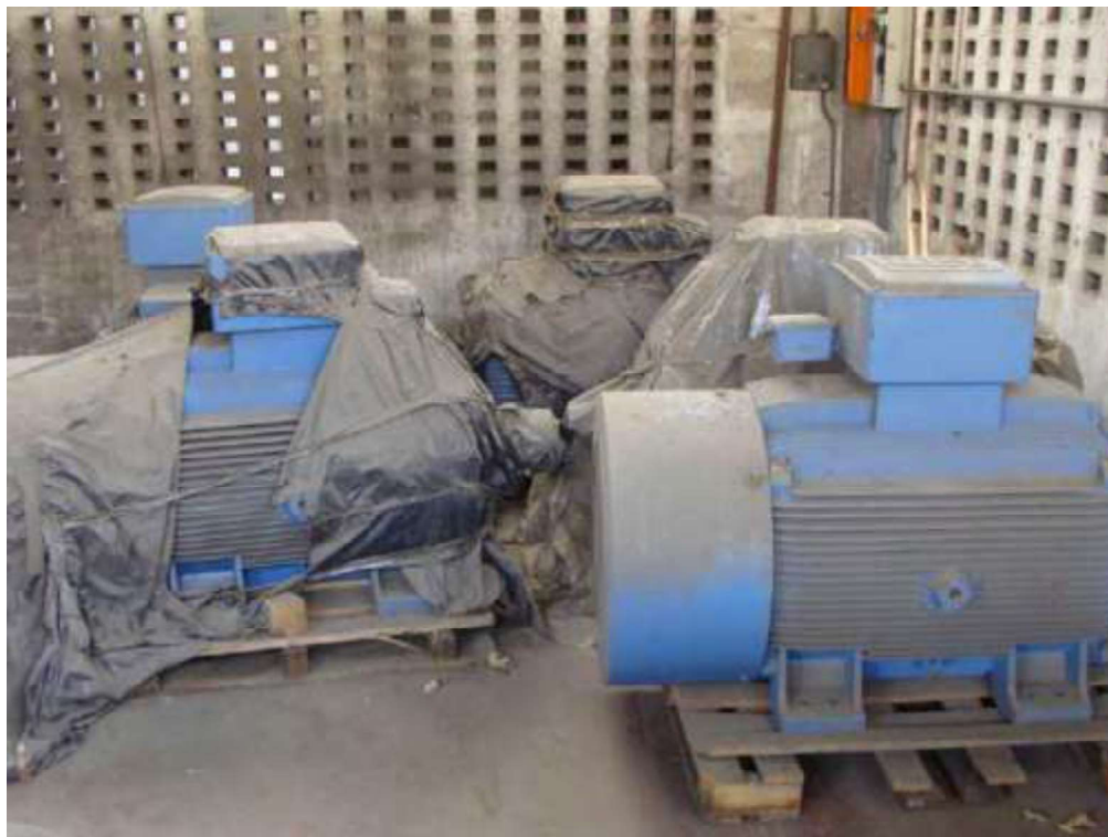
Motores WEG-350 CV
