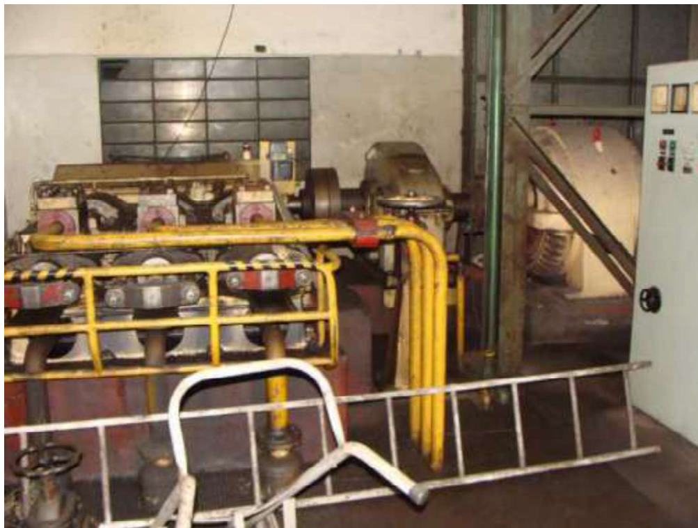
Bombas de resfriamento 4Kg/cm 2
