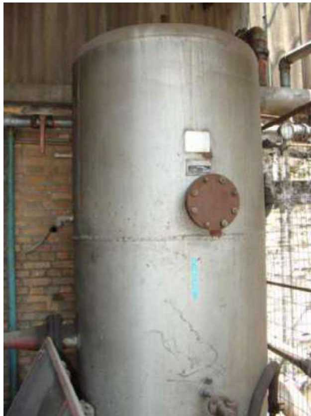
Reservatório de ar comprimido capacidade 8 Kg/cm 2
