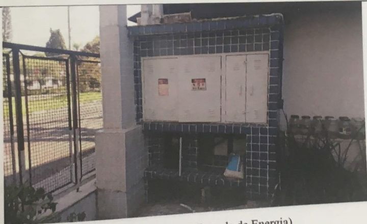
(Foto 18 – Caixa de Entrada de Energia)
