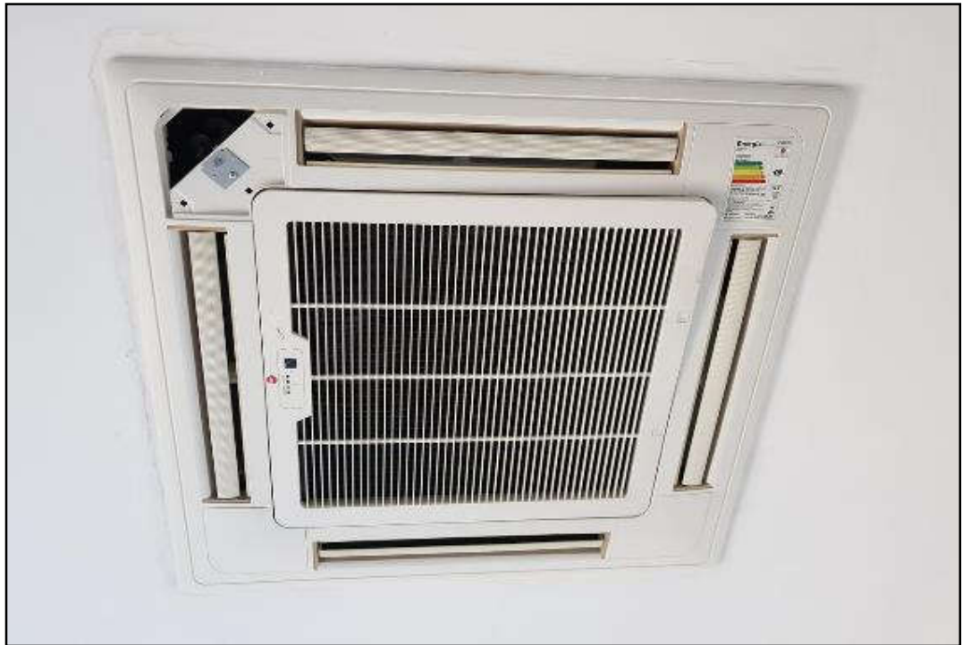
ITEM 2,055 - VISTA DO AR CONDICIONADO SPLIT CASSETE 38.000 BTU RHEEM
