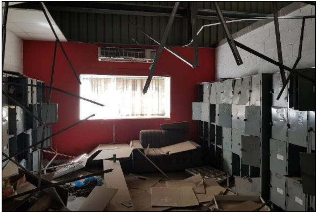
ITEM 5,087 - VISTA DO ARMÁRIO DE AÇO 8 PORTAS
