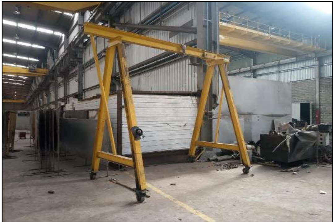
ITEM 1,057 - VISTA DO PÓRTICO MÓVEL 600KG
