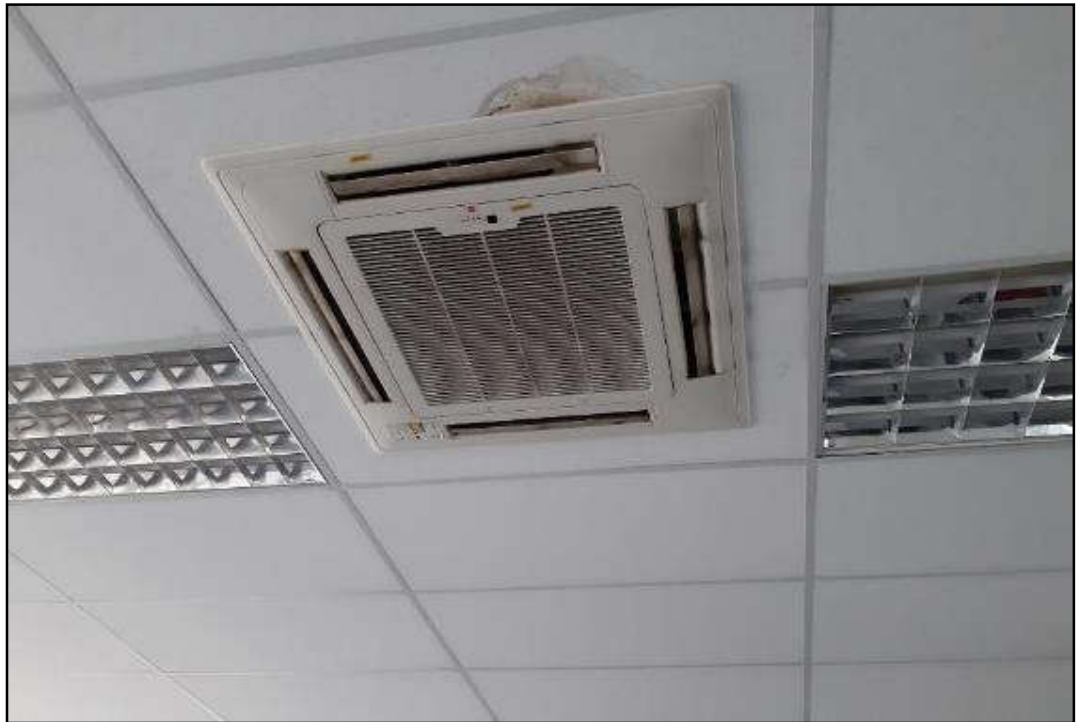
ITEM 2,120 - VISTA DO AR CONDICIONADO SPLIT CASSETE 38.000 BTU RHEEM
