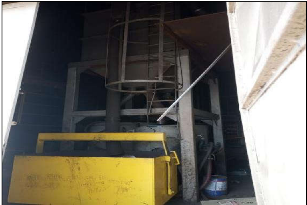
ITEM 1,039 - VISTA DA CABINE DE PINTURA
