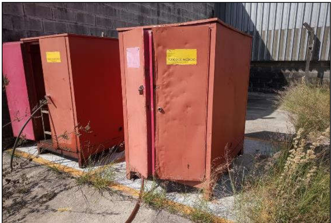
ITEM 5,094 - VISTA DO ARMÁRIO CORTA FOGO
