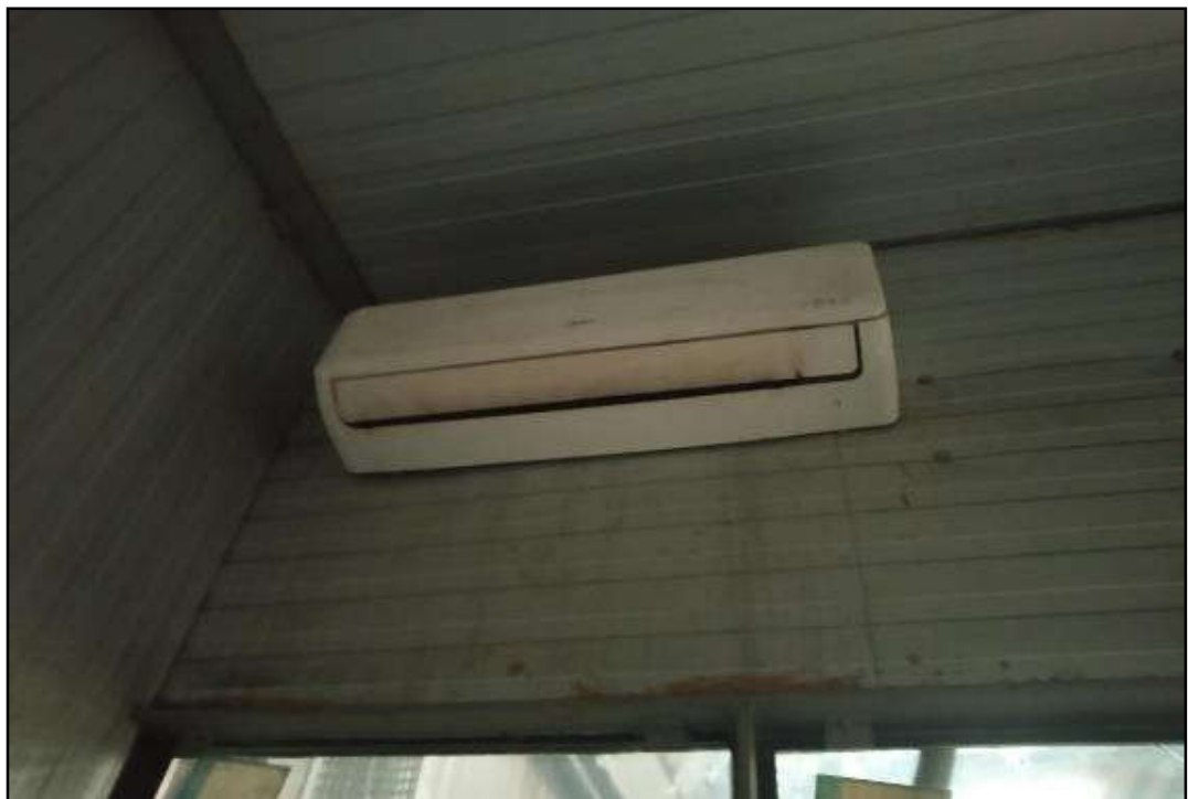
ITEM 2,021 - VISTA DO AR CONDICIONADO SPLIT 9000 BTU MIDEA
