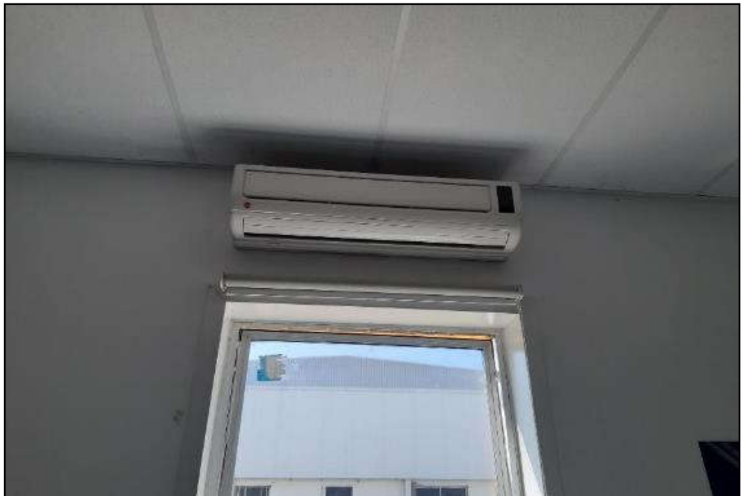
ITEM 2,101 - VISTA DO AR CONDICIONADO SPLIT 12.000 BTU RHEEM
