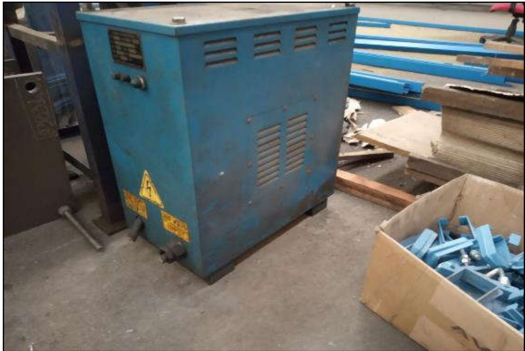
ITEM 1,067 - VISTA DO TRANSFORMADOR
