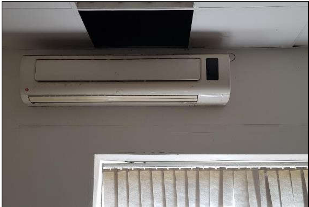
ITEM 2,181 - VISTA DO AR CONDICIONADO SPLIT 12.000 BTU RHEEM
