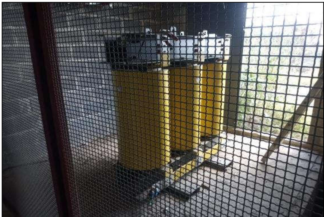
ITEM 1,078 - VISTA DO TRANSFORMADOR TRIFASICO IBPOXI
