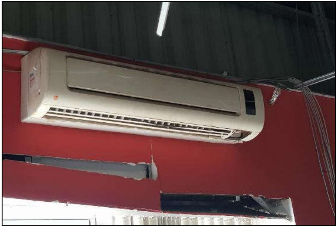
ITEM 2,176 - VISTA DO AR CONDICIONADO SPLIT 12.000 BTU RHEEM
