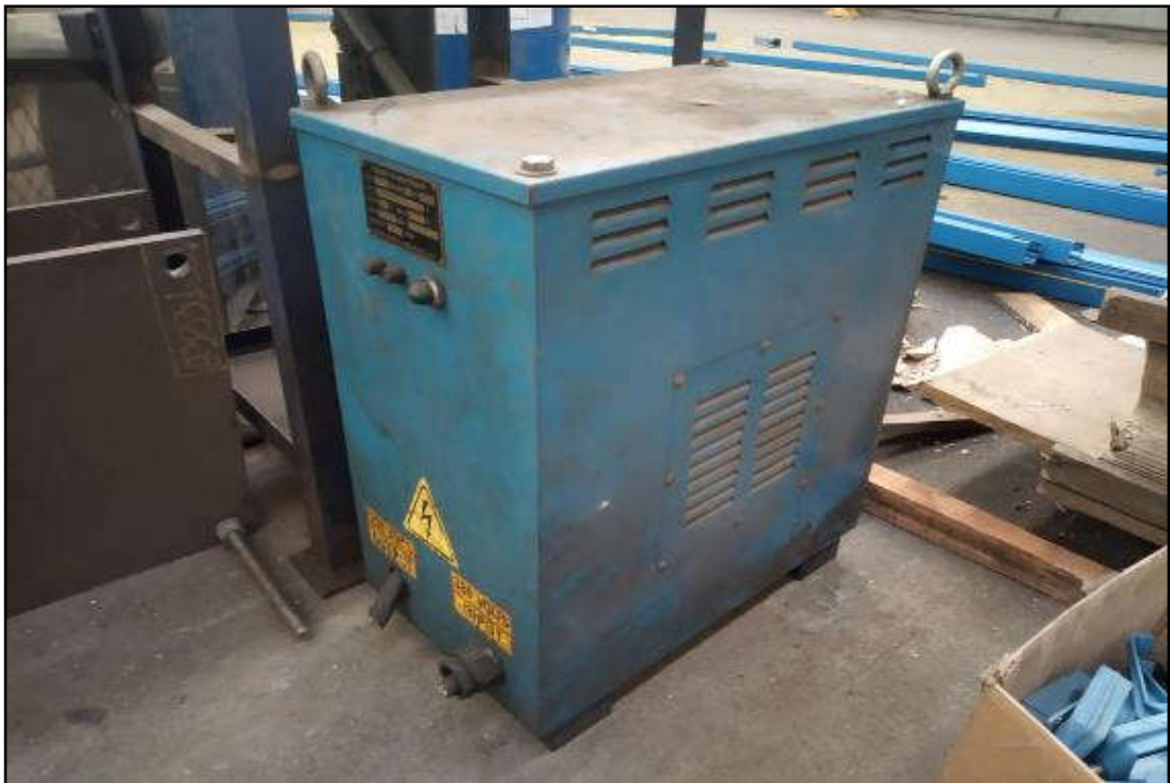
ITEM 1,067 - VISTA DO TRANSFORMADOR
