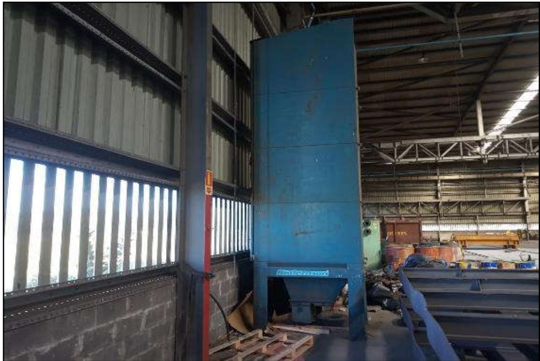
ITEM 1,063 - VISTA DO COLETOR DE FUMO METÁLICO NEDERMAN
