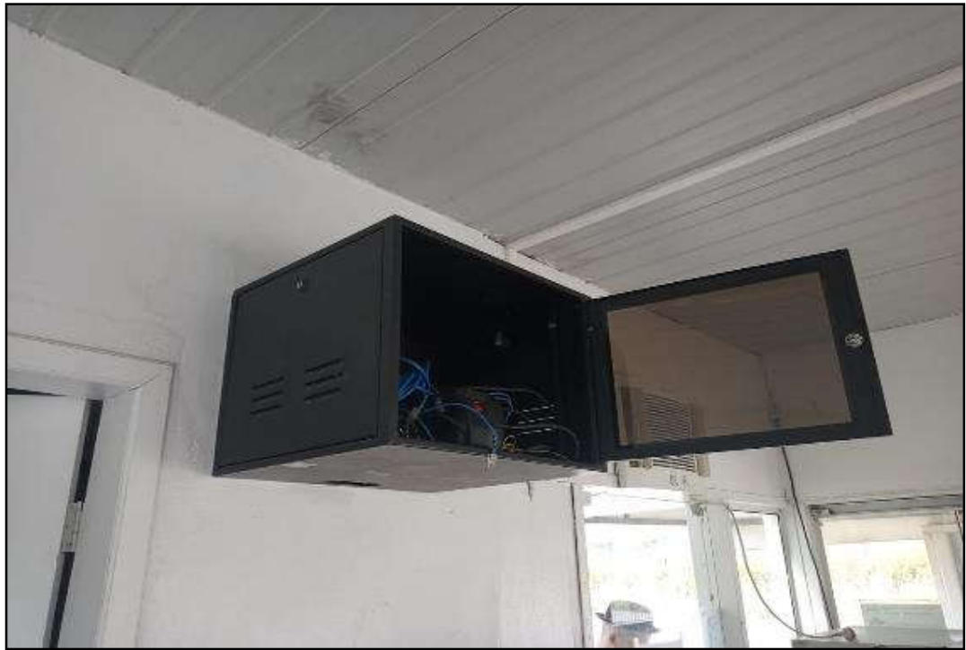
ITEM 3,017 - VISTA DO RACK
