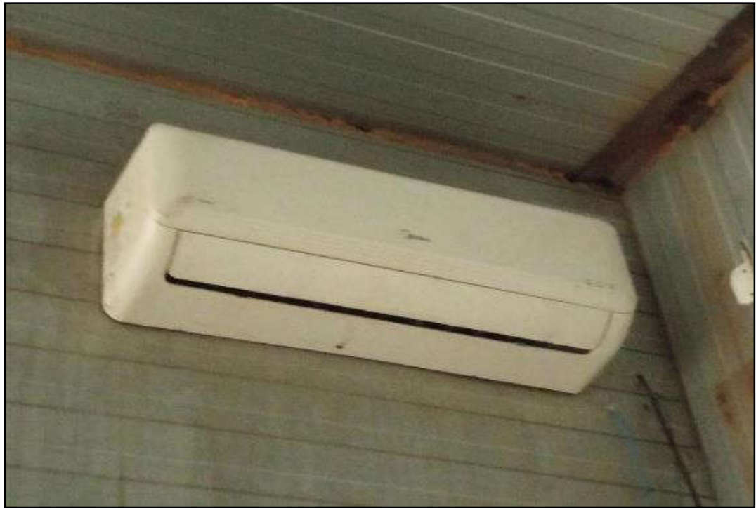
ITEM 2,015 - VISTA DO AR CONDICIONADO SPLIT 9000 BTU MIDEA
