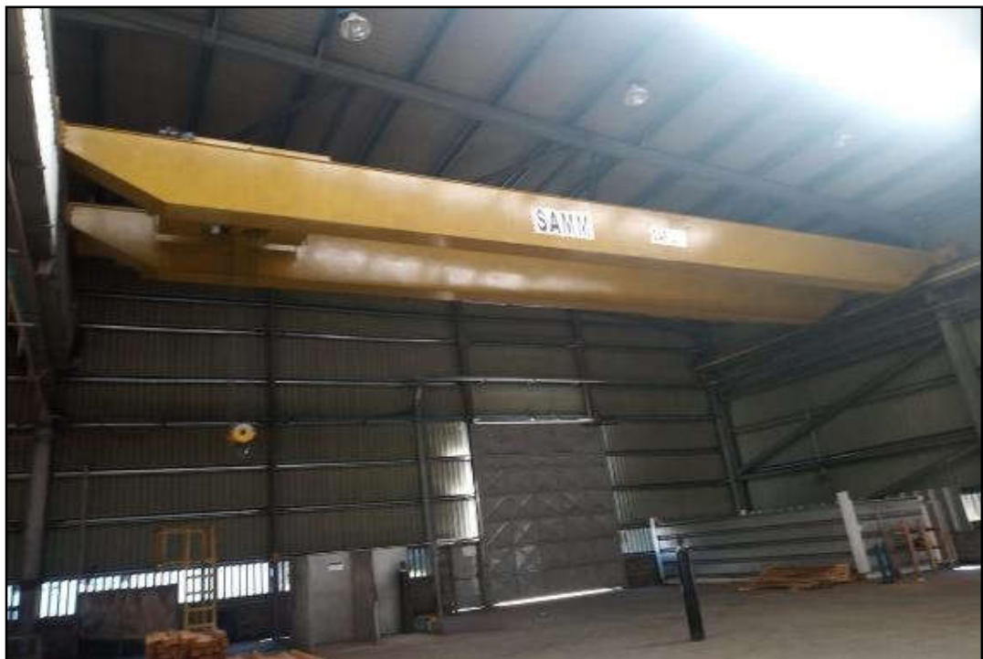
ITEM 1,058 - VISTA DA PONTE ROLANTE 25T SAMM
