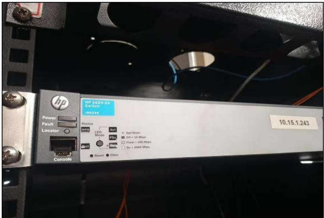
ITEM 3,003 - VISTA DA PLACA DE IDENTIFICAÇÃO DO SWITCH HP HP2620-24
