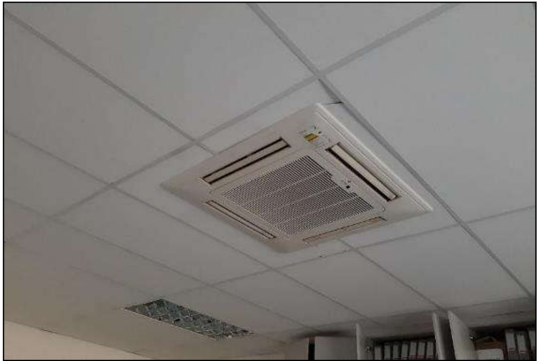
ITEM 2,130 - VISTA DO AR CONDICIONADO SPLIT CASSETE 38.000 BTU RHEEM
