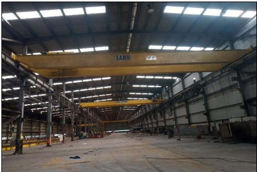
ITEM 1,056 - VISTA DA PONTE ROLANTE 25T SAMM
