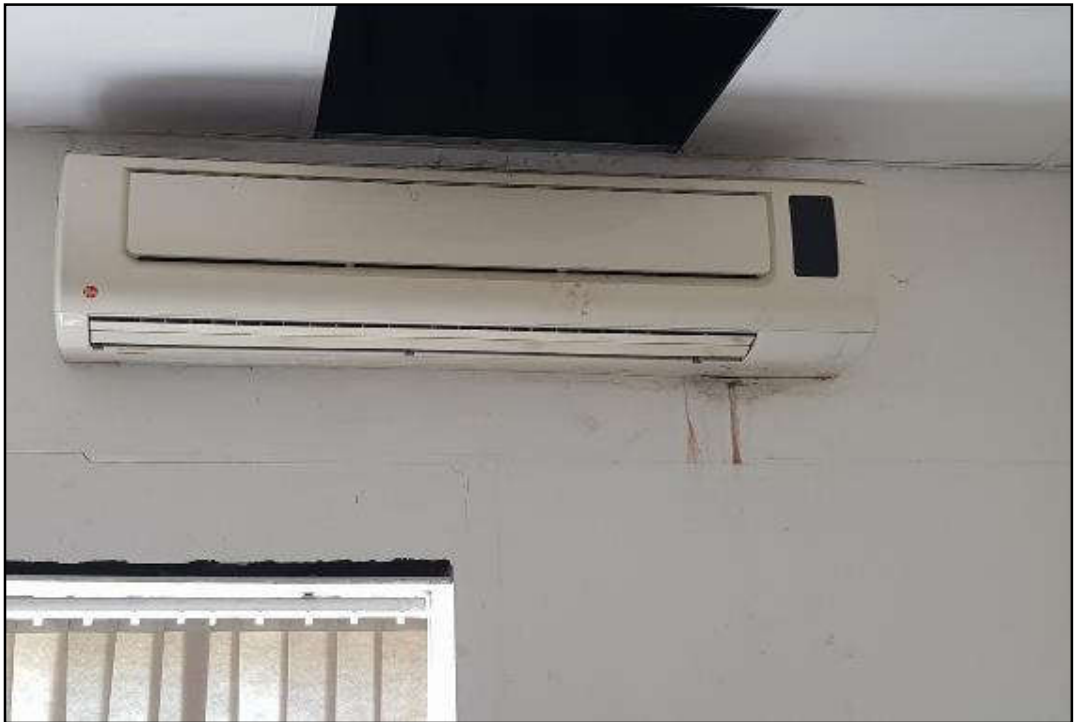
ITEM 2,182 - VISTA DO AR CONDICIONADO SPLIT 12.000 BTU RHEEM
