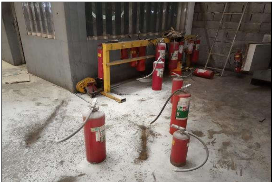
ITEM 4,002 - VISTA DO SUPORTE COM 16 EXTINTORES
