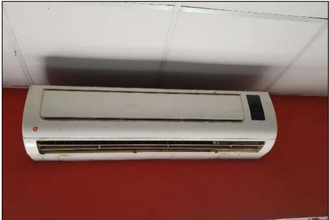
ITEM 2,174 - VISTA DO AR CONDICIONADO SPLIT 12.000 BTU RHEEM
