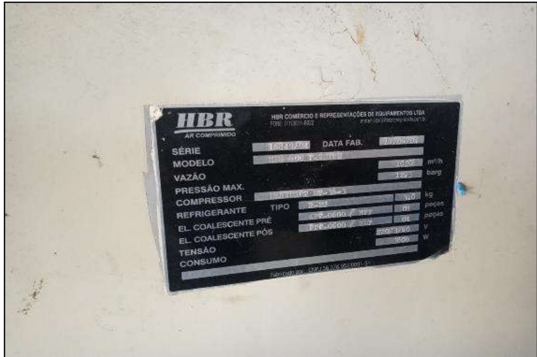
ITEM 1,070 - VISTA DA PLACA DE IDENTIFICAÇÃO DO AR COMPRIMIDO HBR HBR 600 PREMIUM
