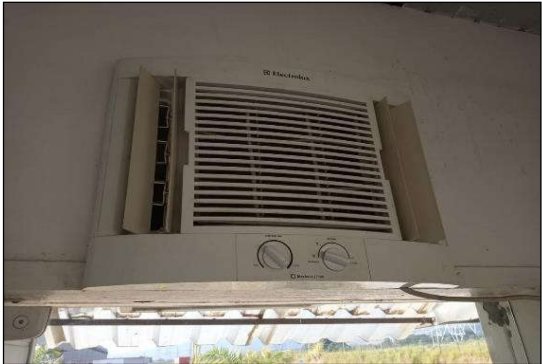
ITEM 2,200 - VISTA DO AR CONDICIONADO ELECTROLUX MAXIMUS 7500
