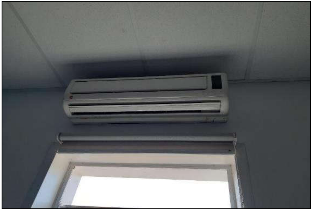
ITEM 2,088 - VISTA DO AR CONDICIONADO SPLIT 12.000 BTU RHEEM
