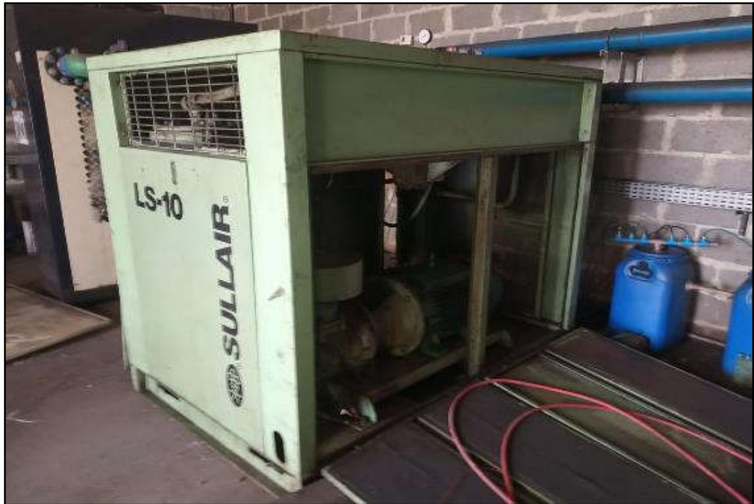
ITEM 1,071 - VISTA DO COMPRESSOR SULLAIR SAN LUIS S.A. 1050 LACAC
