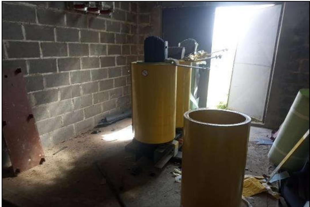
ITEM 1,077 - VISTA DO TRANSFORMADOR TRIFASICO IBPOXI
