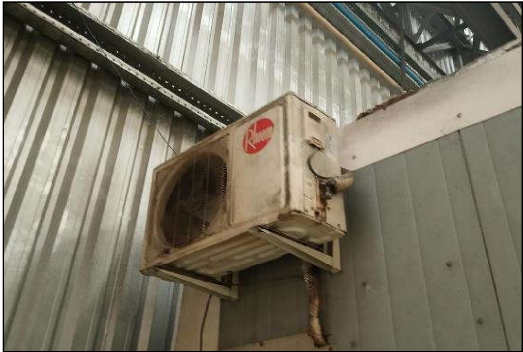
ITEM 2,006 - VISTA DO AR CONDICIONADO SPLIT 12.000 BTU RHEEM
