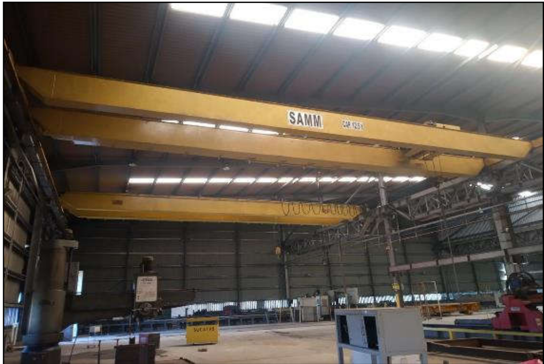
ITEM 1,053 - VISTA DA PONTE ROLANTE 12,5T SAMM
