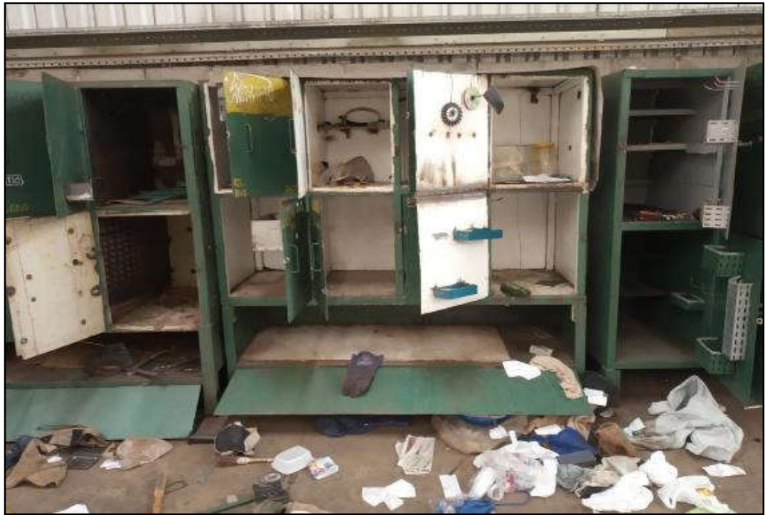
ITEM 5,060 - VISTA DO ARMÁRIO DE FERRO 9 PORTAS
