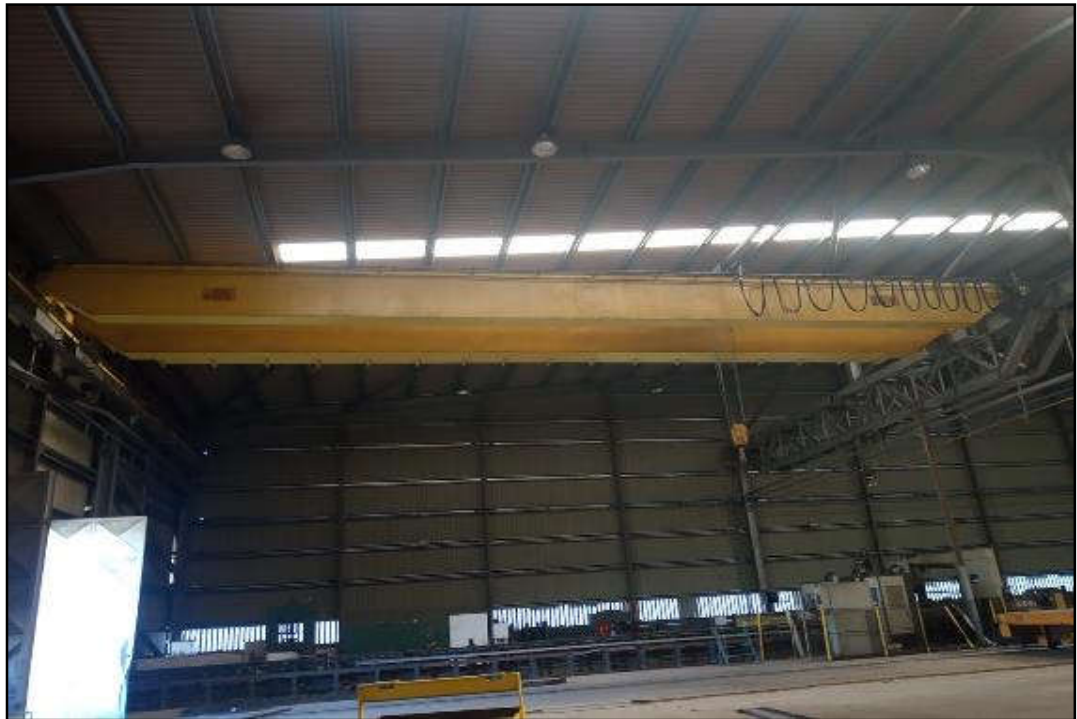
ITEM 1,052 - VISTA DA PONTE ROLANTE 25T
