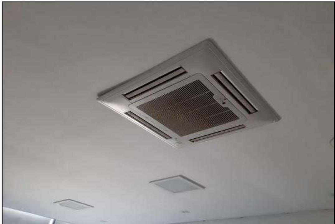
ITEM 2,145 - VISTA DO AR CONDICIONADO SPLIT CASSETE 38.000 BTU RHEEM
