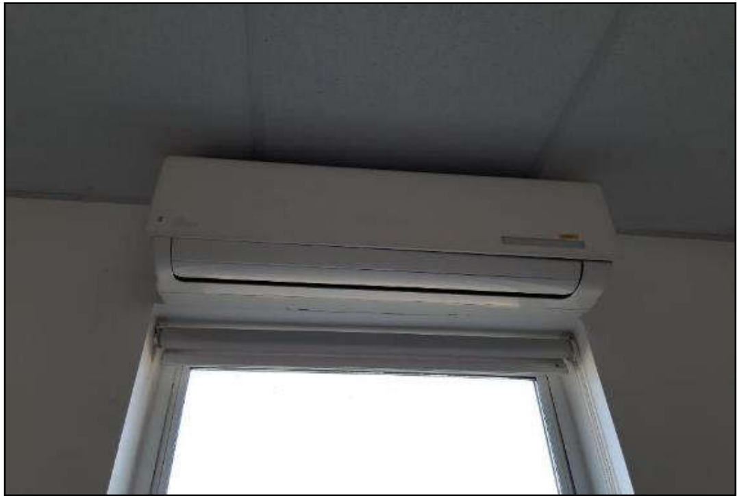
ITEM 2,154 - VISTA DO AR CONDICIONADO SPLIT 9000 BTU MIDEA SPLIT
