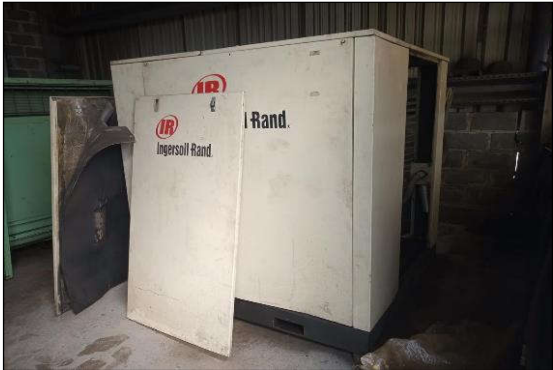
ITEM 1,073 - VISTA DO COMPRESSOR INGERSOLL RAND XF75 AC
