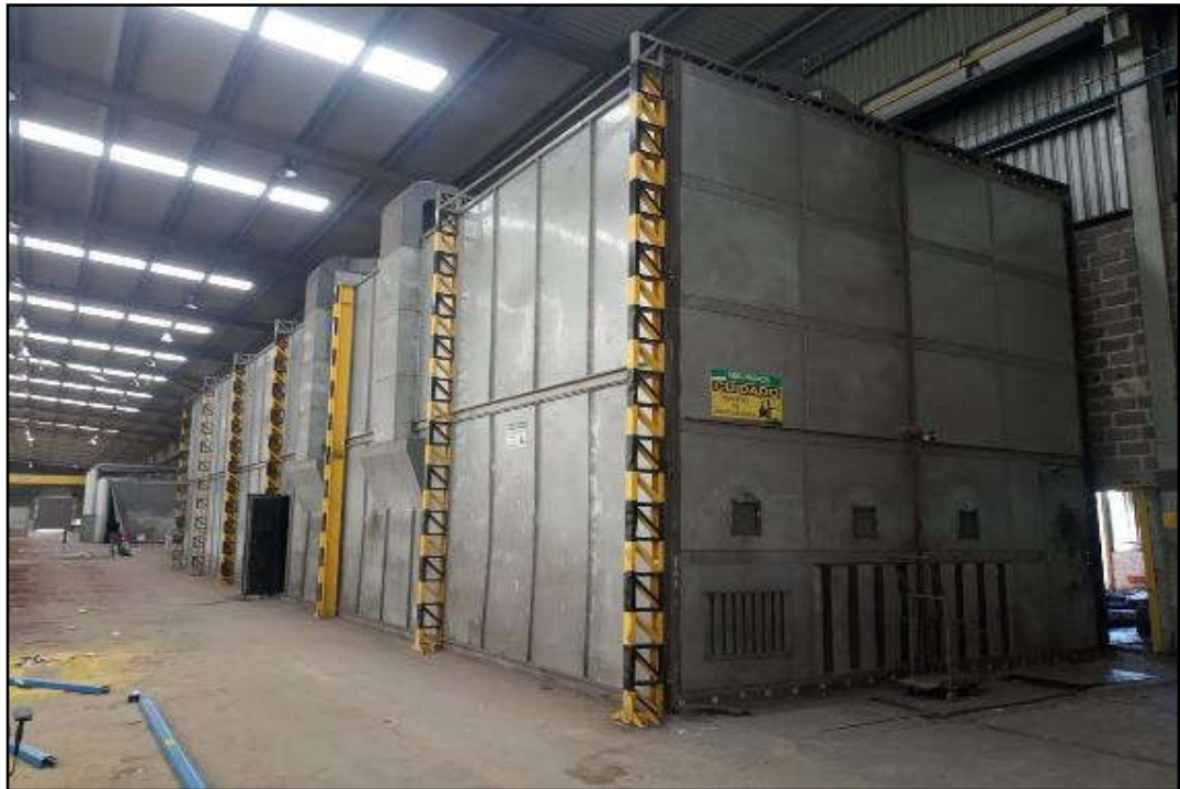
ITEM 1,039 - VISTA DA CABINE DE PINTURA
