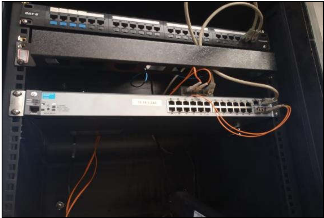
ITEM 3,003 - VISTA DO SWITCH HP HP2620-24
