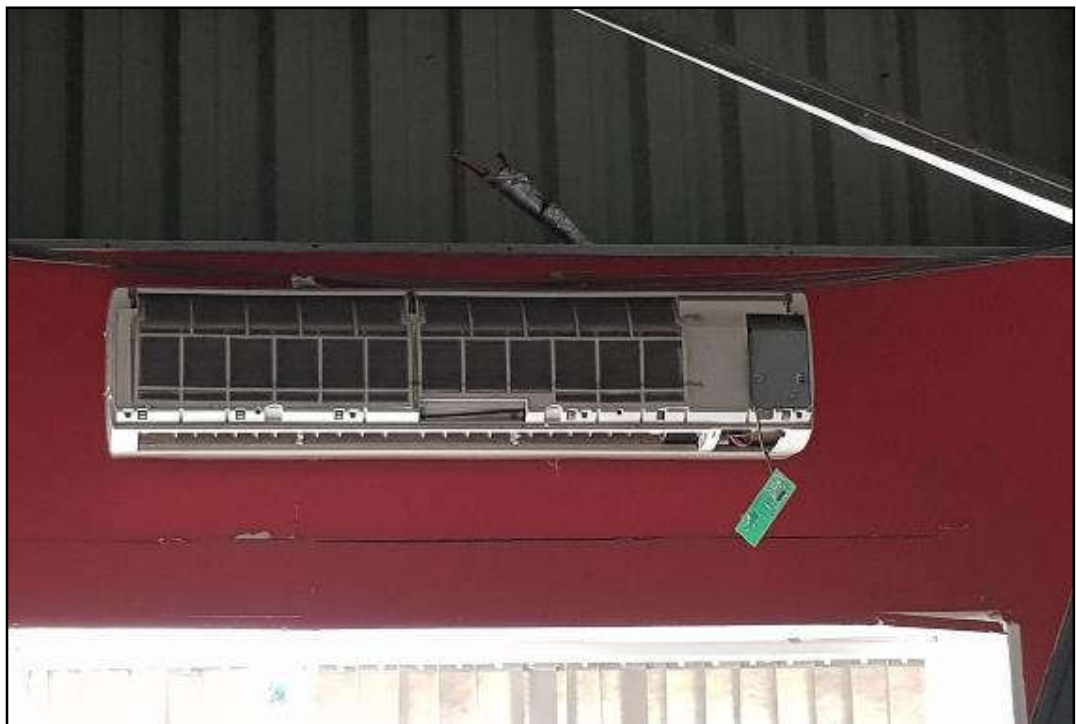
ITEM 5,086 - VISTA DO AR CONDICIONADO SPLIT 12.000 BTU RHEEM
