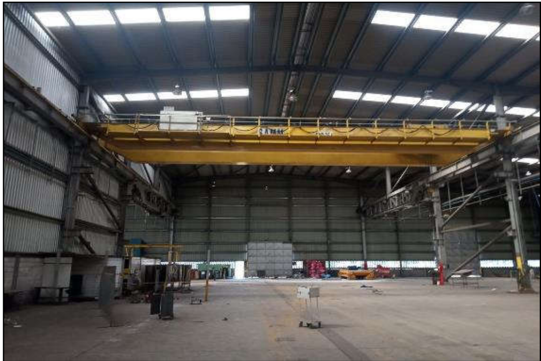
ITEM 1,056 - VISTA DA PONTE ROLANTE 25T SAMM
