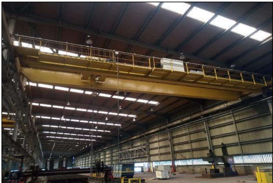
ITEM 1,053 - VISTA DA PONTE ROLANTE 12,5T SAMM
