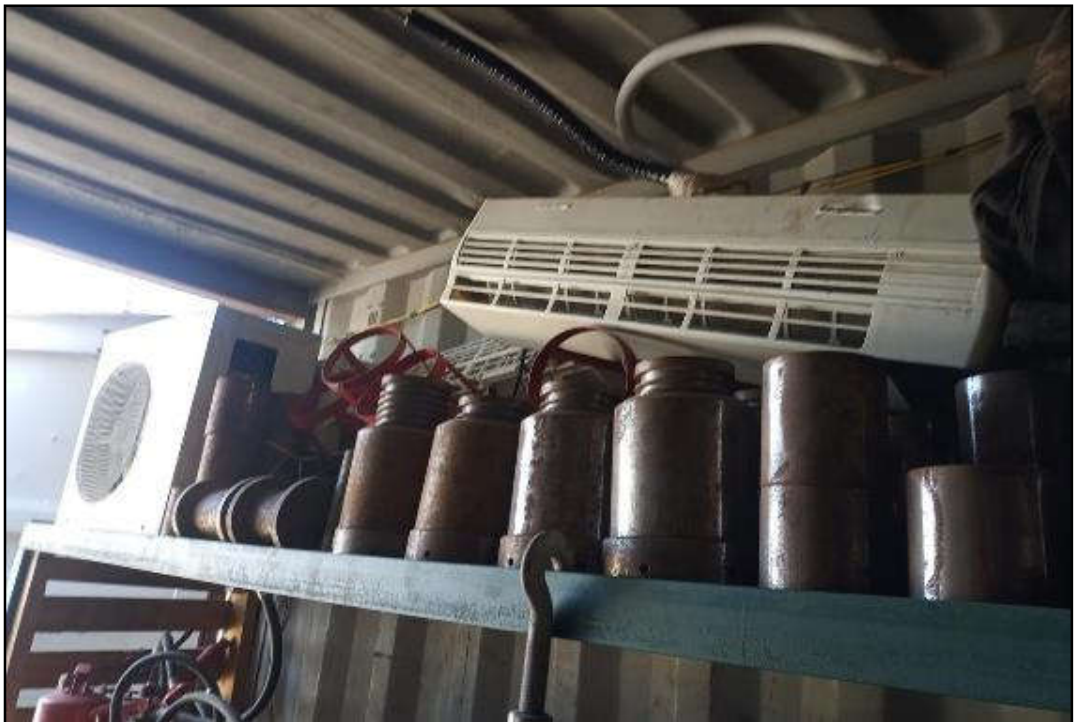
ITEM 5,098 - VISTA DO AR CONDICIONADO
