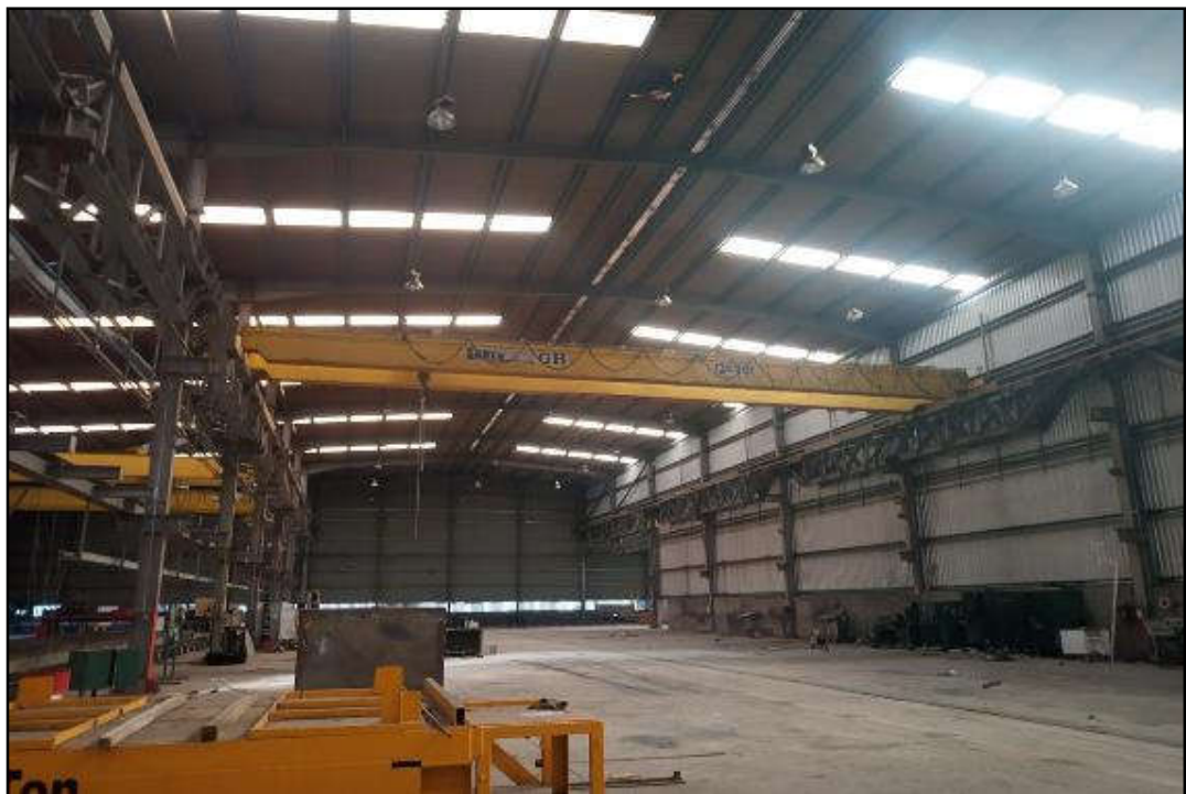
ITEM 1,054 - VISTA DA PONTE ROLANTE 10T INTERTECH GH
