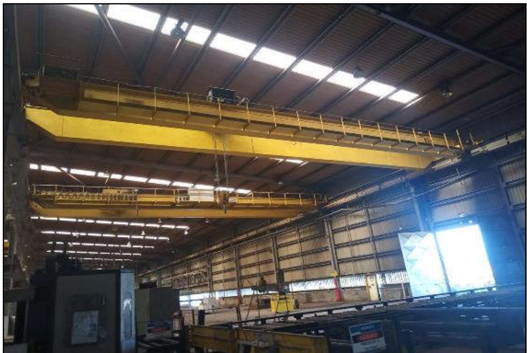
ITEM 1,052 - VISTA DA PONTE ROLANTE 25T
