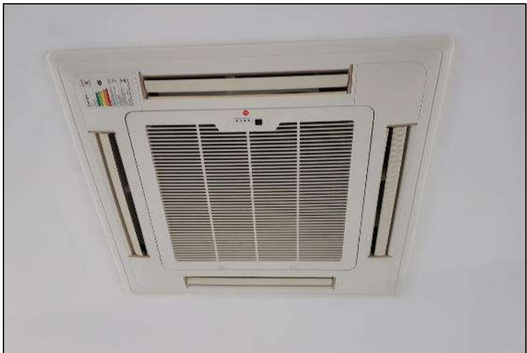
ITEM 2,054 - VISTA DO AR CONDICIONADO SPLIT CASSETE 38.000 BTU RHEEM
