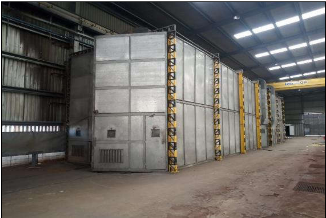
ITEM 1,039 - VISTA DA CABINE DE PINTURA
