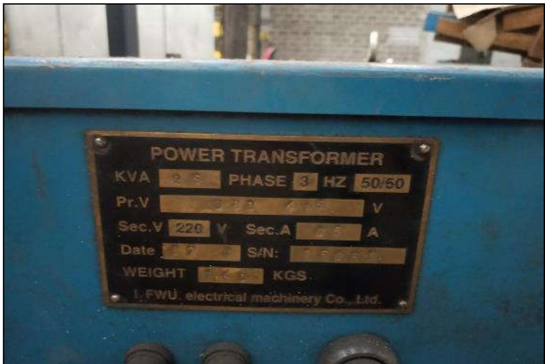
ITEM 1,067 - VISTA DA PLACA DE IDENTIFICAÇÃO DO TRANSFORMADOR
