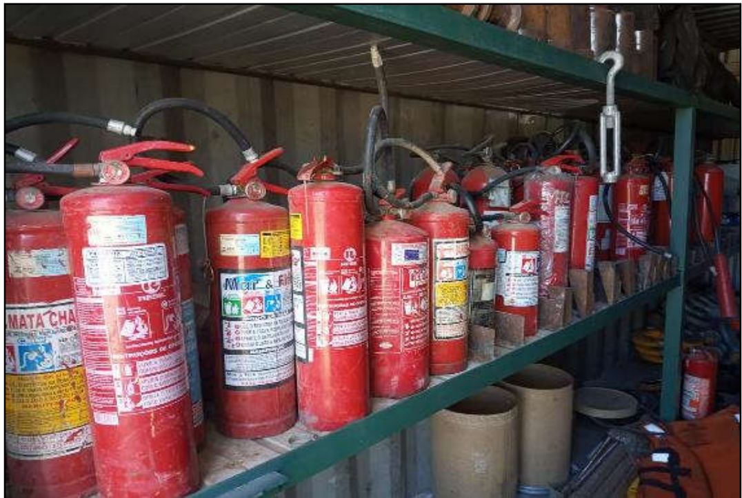
ITEM 4,033 - VISTA DO EXTINTOR
