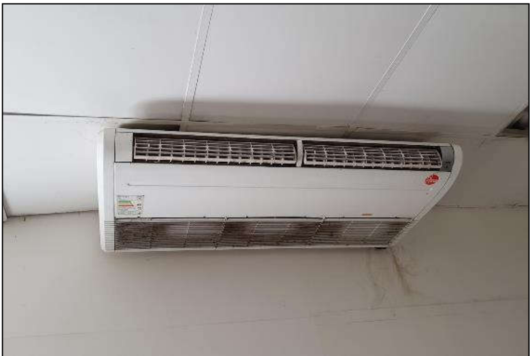
ITEM 2,183 - VISTA DO AR CONDICIONADO SPLIT 36.000 BTU RHEEM
