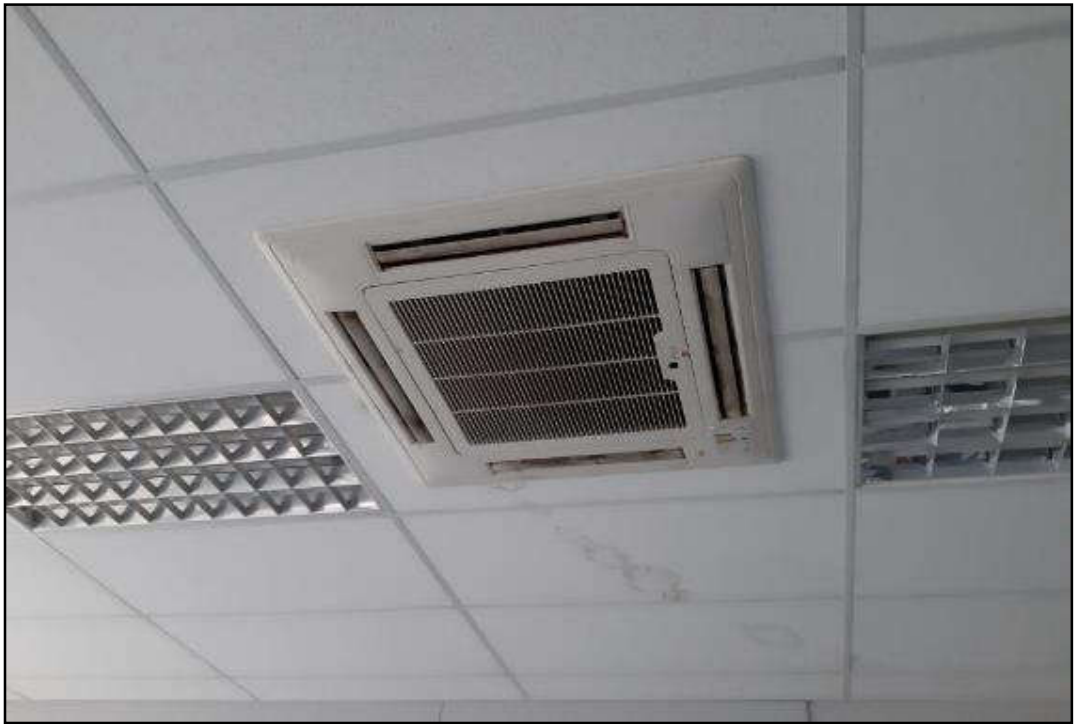
ITEM 2,112 - VISTA DO AR CONDICIONADO SPLIT CASSETE 38.000 BTU RHEEM
