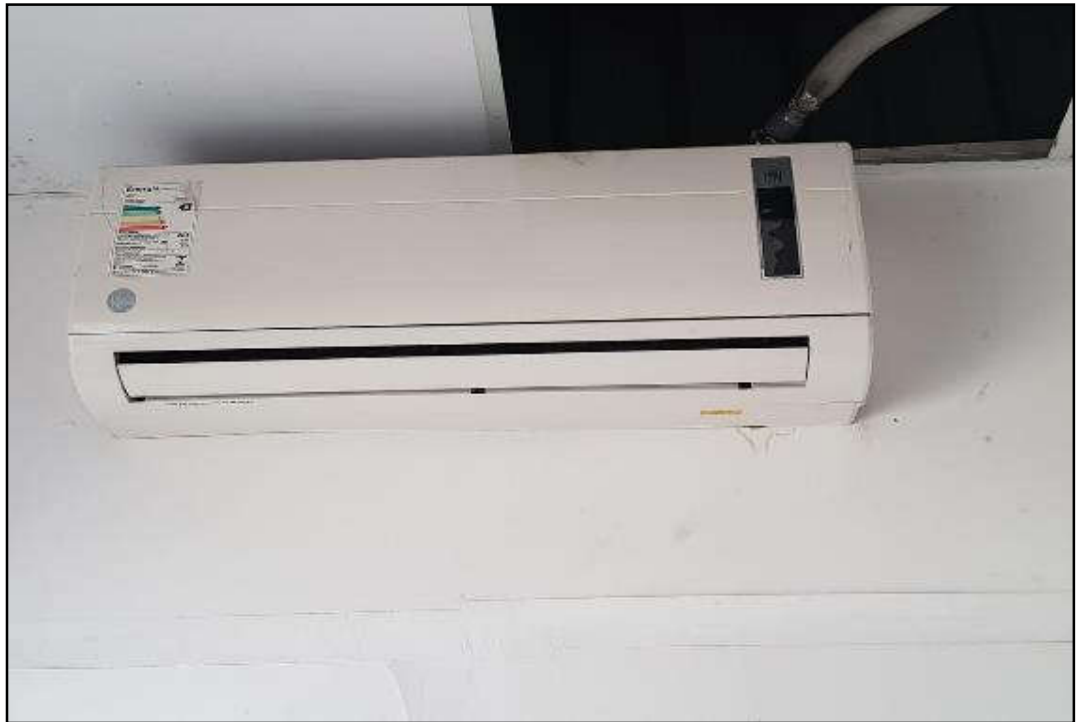
ITEM 2,171 - VISTA DO AR CONDICIONADO SPLIT 12.000 BTU RHEEM
