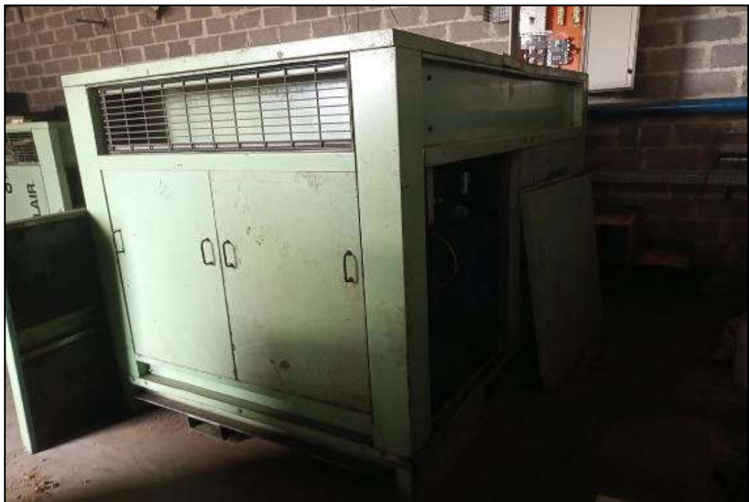
ITEM 1,072 - VISTA DO COMPRESSOR SULLAIR SAN LUIS S.A. 16100 LACAC
