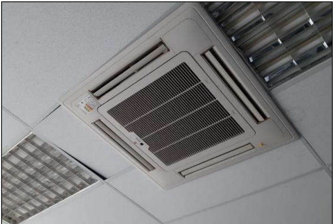
ITEM 2,153 - VISTA DO AR CONDICIONADO SPLIT CASSETE 38.000 BTU RHEEM
