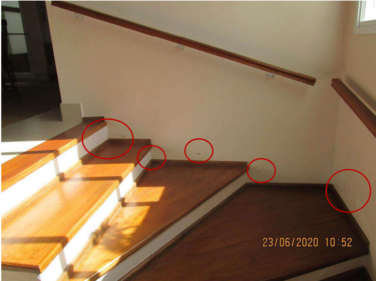
Pontos de Infiltração
