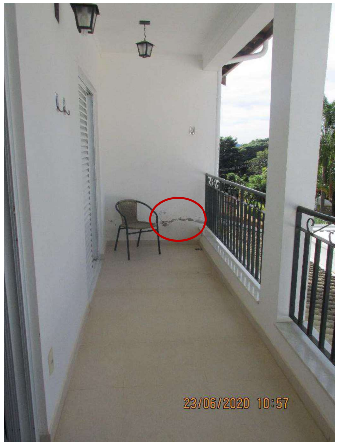
Sacada/Dormitório I + Ponto de Desgaste
