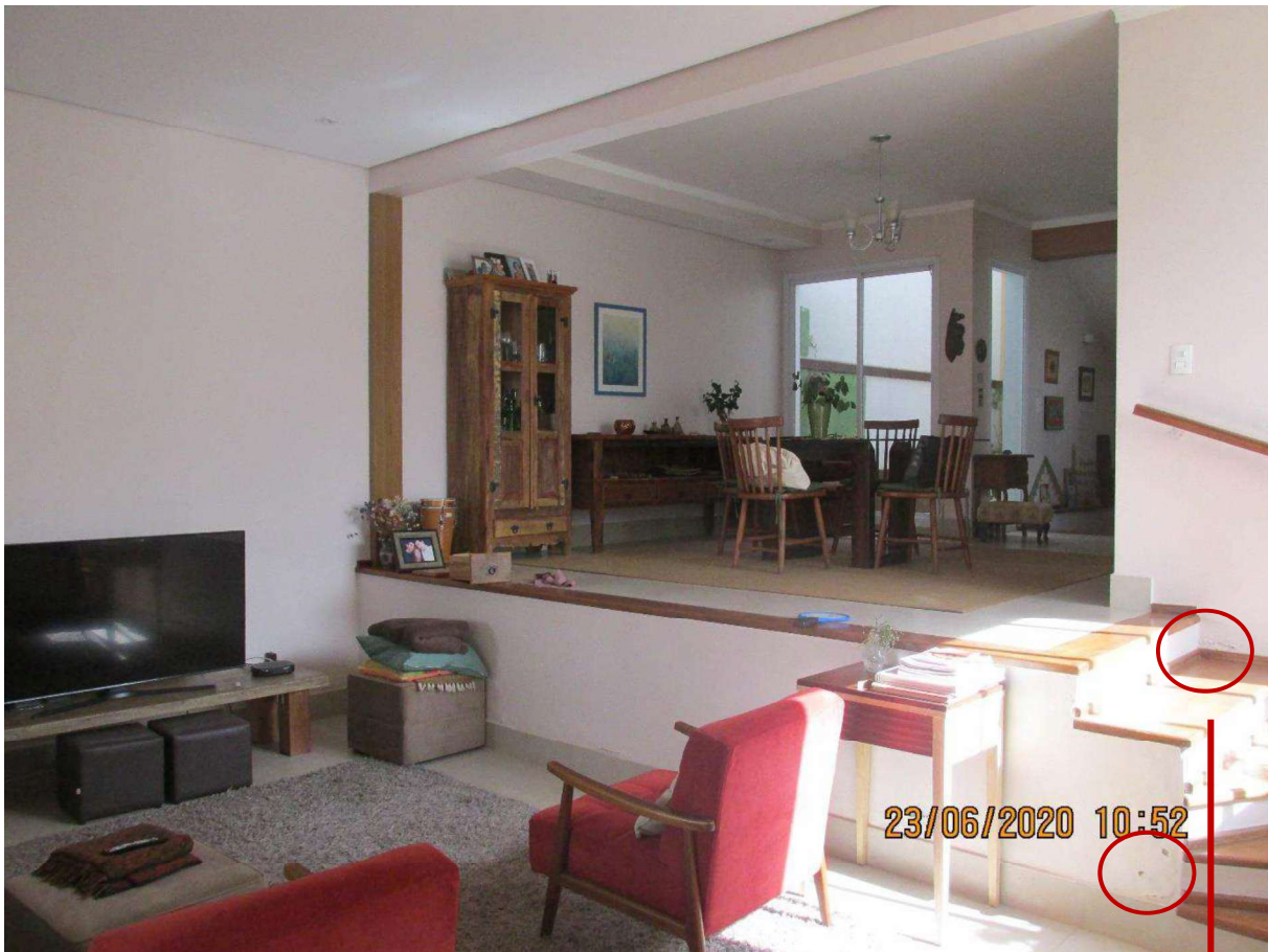
Sala Jantar/Sala de Estar IV + Ponto de Infiltração
