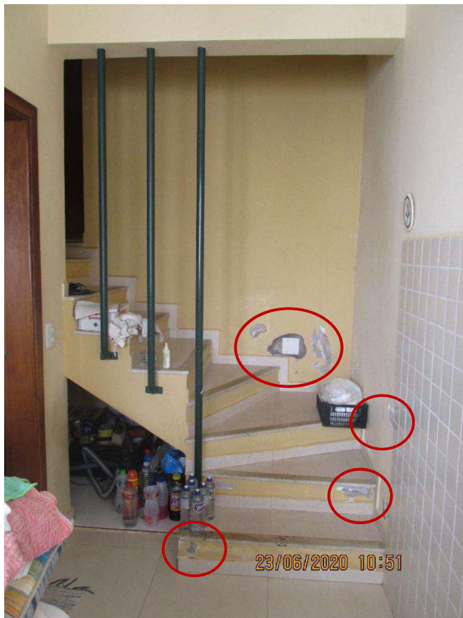
Lavanderia/Saida de Serviço I + Ponto de Infiltração
