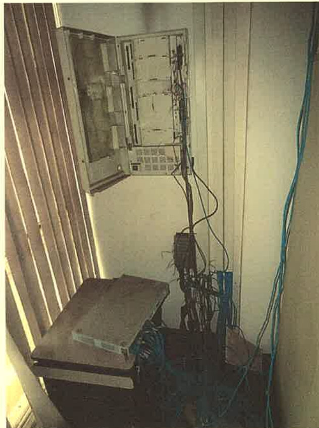
VISTA DO QUADRO DE LUZ.
