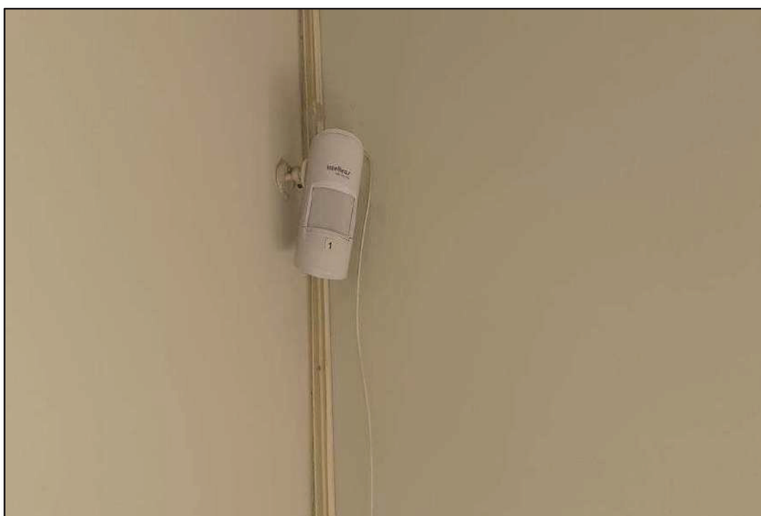
ITEM 1,034 - VISTA DO SENSOR DE PRESENÇA INTELBRAS
