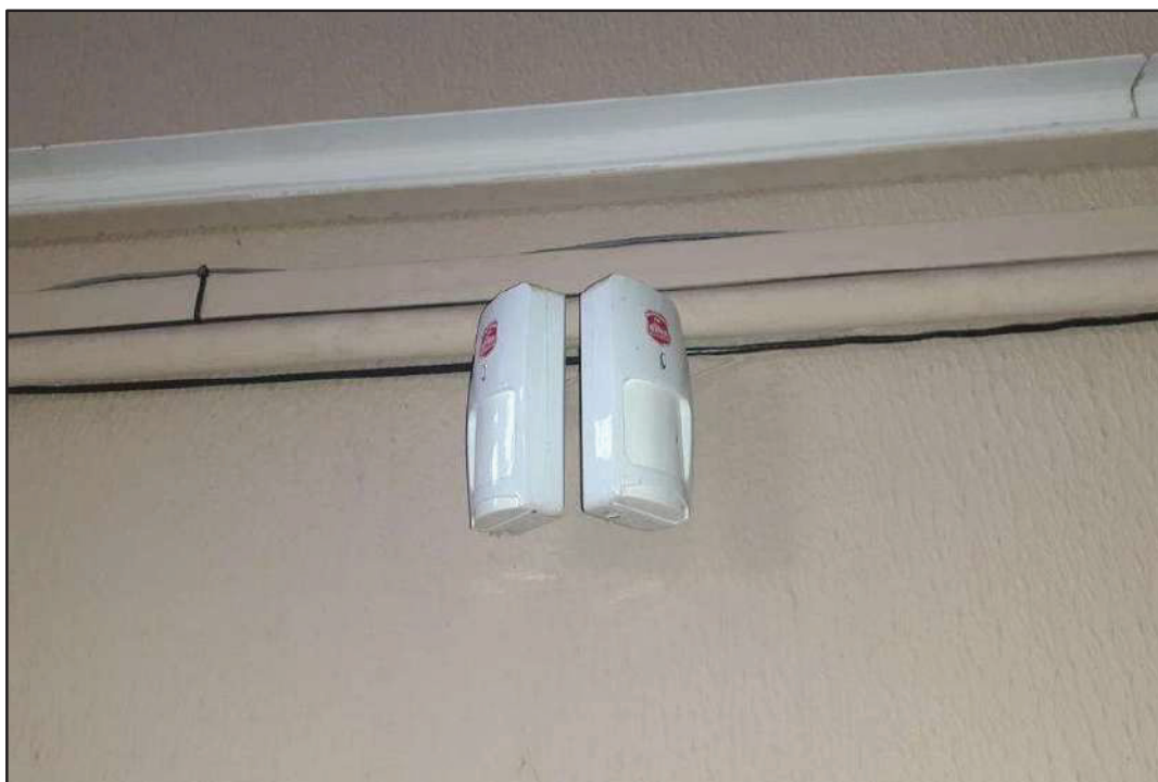
ITEM 1,033 - VISTA DO SENSOR DE PRESENÇA
