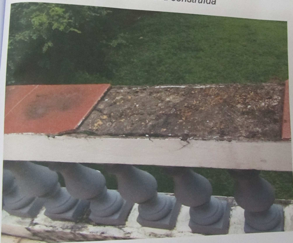
Foto 9: Detalhe da ausência de conservação adequada da casa construída
