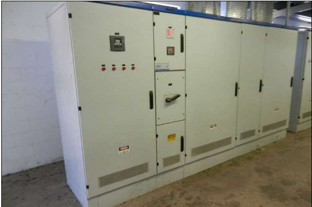
ITEM 1,127 - VISTA DO QUADRO DE COMANDO MARCA: CSW ENERGY (PGBT-01) FABRICA COM 5 MODULOS, E DEMAIS COMPPONENTES
