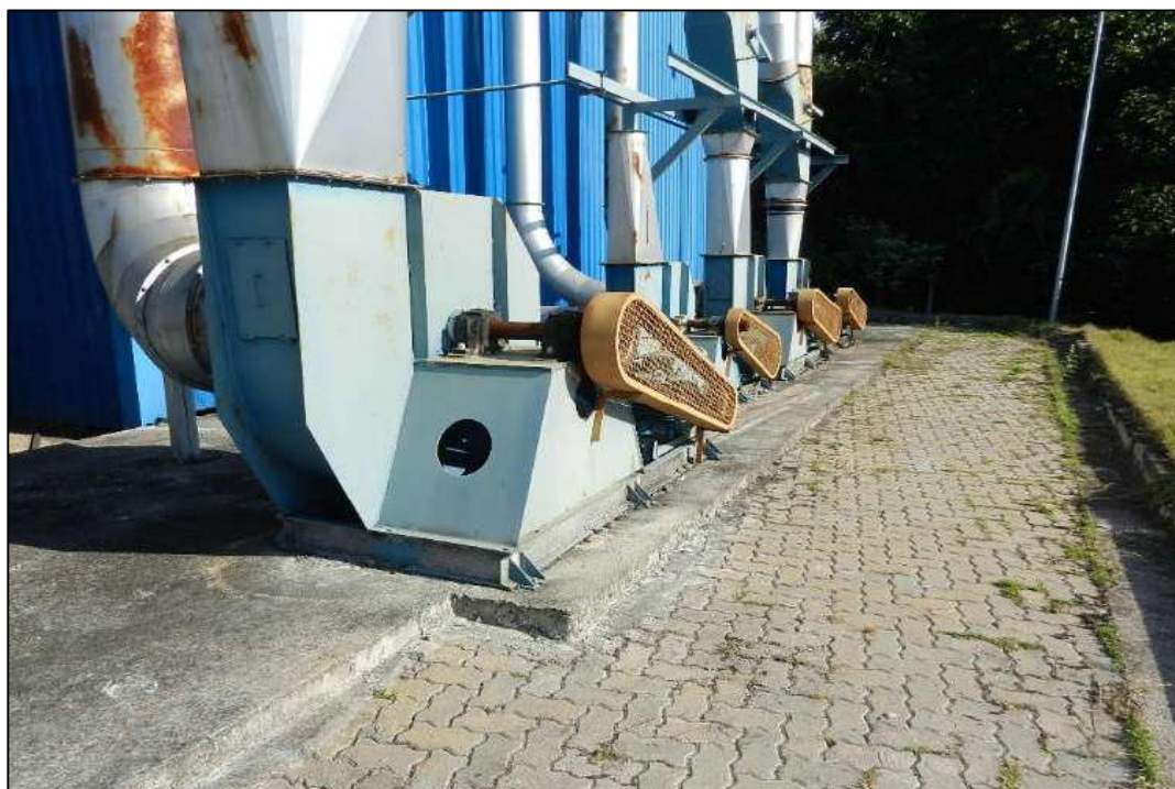
ITEM 1,146 - VISTA DA LINHA DE Prensagem de Aparas de Papel compreendendo os itens ( 4 VENTILADORES CENTRIFUGOS)
