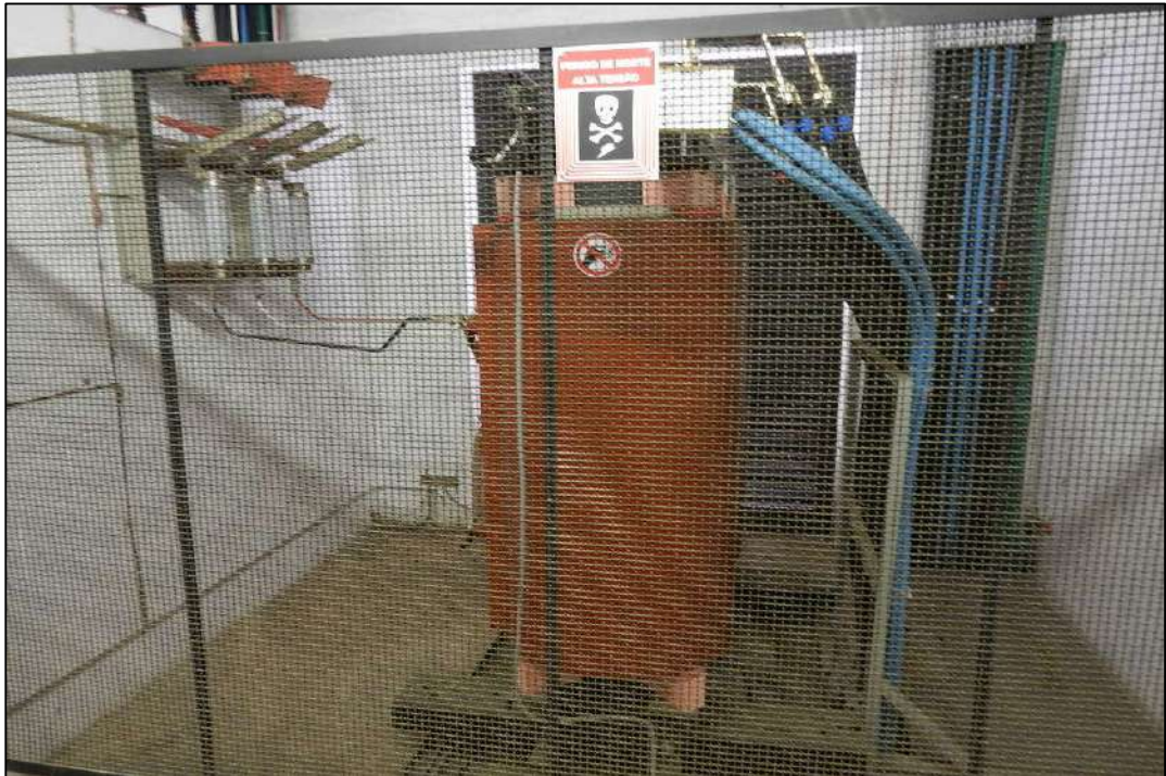
ITEM 1,153 - VISTA DA CABINE SECUNDARIA COMPREENDENDO: 1 CHAVE SECCIONADORA, 1 TRANSFORMADOR A SECO GEAFOL CAP: 2.000 KVA, 13,8/380/220V, 1 CHAVE SECCIONADORA, 1 TRANSFORMADOR MARCA: TRAF0 TIPO: TEC-1500/1.5/1.2 CAP: 1.500 KVA, 13,8/460/265,6 KV
