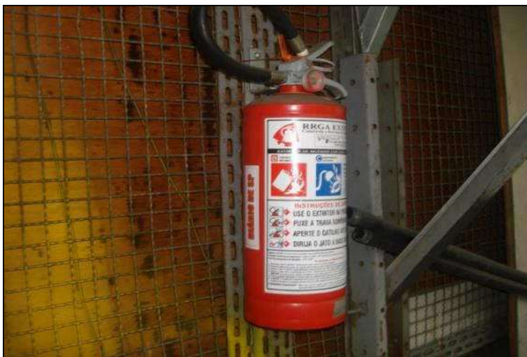
ITEM 1,865 - VISTA DO EXTINTOR
