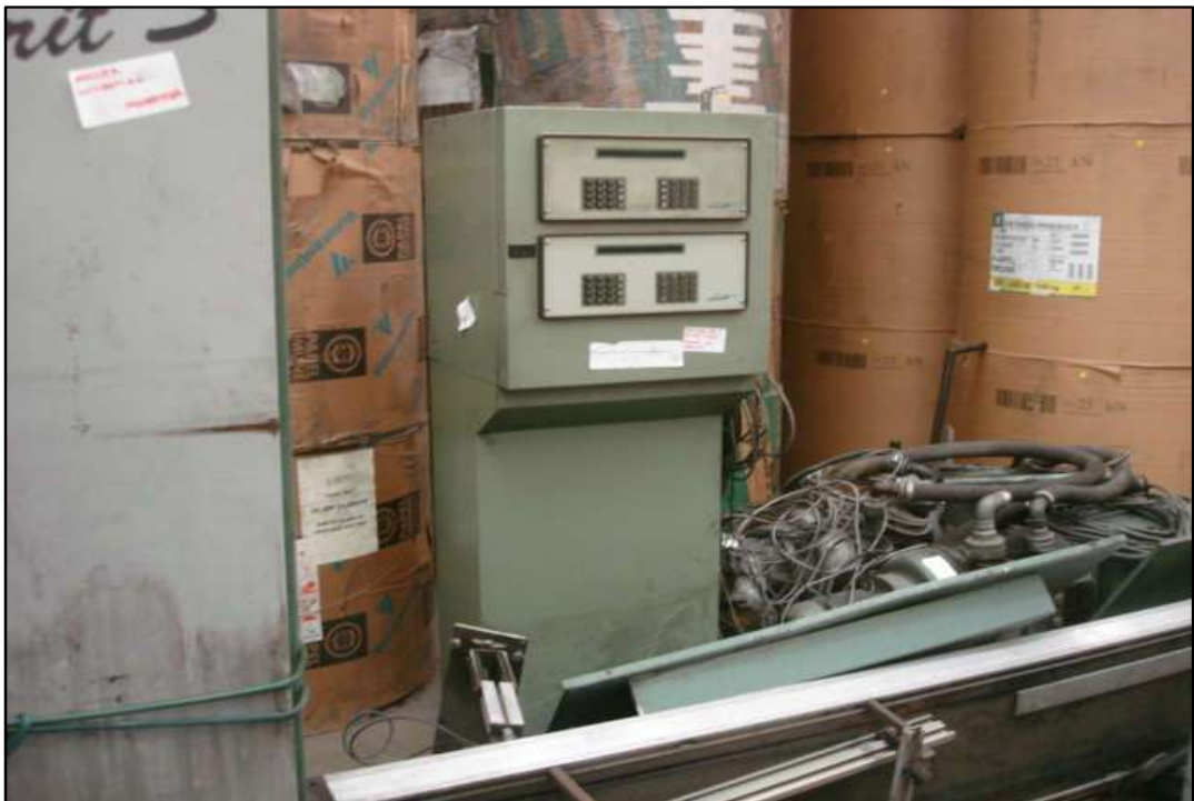
ITEM 1,040 - VISTA DOS PAINÉIS DE COMANDO
