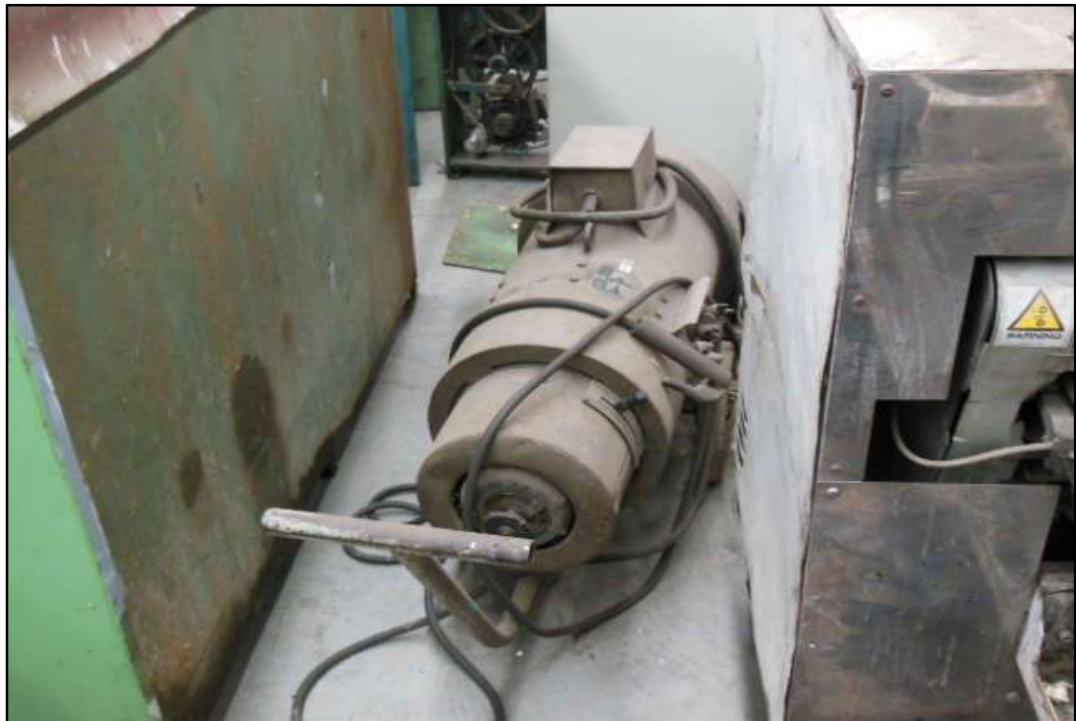
ITEM 1,079 - VISTA DO GERADOR DE SOLDA MARCA: BAMBOZZI MODELO: TN-6B-56 CAP: 375 A Nº 102223
