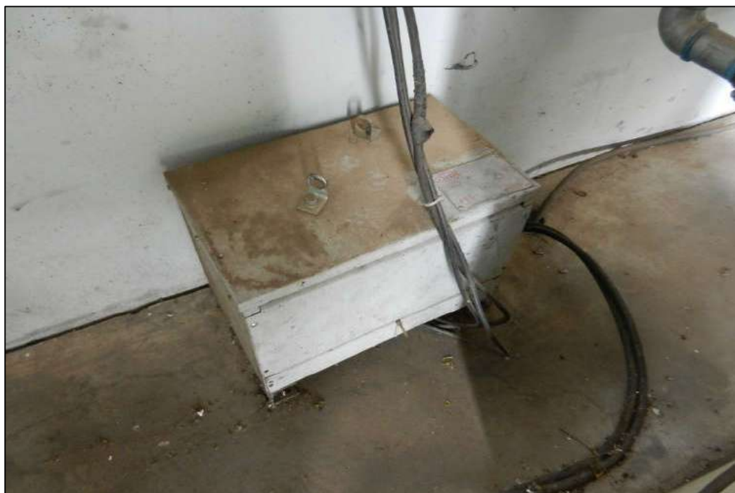
ITEM 1,117 - VISTA DO TRANSFORMADOR REG CONTINUO A SECO MARCA: GHR Nº 65.584 CAP: 30 KVA
