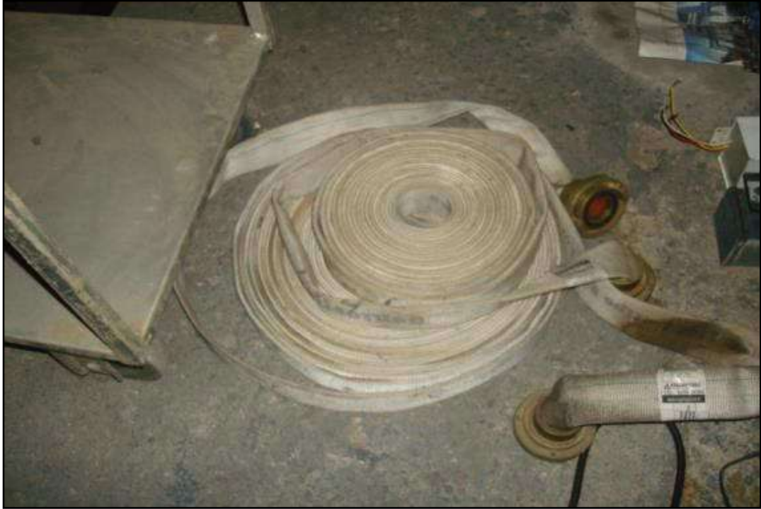
ITEM 1,849 - VISTA DA MANGUEIRA PARA HIDRANTE
