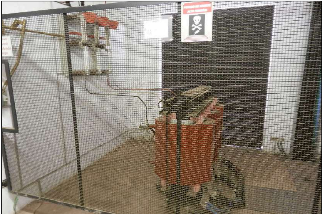
ITEM 1,153 - VISTA DA CABINE SECUNDARIA COMPREENDENDO: 1 CHAVE SECCIONADORA, 1 TRANSFORMADOR A SECO GEAPOL MARCA: SIEMENS TIPO: GEAFOL CAP: 500 KVA, 13,8/220/127V
