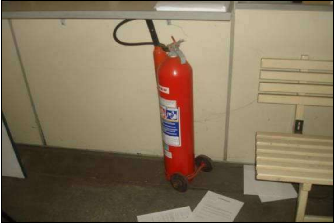
ITEM 1,501 - VISTA DO EXTINTOR DE INCÊNDIO
