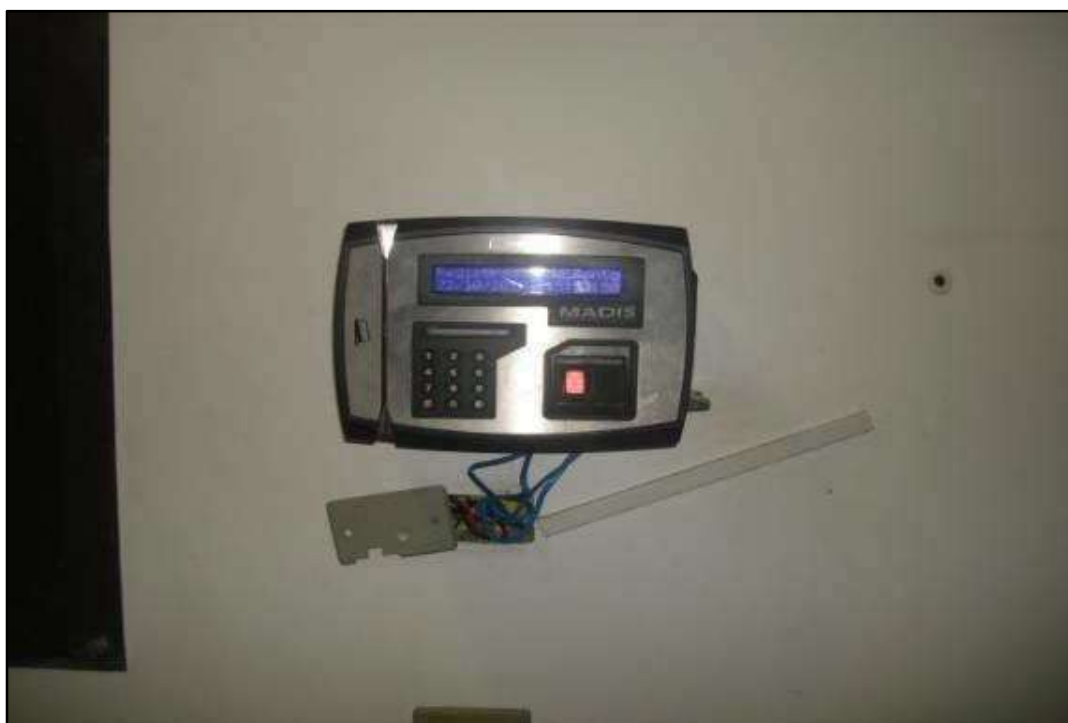
ITEM 1,197 - VISTA DO REGISTRADOR DE PONTO MADIS
