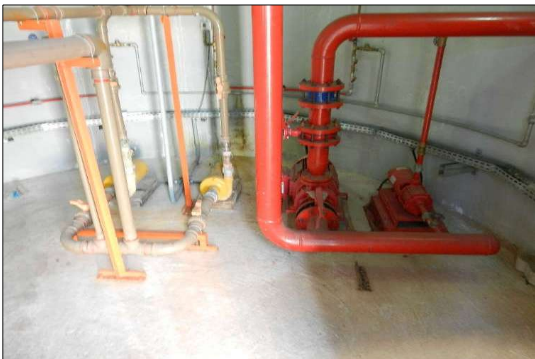
ITEM 1,132 - VISTA DO SISTEMA DE INCENDIO MARCA: GERMEK COMPREENDENDO: BOMBA CENTRIFUGA PARA INCENDIO MARCA: THEBE MODELO: RL20B(F) SERIE: 22.188 COM MOTOR ELETRICO DE 25 CV, BOMBA JOCKEY MARCA: THEBE MODELO: P-11/4 COM MOTOR ELETRICO DE 3 CV
