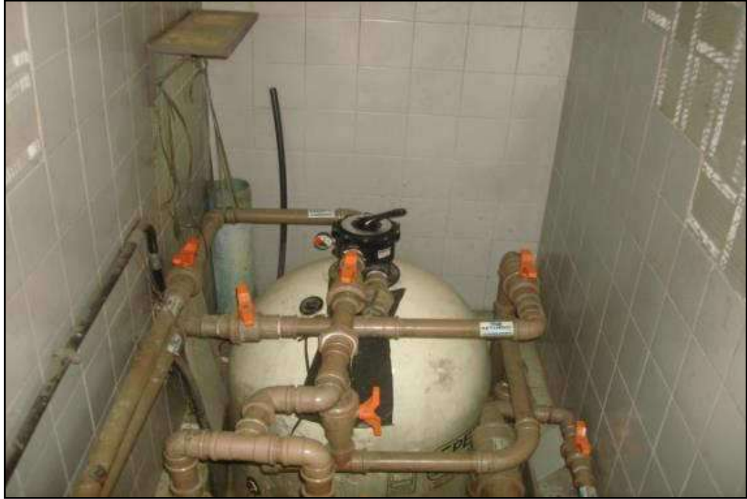
ITEM 1,879 - VISTA DA BOMBA DE PISCINA EPEX
