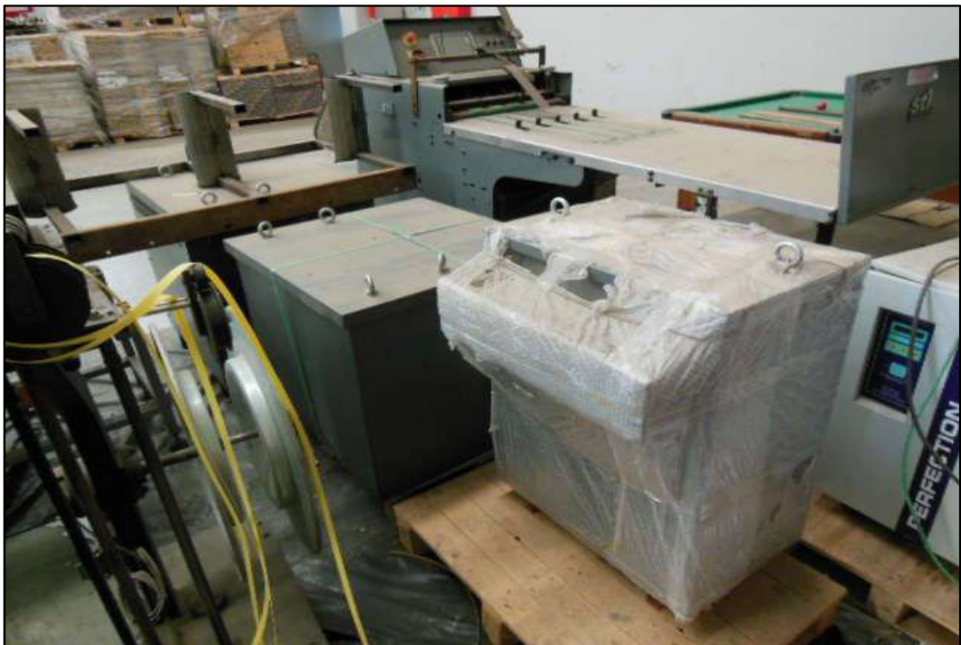
ITEM 1,088 / 1,089 / 1,090 - VISTA DO AUTO TRANSFORMADOR MARCA: FIXOVOLT CAP: 130 KVA
