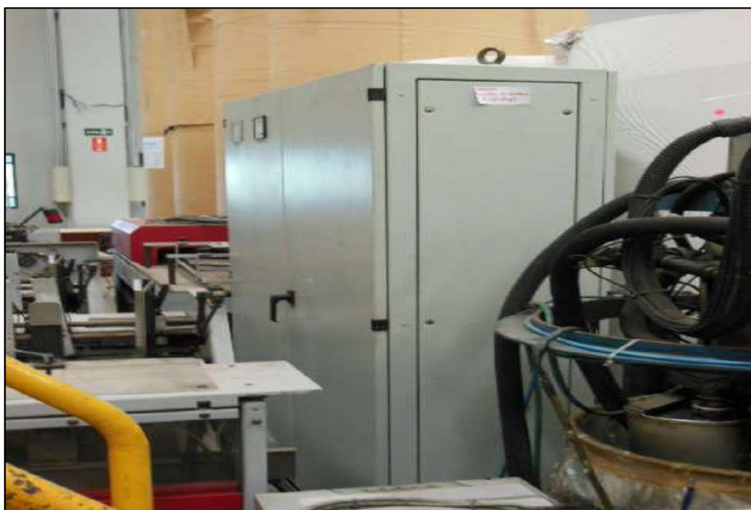
ITEM 1,041 - VISTA DO PAINEL ELÉTRICO
