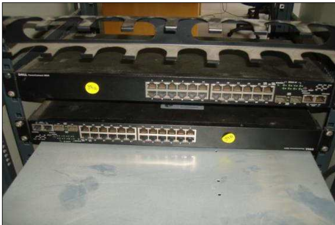
ITEM 0087- VISTA DO SWITCH MARCA: DELL MOD: POWER CONNECT 3524 COM 24 PORTAS
