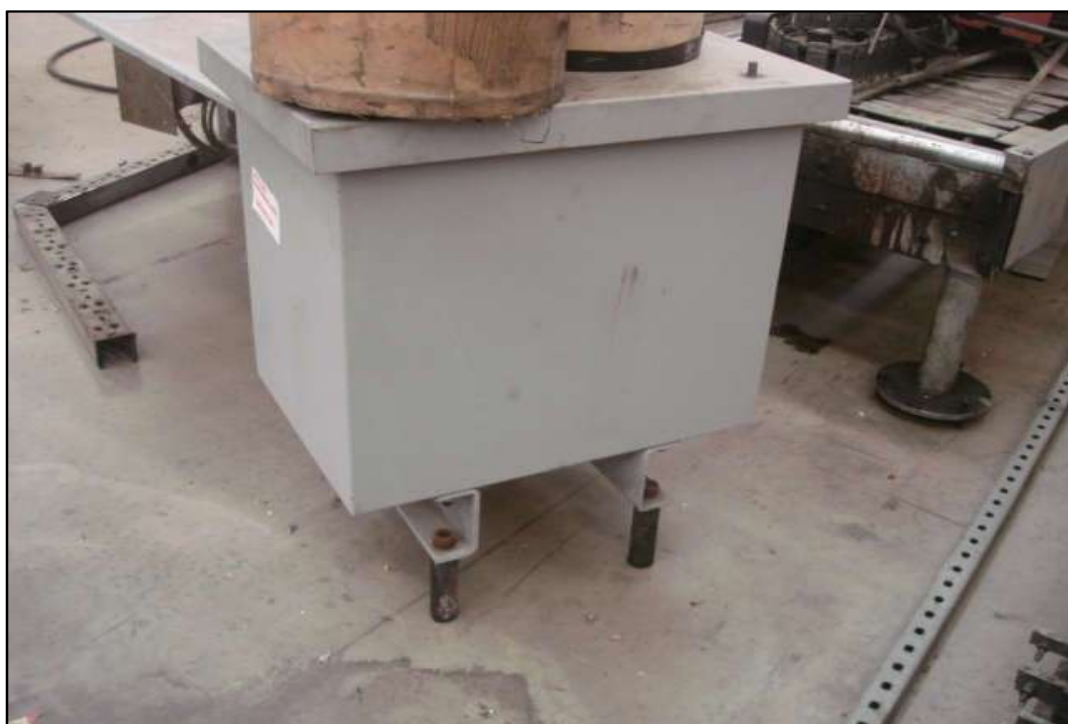
ITEM 1,042 - VISTA DO TRANSFORMADOR
