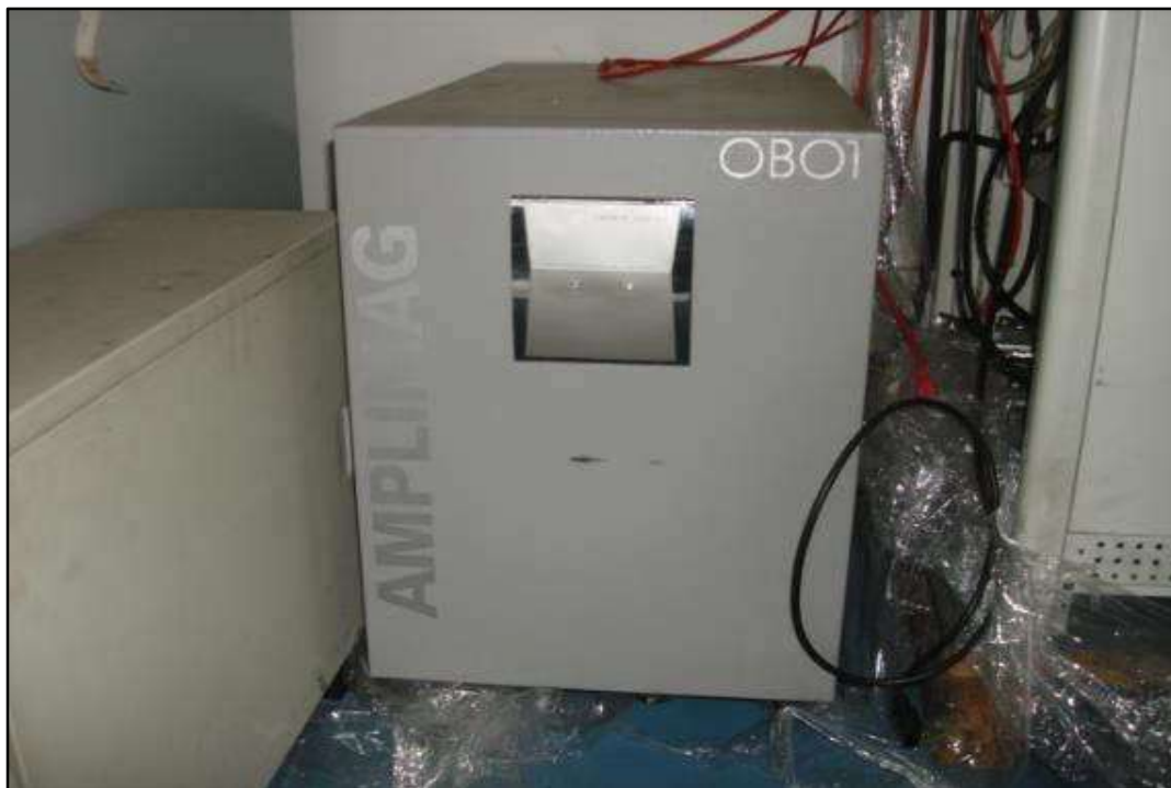
ITEM 0160 - VISTA DO ESTABILIZADOR DE TENSÃO MARCA: AMPLIMAG MOD: OB01
