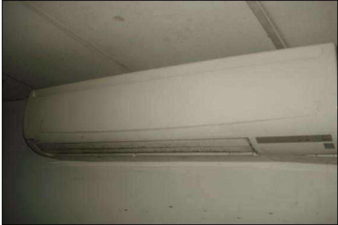
ITEM 1,344 - VISTA DO APARELHO DE AR CONDICIONADO - SPRINGER MAX FLEX
