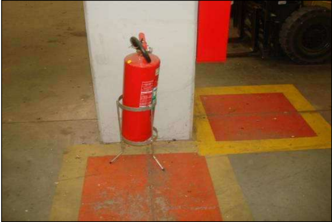
ITEM 2939 - VISTA DOS EXTINTORES (DIVERSOS)
