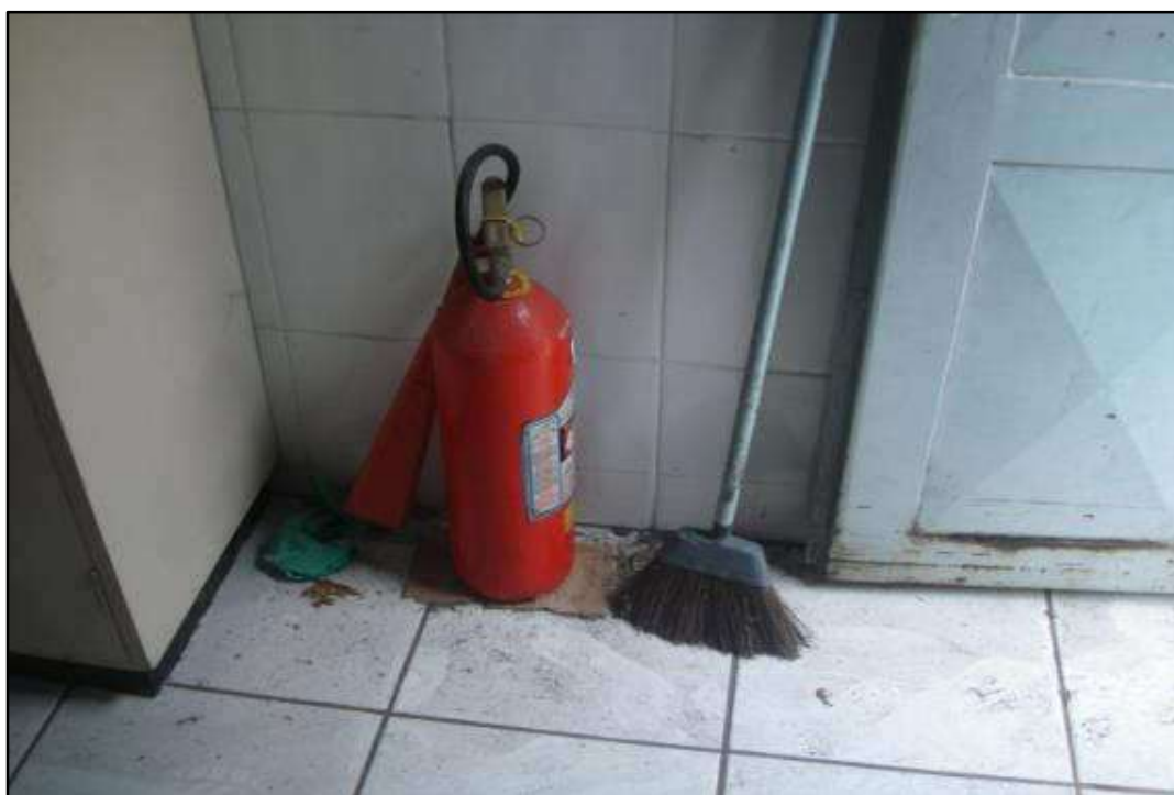
ITEM 1,622 - VISTA DO EXTINTOR
