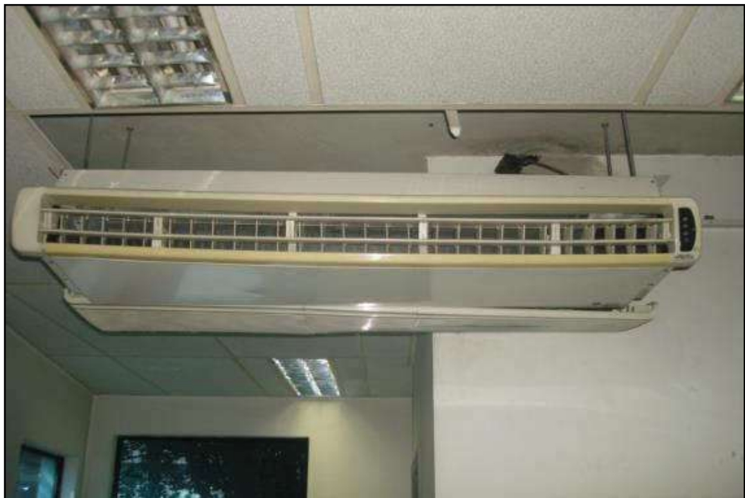
ITEM 1,804 - VISTA DO AR CONDICIONADO TRANE
