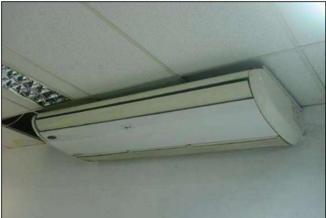
ITEM 1,140 - VISTA DO AR CONDICIONADO - CARRIER
