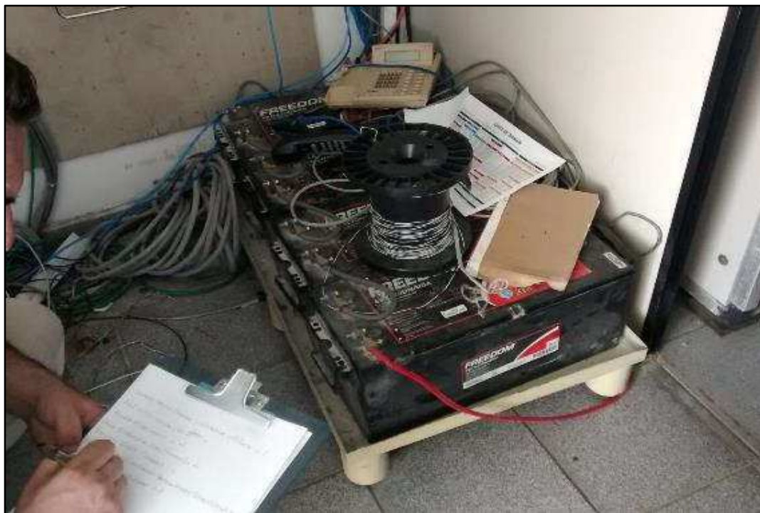
ITEM 1,417 - VISTA DO BANCO DE BATERIAS FREEDOM DF 2500 4 BATERIAS
