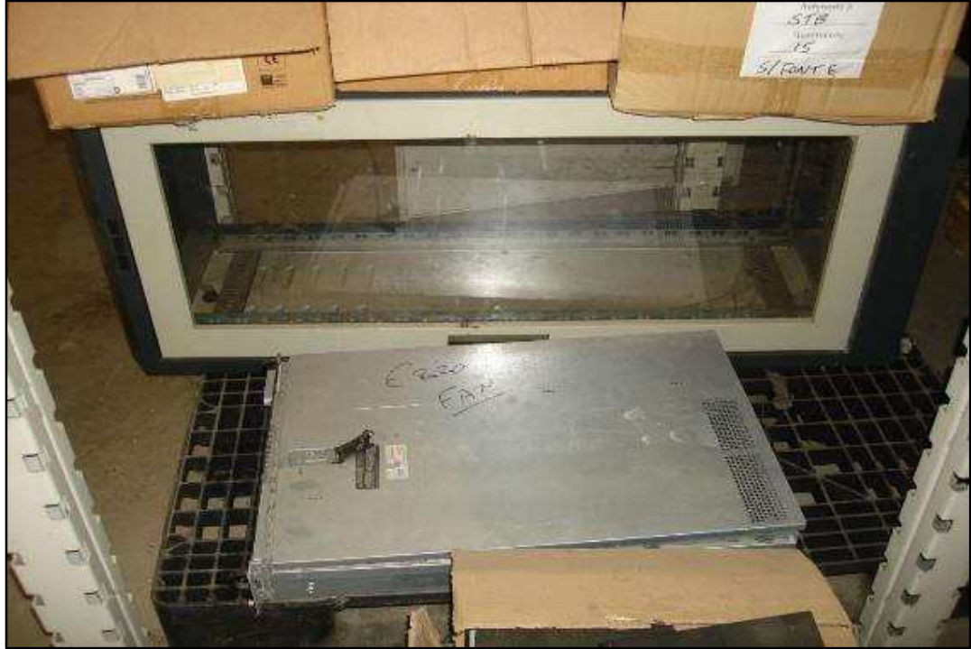
ITEM 2814 - VISTA DO RACK COM PORTA DE VIDRO DIM: 0,50X0,60X1,20
