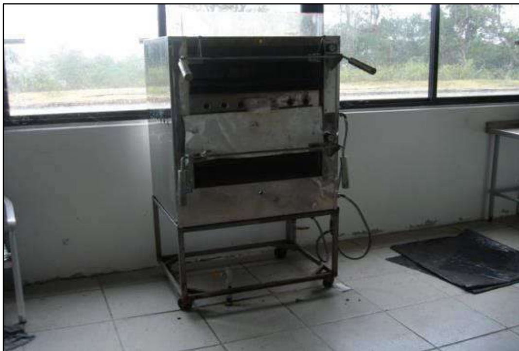
ITEM 0193 - VISTA DO FORNO INDUSTRIAL A GÁS DUAS CAMARAS MARCA: IMEQUE
