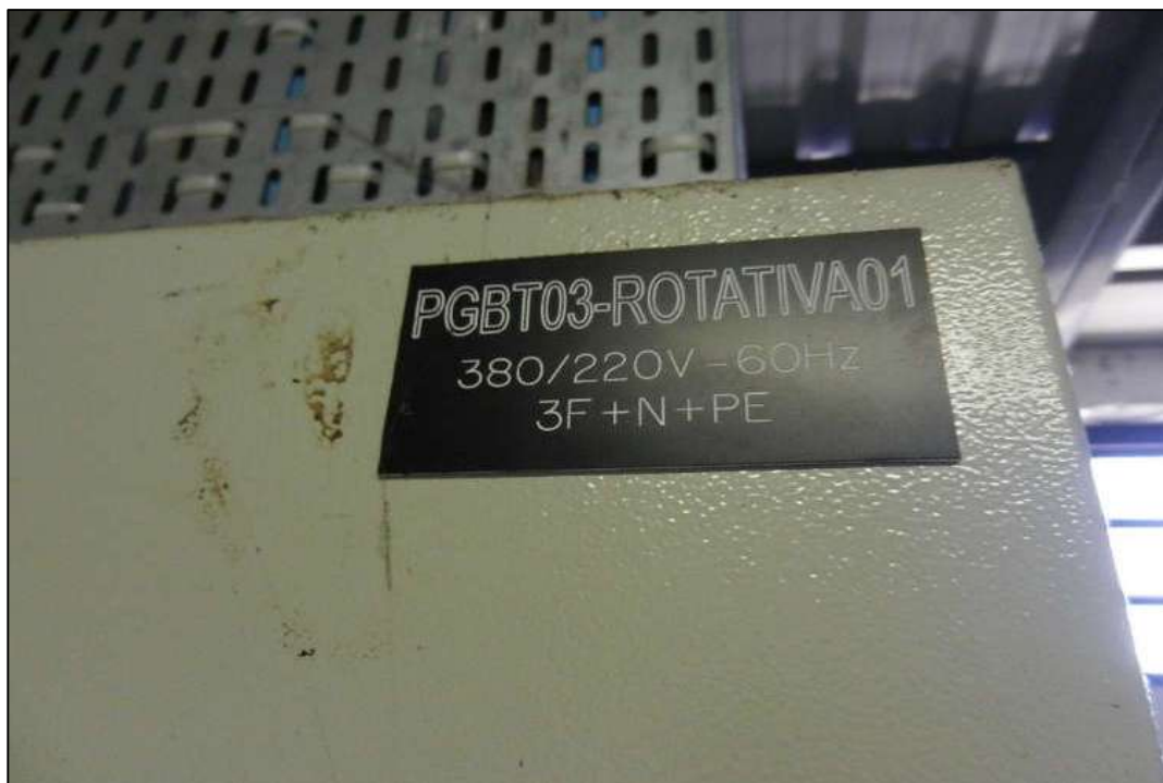
ITEM 1,125 - VISTA DO QUADRO DE COMANDO MARCA: MAK DIM: 2000 X 1400 X 850 MM TIPO: PGBT-03 - ROTATIVA 01 TENSÃO: 380/220V COM 1 DISJUNTOR GERAL MARCA: SCHNEIDER NW32H1 65 KA, MULTIMEDIDOR DE GRANDEZAS ELETRICAS, CONTROLADOR DE FATOR POTENCIA E DEMAIS COMPONENTES
