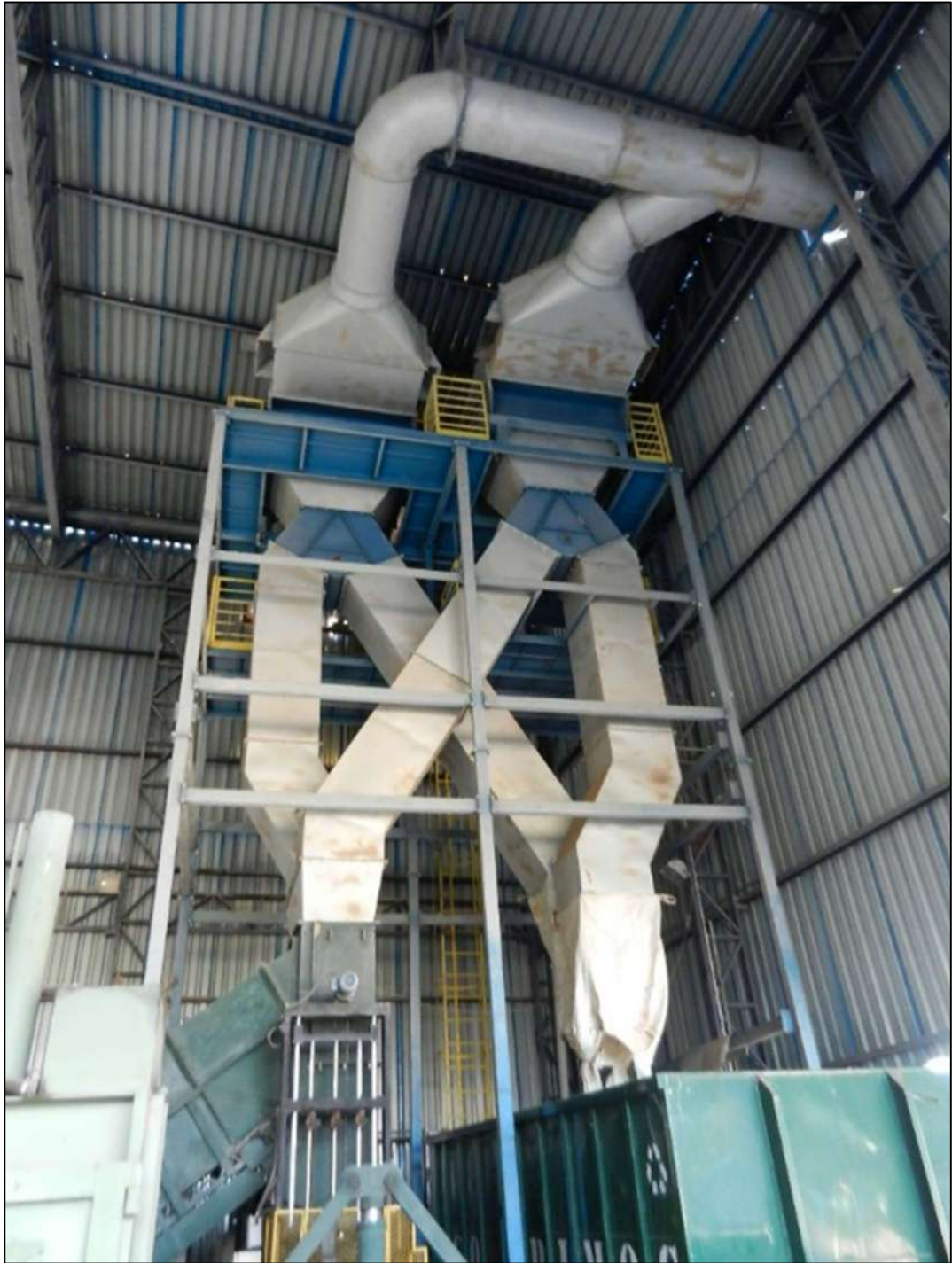
ITEM 1,146 - VISTA DA LINHA DE Prensagem de Aparas de Papel compreendendo os itens (2 MOEGAS para recebimento das aparas com duto de descarga para alimentação de prensa ou de container e plataforma metálica)
