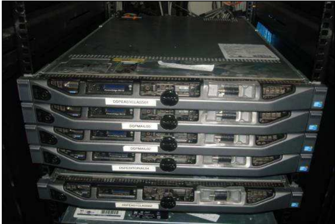
ITEM 1,352 - VISTA DO SERVIDOR DELL POWER EDGE R610
