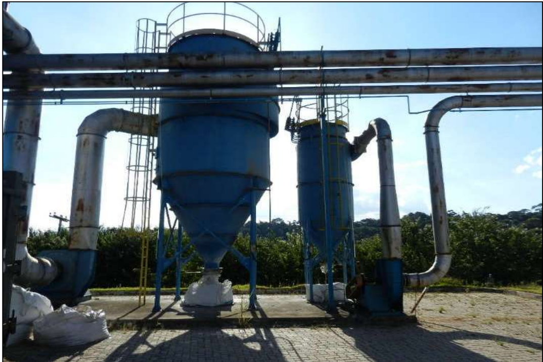
ITEM 1,146 - VISTA DA LINHA DE PENSAGEM DE APARAS DE PAPEL COMPREENDENDO OS ITENS (2 CICLONES COM VENTILADORES)
