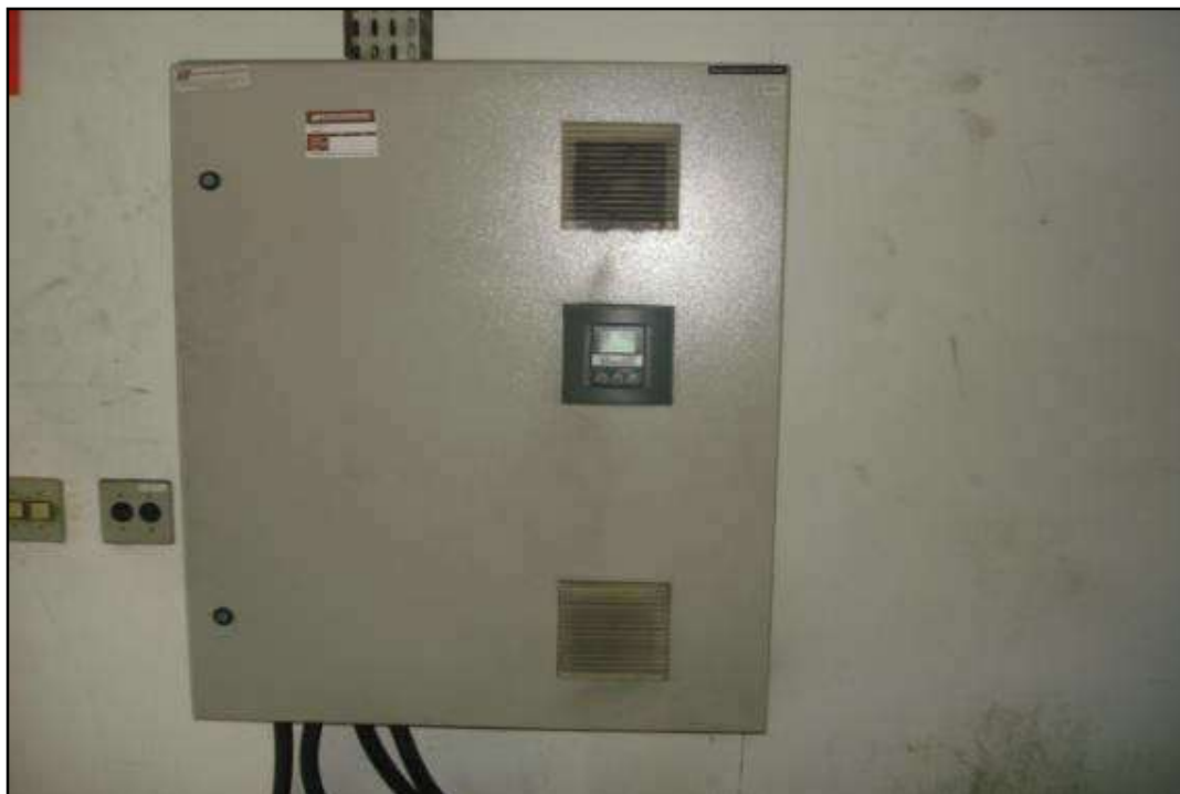
ITEM 1,878 - VISTA DO BANCO AUTOMÁTICO DE CAPACITOR TRIFÁSICO 2006
