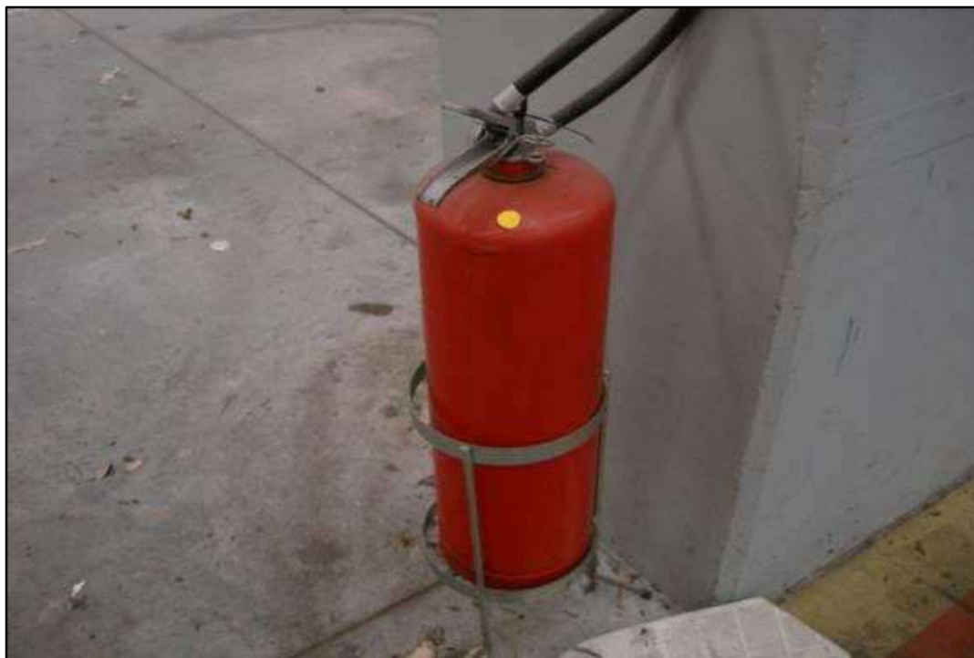
ITEM 2943 - VISTA DO EXTINTOR PÓ QUÍMICO
