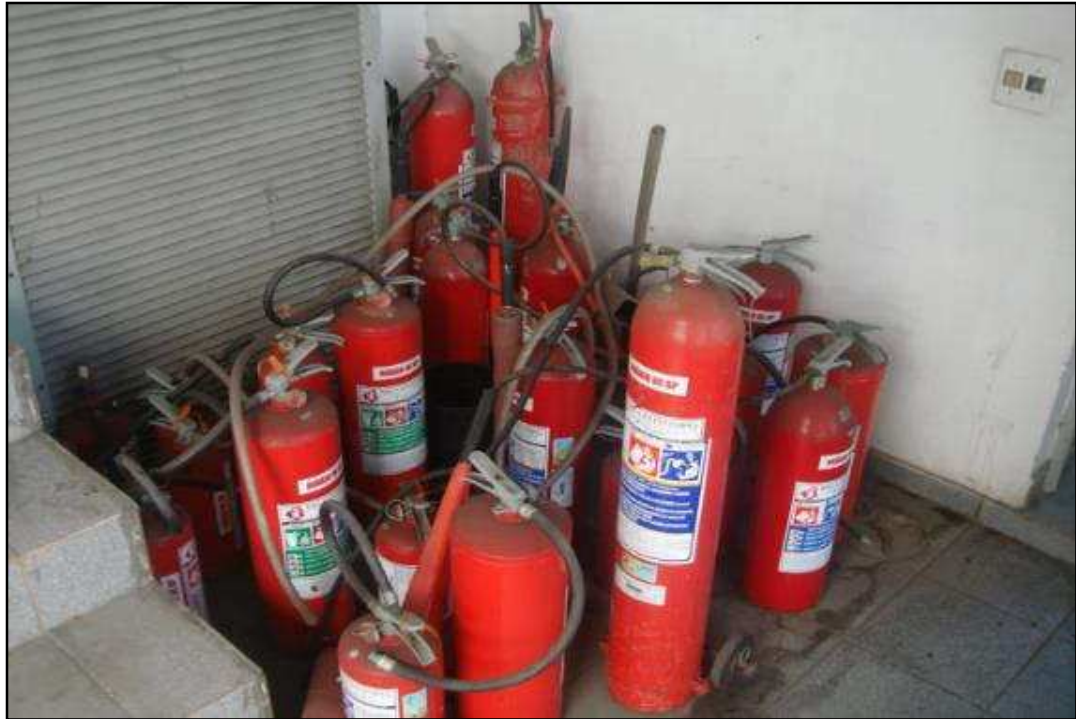
ITEM 1,802 - VISTA DOS EXTINTORES
