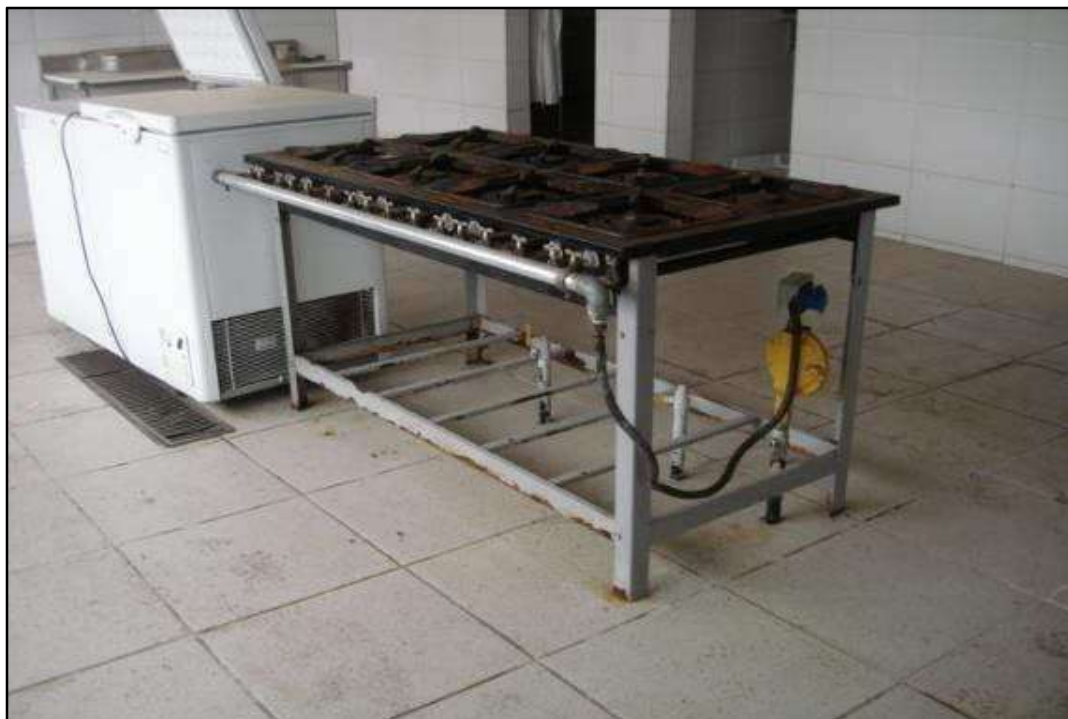
ITEM 0191 - VISTA DO FOGÃO INDUSTRIAL COM 8 BOCAS
