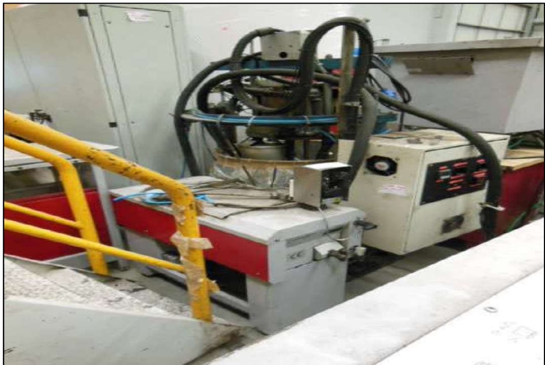
ITEM 1,041 - VISTA DO PRE MELT PUR
