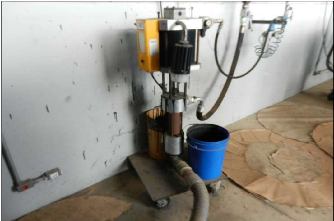
ITEM 1,122 - VISTA DAS 4 (QUATRO) BOMBAS PARA TINTA MARCA: BETZ TECHNOLOGIES TIPO: P-250-1 PLC SERIES: 71210-520, 71210-518, 71210-519 E 71210-521
