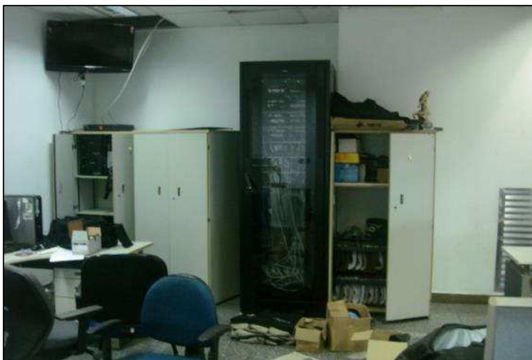
ITEM 1,138 - VISTA DO RACK PARA SERVIDOR
