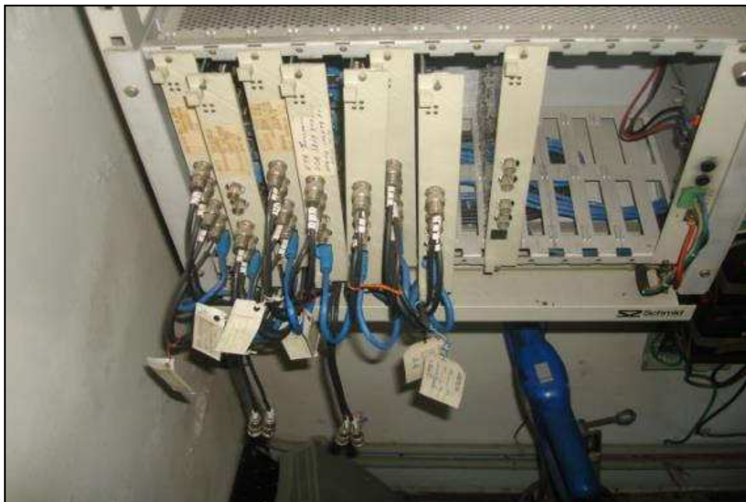
ITEM 1,810 - VISTA DO DG BLOCO BLI SCHMID COM 8 MÓDULOS
