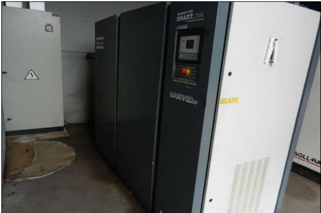
ITEM 1,111 - VISTA DO COMPRESSOR DE AR MARCA: ATLAS COPCO MODELO: GA90VSDFF 380/220 V SERIE: BRP082146
