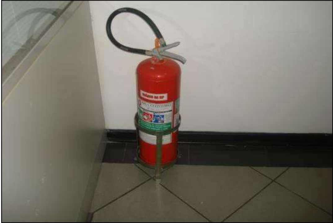
ITEM 1,223 - VISTA DO EXTINTOR DE INCÊNDIO
