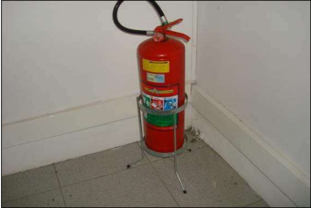
ITEM 0103 - VISTA DO EXTINTOR 10L
