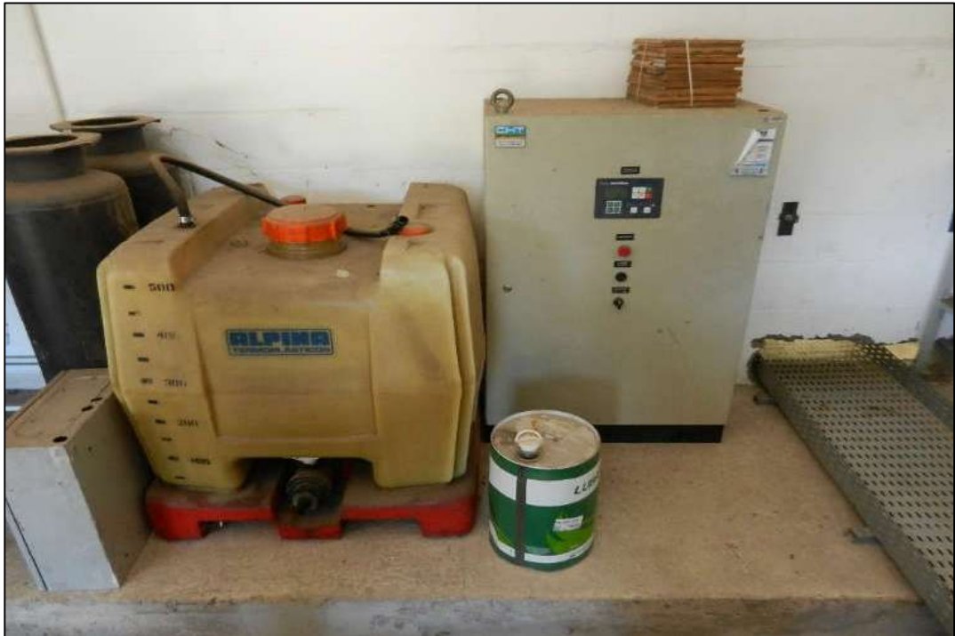
ITEM 1,109 / 1,110 - VISTA DO GRUPO GERADOR A DIESEL MARCA: SDMO TIPO: LSA-50.1 S4-4P CAP: 1.025 KVA 400 V (PAINEL DE COMANDO) E TANQUE PLASTICO MARCA: ALPINA CAP: 500 L
