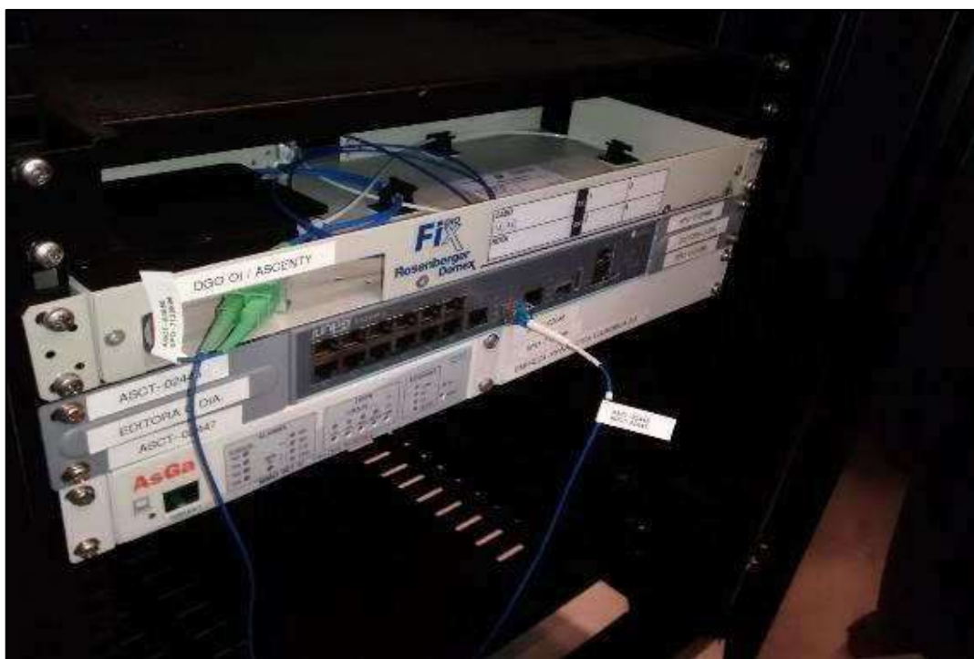
ITEM 1,066 AO 1,068 - VISTA DO ROSENBERGER DOMEX, DO JUNIPER EX2200-C E DO ASGA MMO2E FIBER OPTIC MULTIPLEXER
