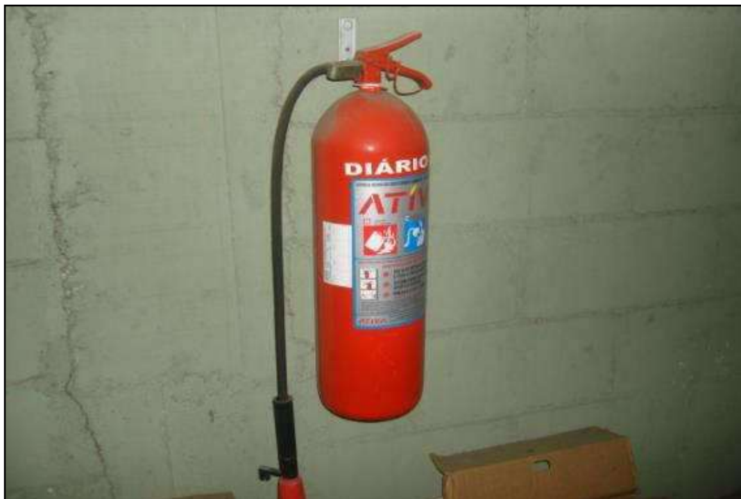
ITEM 1,675 - VISTA DO EXTINTOR
