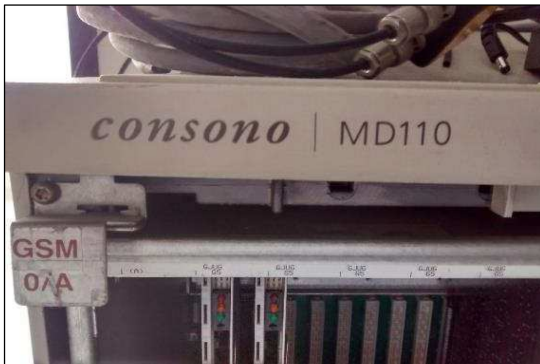
ITEM 1,410 - VISTA DO CONSONO MD110 ERICSSON COM 3 MÓDULOS C 33 PLACAS
