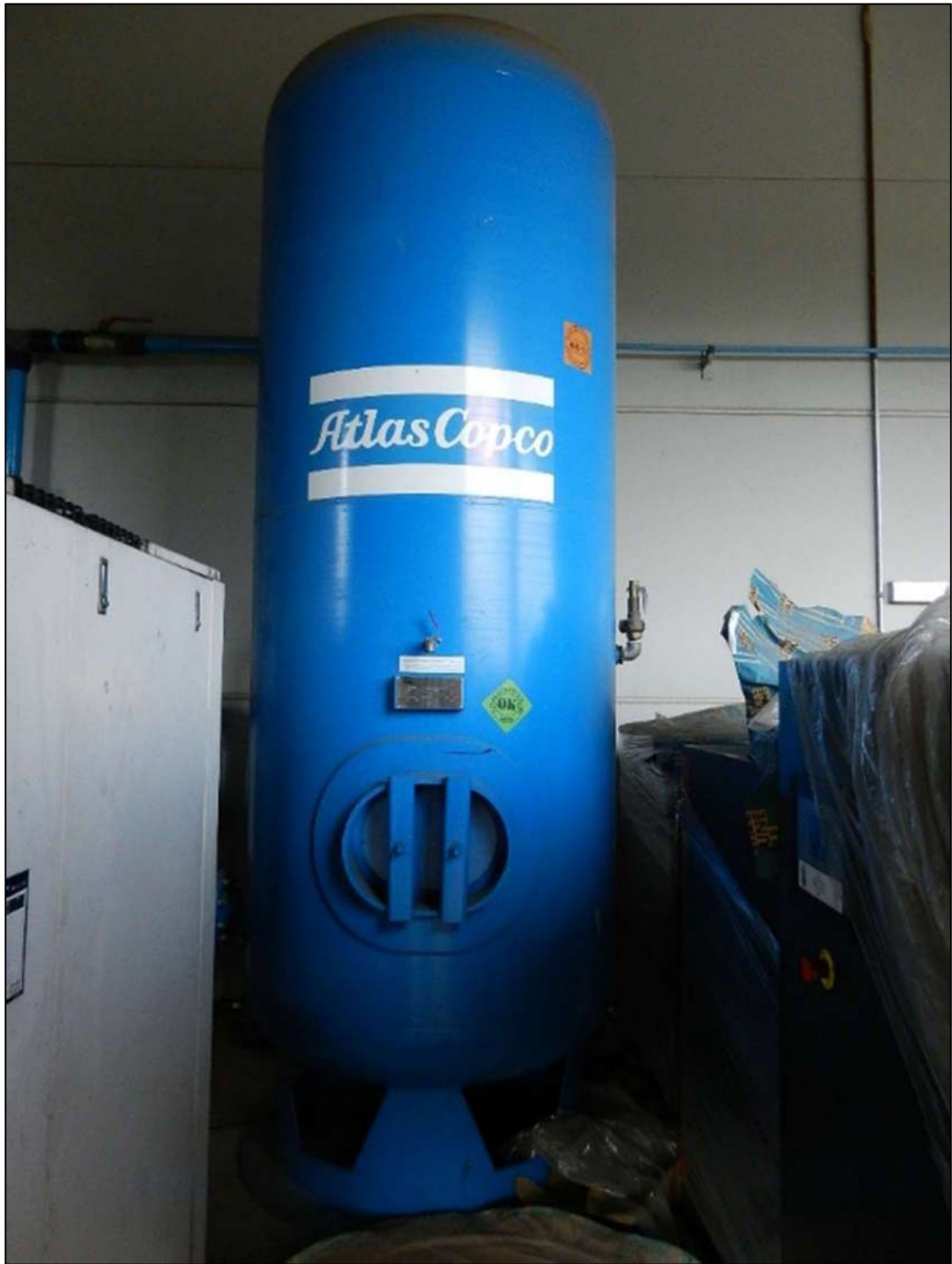
ITEM 1,114 - VISTA DO SEPARADOR DE CONDENSADO MARCA: ATLAS COPCO MODELO: 1028853020 SERIE: 74156 CAP: 4.000 L
