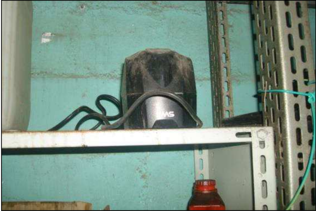
ITEM 1,845 - VISTA DO ESTABILIZADOR SMS
