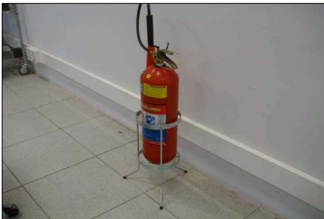
ITEM 0009 - VISTA DO EXTINTOR BC 6KG
