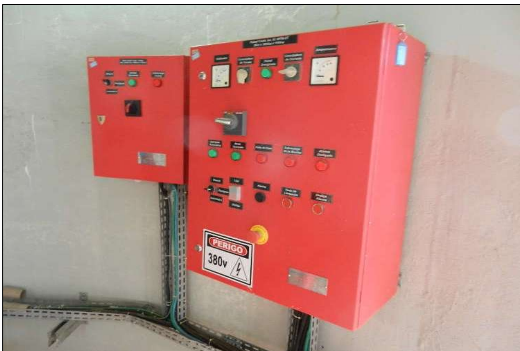
ITEM 1,132 - VISTA DO SISTEMA DE INCENDIO MARCA: GERMEK COMPREENDENDO: BOMBA CENTRIFUGA PARA INCENDIO MARCA: THEBE MODELO: RL20B(F) SERIE: 22.188 COM MOTOR ELETRICO DE 25 CV, BOMBA JOCKEY MARCA: THEBE MODELO: P-11/4 COM MOTOR ELETRICO DE 3 CV (PAINEL DE COMANDO)
