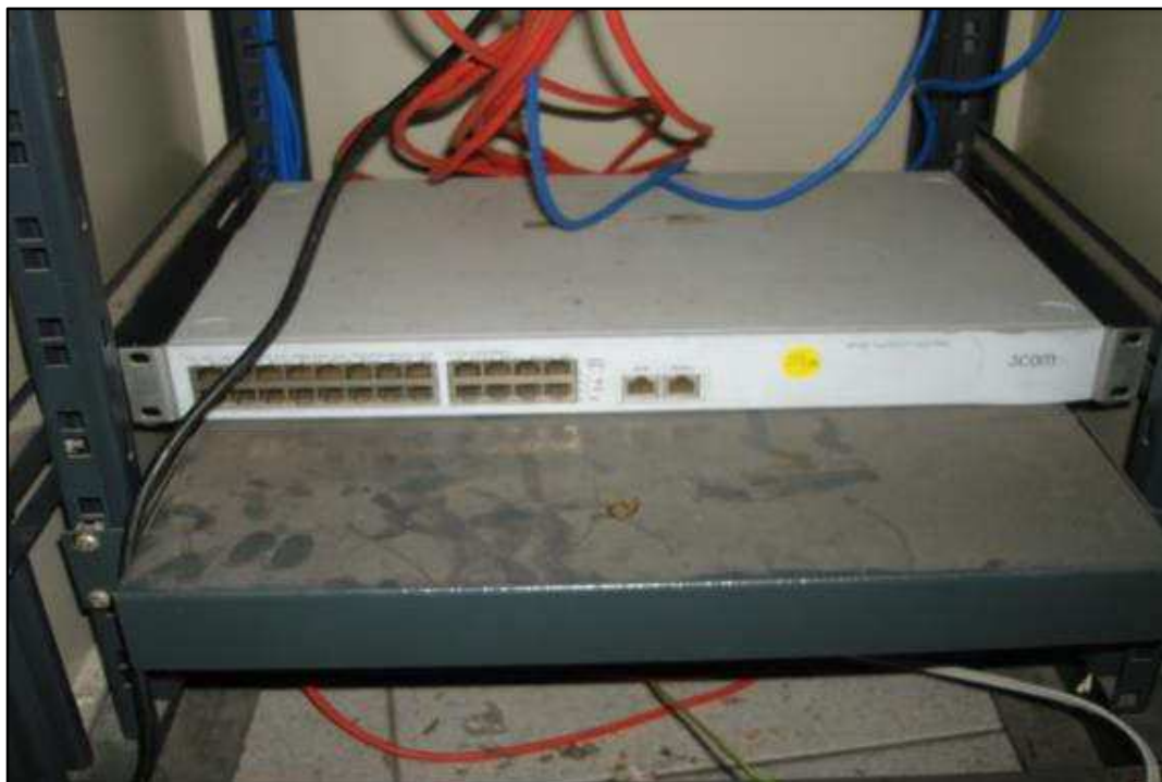
ITEM 0138 - VISTA DO SWITCH MARCA: 3COM MOD: SUPERSTACK 3 4226T
