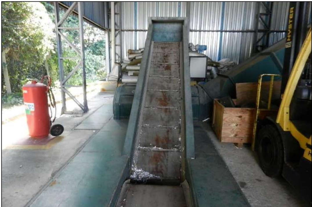
ITEM 1,146 - VISTA DA LINHA DE PRENSAGEM DE APARAS DE PAPEL COMPREENDENDO OS ITENS (ESTEIRA DE ALIMENTAÇÃO INCLINADA)
