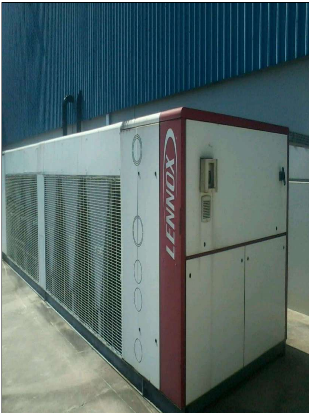
ITEM 1,163 - VISTA DO RESFRIADOR DE LIQUIDOS MARCA: LENNOX
