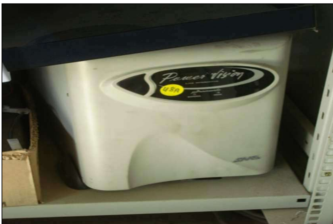
ITEM 0100 - VISTA DO PROTETOR TELEFÔNICO MARCA: SMS MOD: POWER VISION 220V
