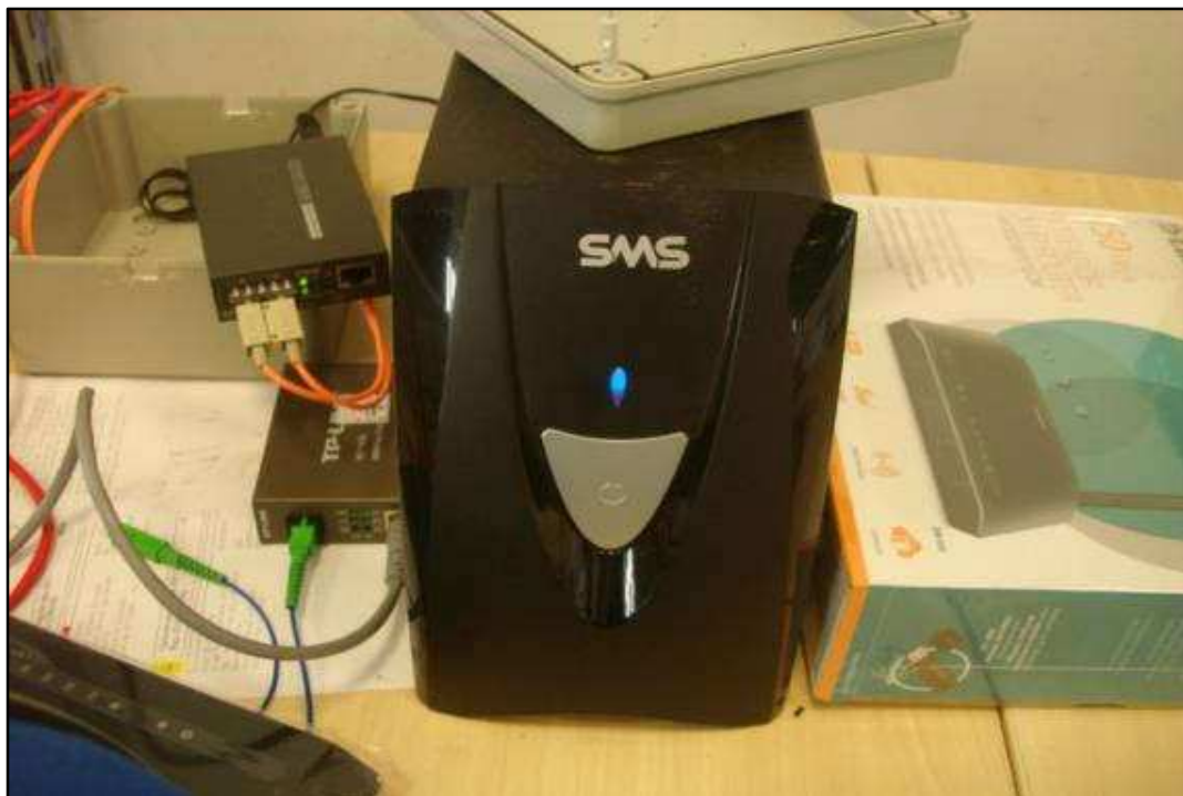
ITEM 0034 - VISTA DO ESTABILIZADOR MARCA: SMS TECNO MOD: NET STATION UST1200S
