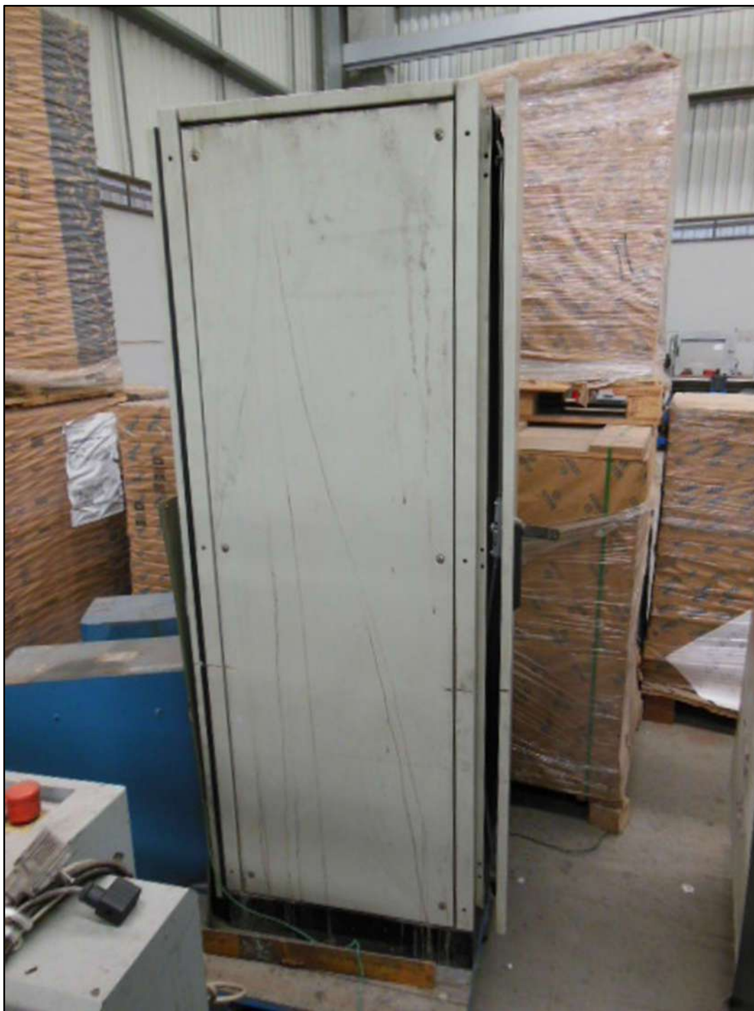
ITEM 1,077 - VISTA DO PAINEL DE CONTROLE E COMANDO DOS EXAUSTORES MARCA: VALE MAQUINA
