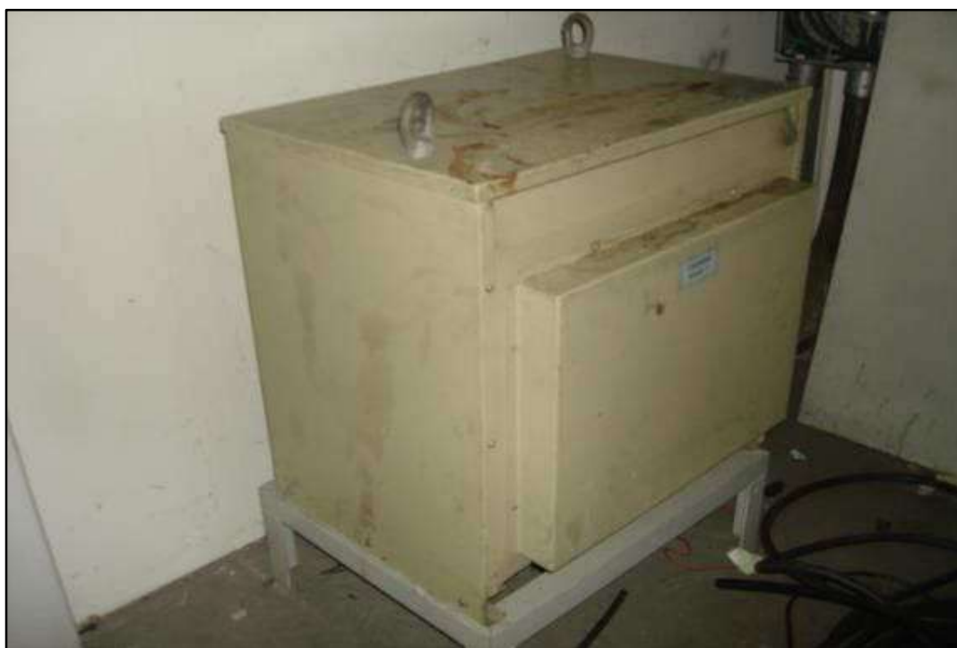
ITEM 2952 - VISTA DO TRANSFORMADOR MARCA: FB IMEL MOD: 75 KVA
