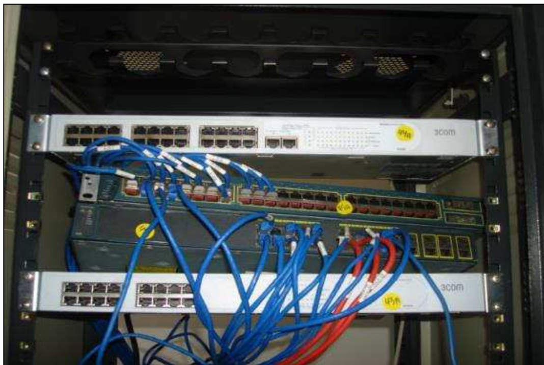
ITEM 0089 AO ITEM 0091 - VISTA DO SWITCH MARCA: 3COM MOD: SWITCH 2126G BASELINE COM 24 PORTAS E DO SWITCH MARCA: 3COM MOD: SWITCH 2816 BASELINE COM 16 PORTAS E 4226T SUPERSTACK3 COM 24 PORTAS
