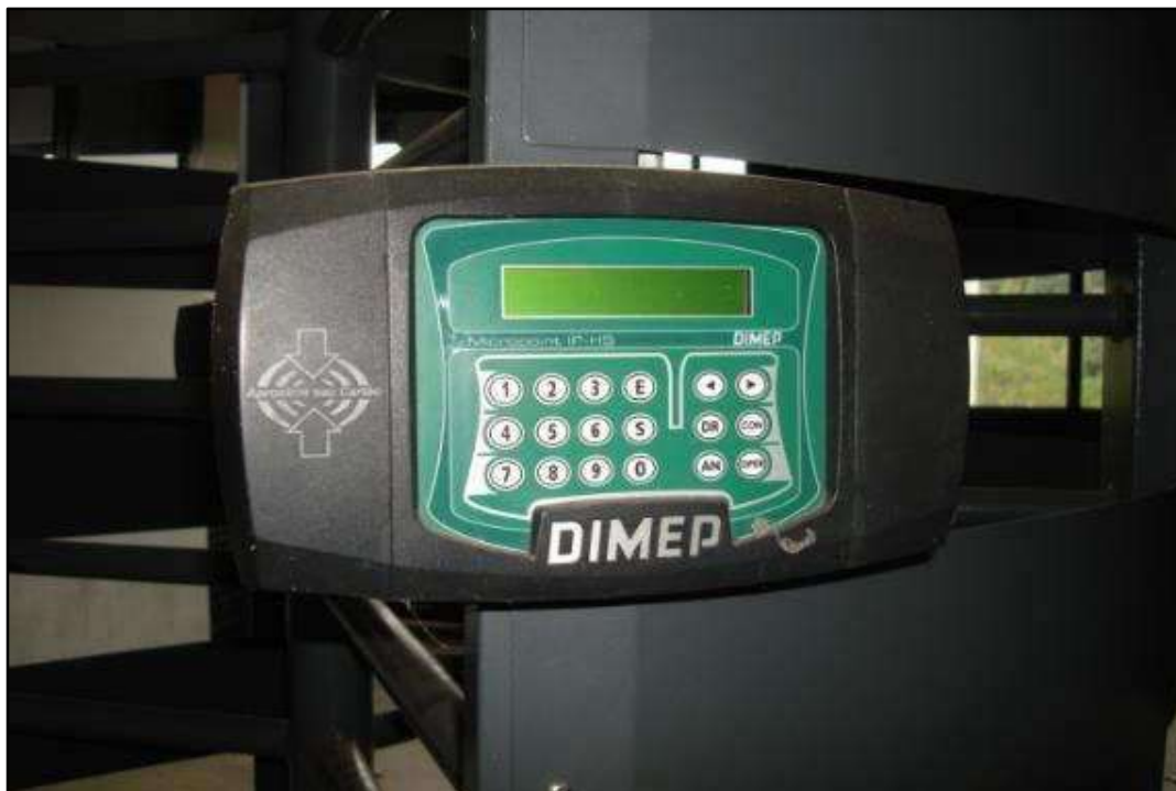
ITEM 0228 - VISTA DO CONTROLE DE ACESSO MARCA: DIMEP MOD: MICROPOINT IP HS
