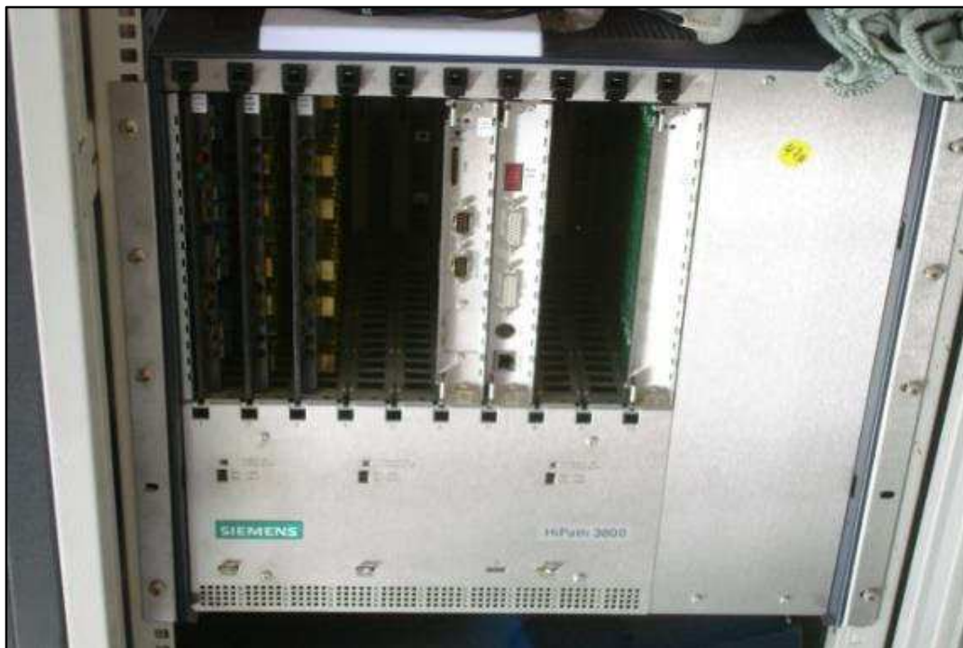
ITEM 0099 - VISTA DA CENTRAL DE TELEFONIA MARCA: SIEMENS MOD: HIPATH 3800
