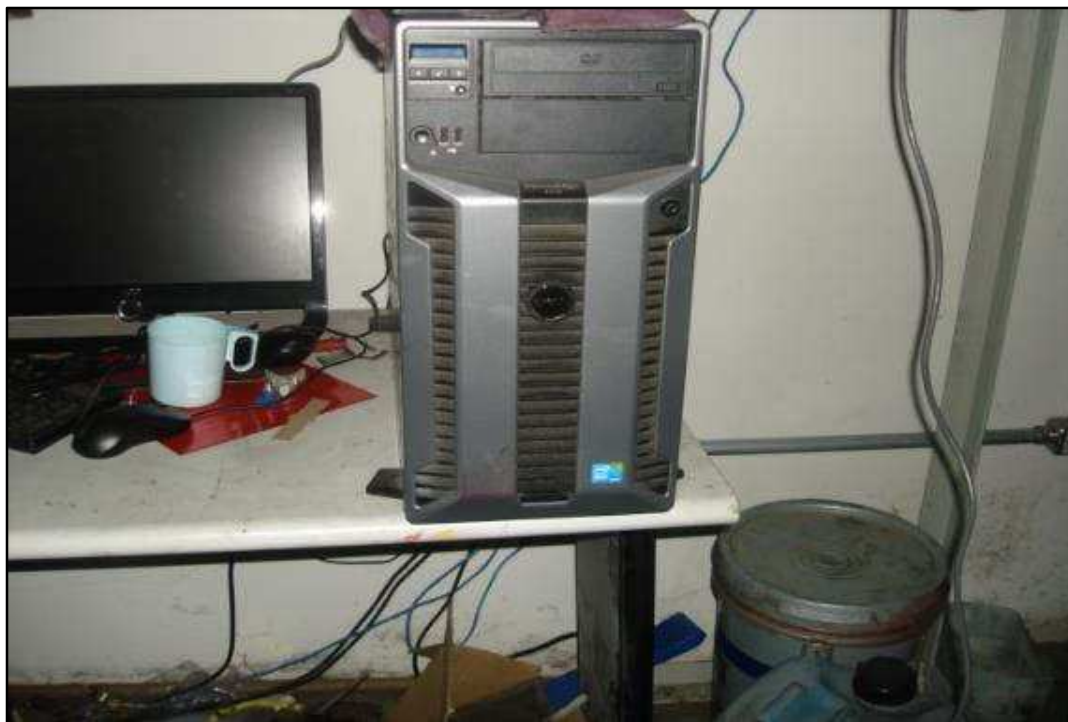
ITEM 2963 - VISTA DO SERVIDOR MARCA: DELL MOD: EDGE T610
