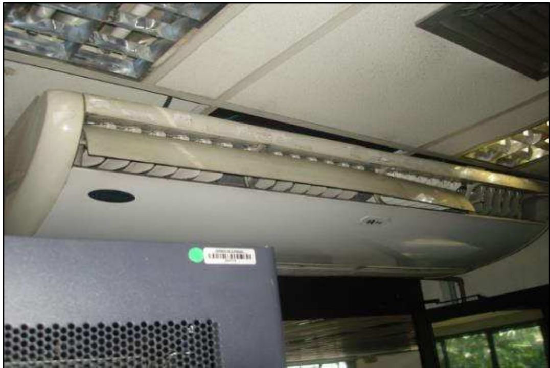
ITEM 1,345 - VISTA DO APARELHO DE AR CONDICIONADO - CARRIER
