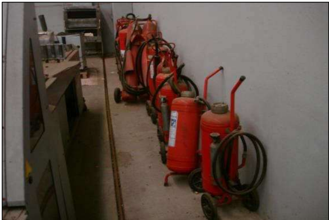
ITEM 2942 - VISTA DO EXTINTOR DE CARGA DE ÁGUA PRESSURIZAÇÃO SOBER RODAS DIM: 11715
