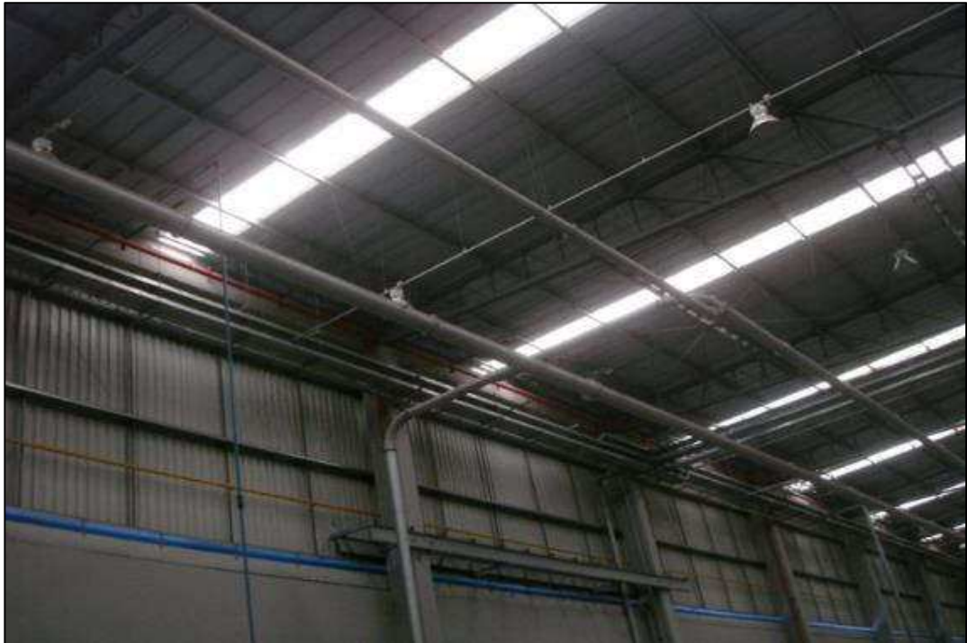
VISTA DOS DUTOS
