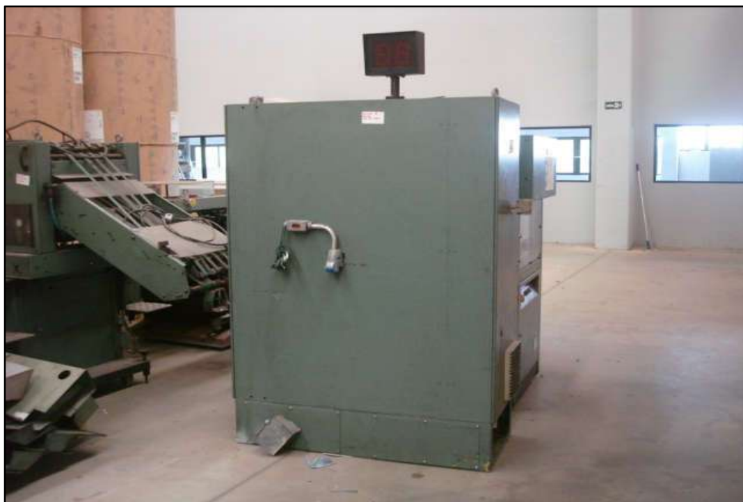
ITEM 1,040 - VISTA DOS PAINÉIS DE COMANDO
