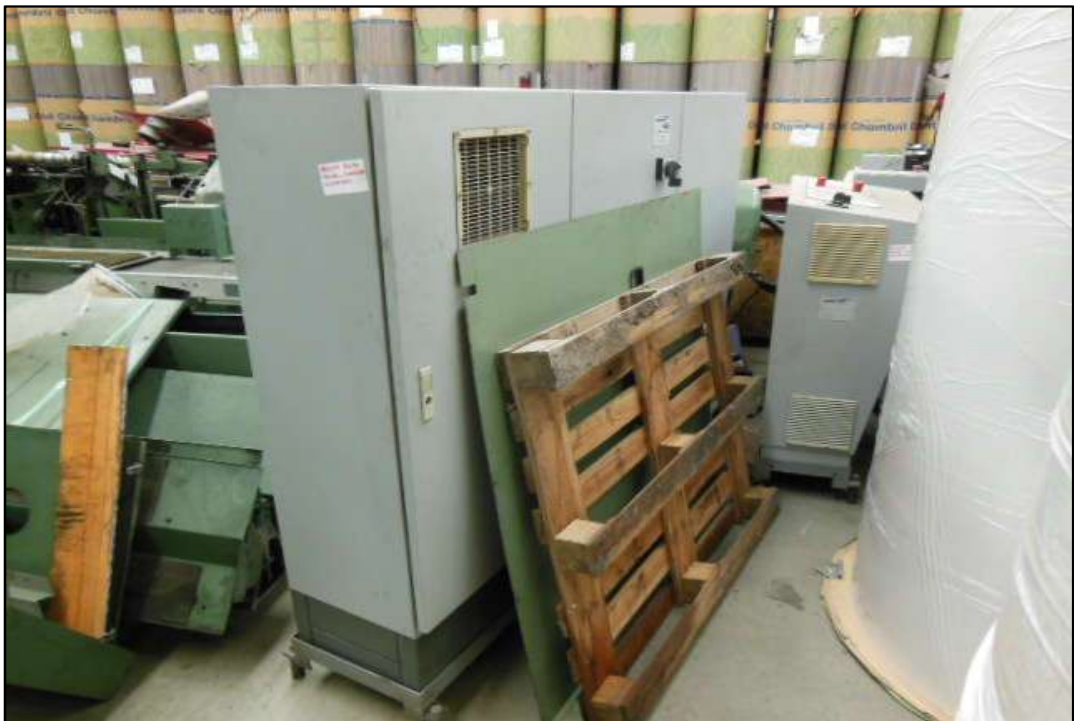
ITEM 1,041 - VISTA DOS 2 PAINÉIS DE COMANDO DAS ESTEIRAS
