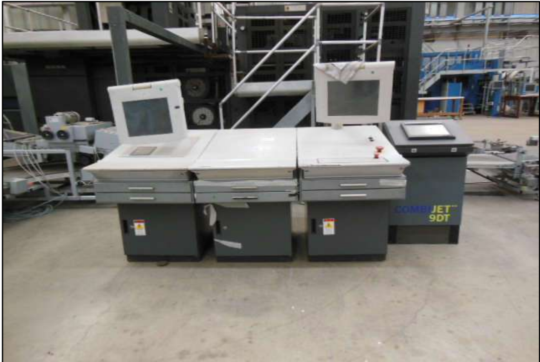
ITEM 1,033 - VISTA DO PAINEL DE COMANDO E CONTROLE MARCA: PLANATOL MODELO: COMBIJET 9DT
