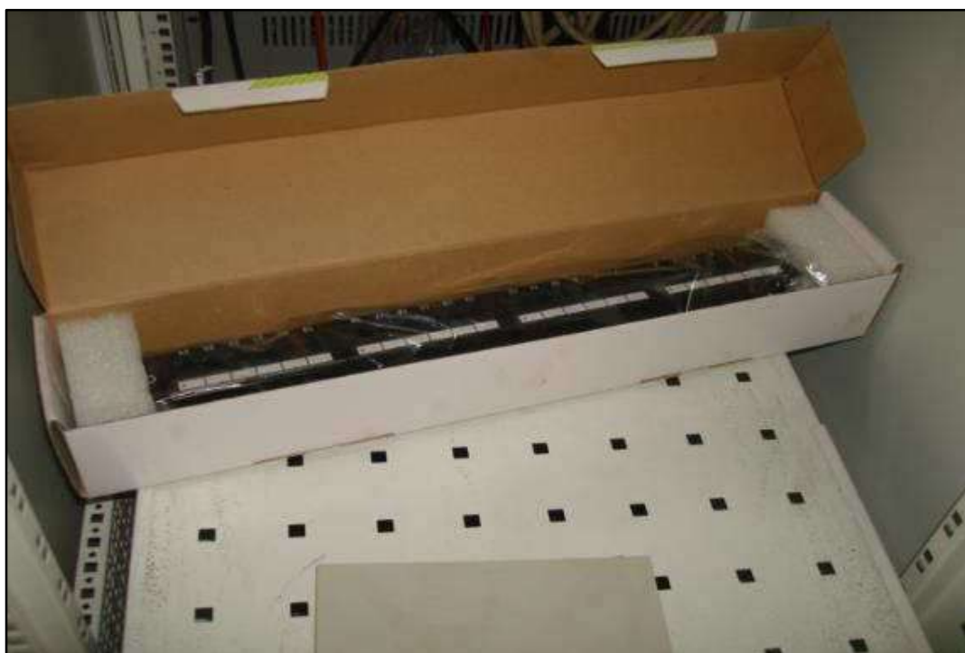
ITEM 0174 - VISTA DO PATCH PANEL MARCA: FURUKAWA MOD: SOHO PLUS
