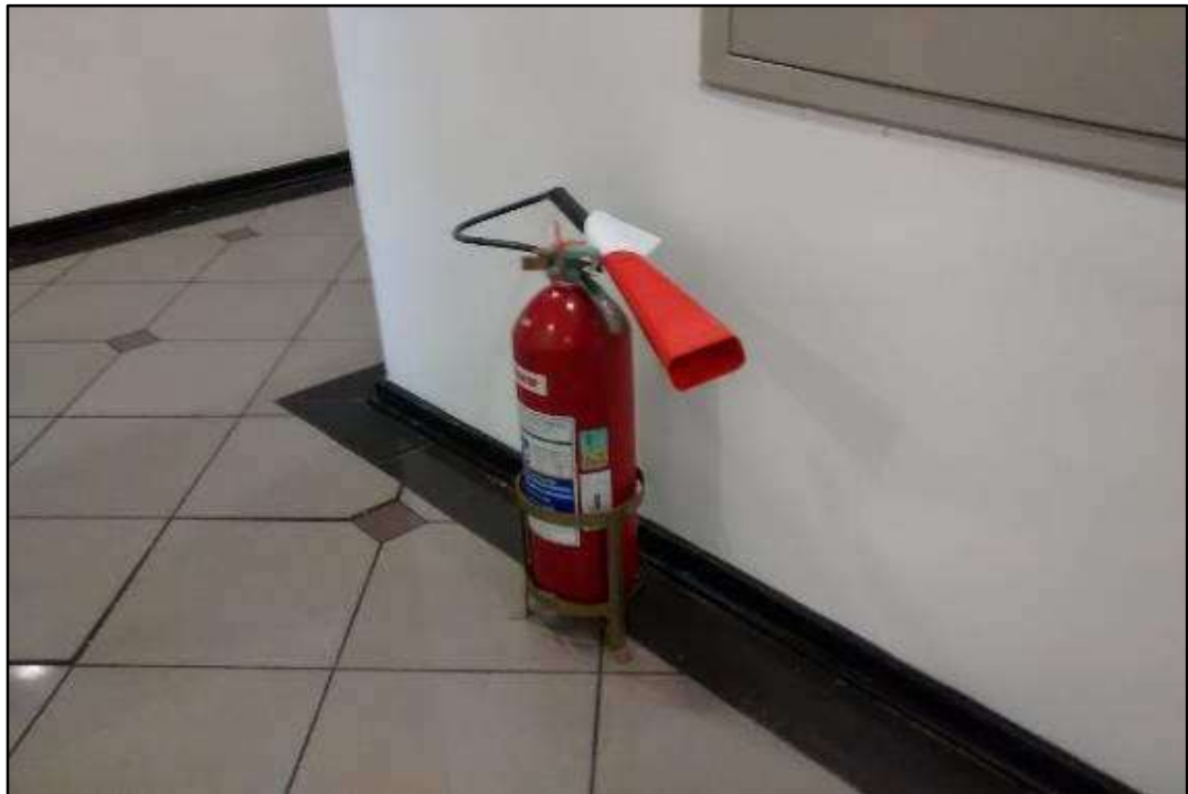
ITEM 1,199 - VISTA DO EXTINTOR DE INCÊNDIO
