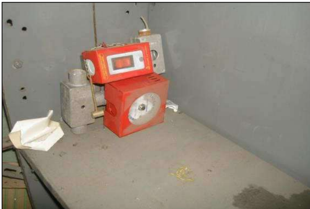
ITEM 1,681 - VISTA DA CAIXA SISTEMA DE INCÊNDIO
