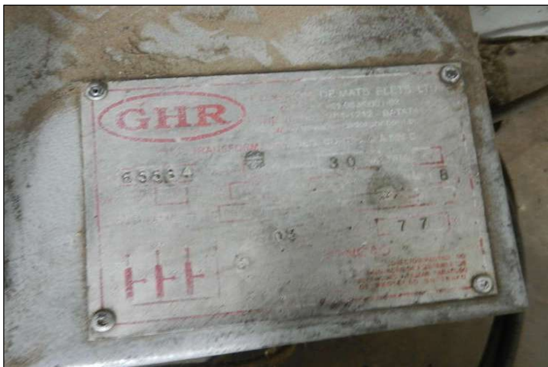
ITEM 1,117 - VISTA DO TRANSFORMADOR REG CONTINUO A SECO MARCA: GHR Nº 65.584 CAP: 30 KVA (PLACA DE IDENTIFICAÇÃO)
