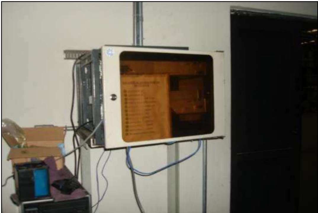
ITEM 2967 - VISTA DO RACK PEQ. PARA SWITCH COM PORTA DE VIDRO
