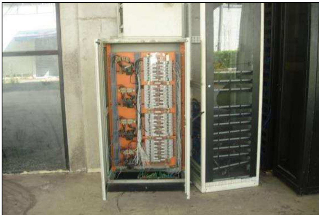
ITEM 1,821 - VISTA DO QUADRO DE FORÇA
