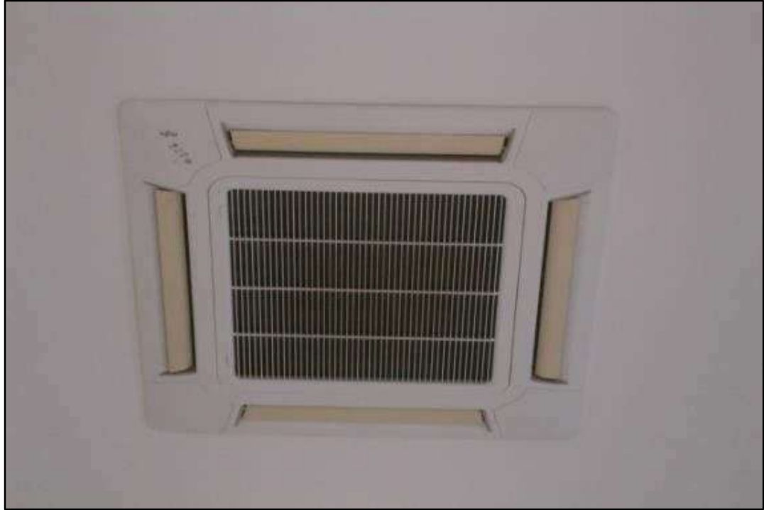
ITEM 0082 - VISTA DO AR CONDICIONADO DE TETO MARCA: FUJITSU DIM: 1000X1000MM
