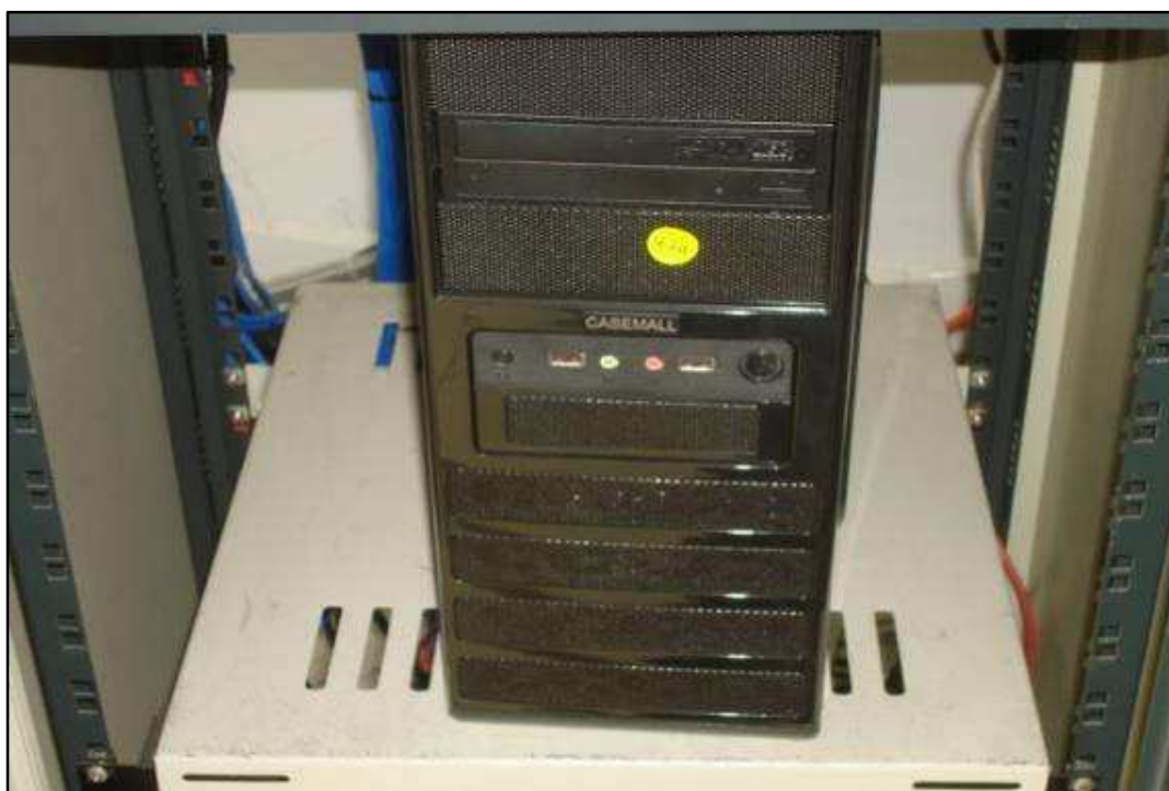
ITEM 0096 - VISTA DO SERVIDOR MARCA: CASEMALL COM 1 UNIDADE DVDRW
