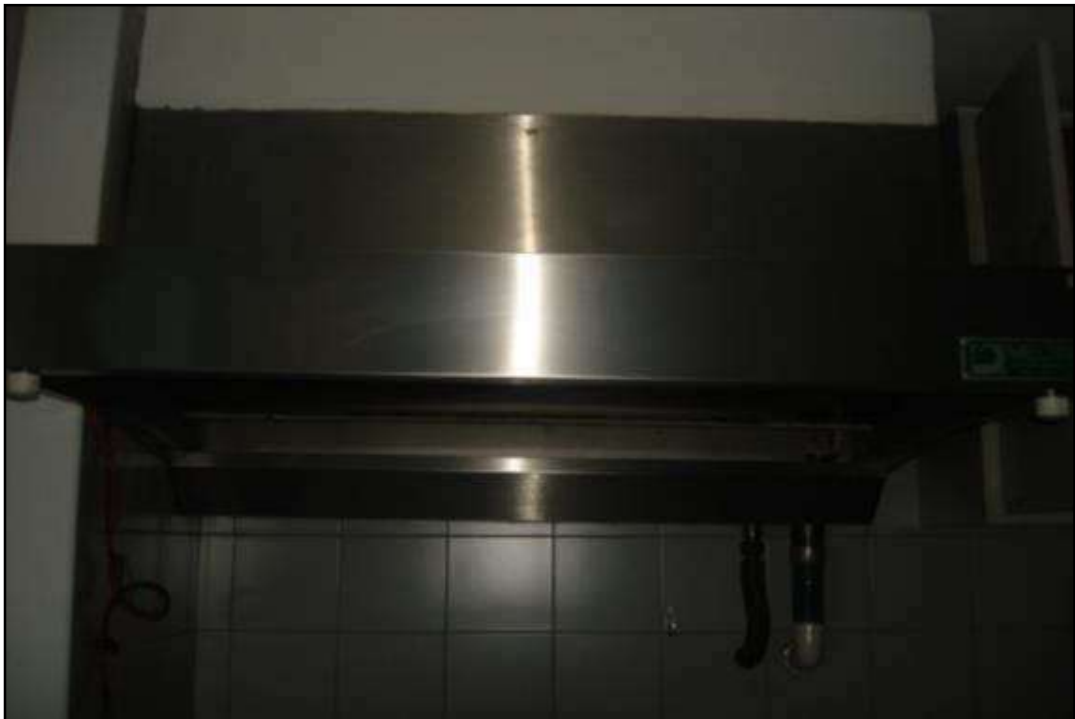
ITEM 1,766 - VISTA DO EXAUSTOR DE ALUMÍNIO MELTING
