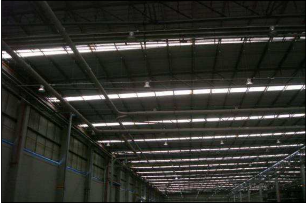
VISTA DOS DUTOS
