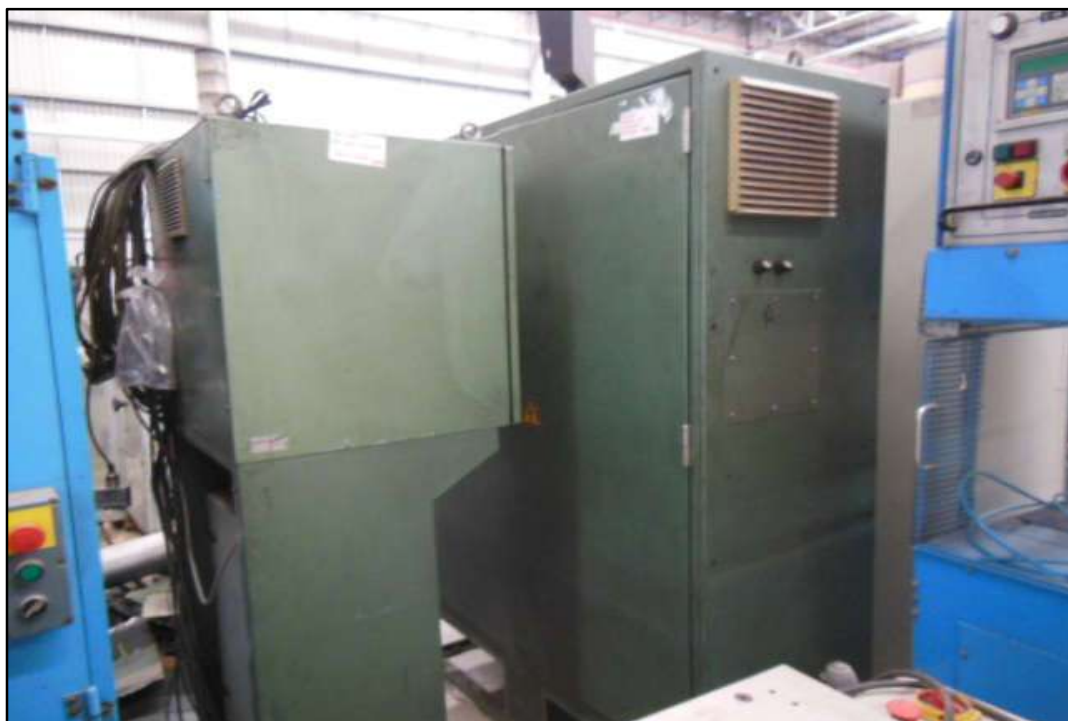
ITEM 1,039 - VISTA DOS PAINÉIS DE COMANDO E DO PAINEL ELÉTRICO
