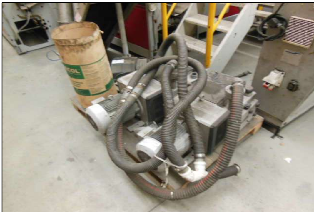
ITEM 1,041 - VISTA DAS 3 BOMBAS DE VÁCUO
