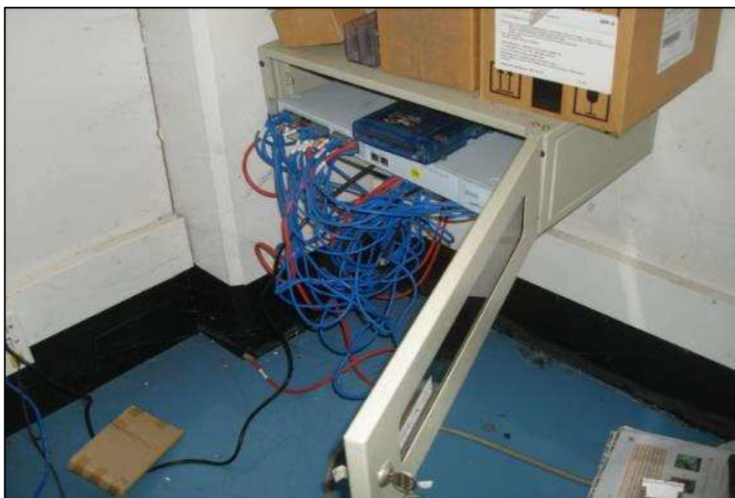
ITEM 0176 - VISTA DO RACK PARA SWITCH DIM: 50X25X15 CM
