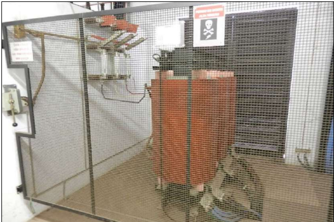
ITEM 1,153 - VISTA DA CABINE SECUNDARIA COMPREENDENDO: 1 CHAVE SECCIONADORA, 1 TRANSFORMADOR A SECO MARCA: SIEMENS CAP: 1.500 KVA, 13,8/380/220V
