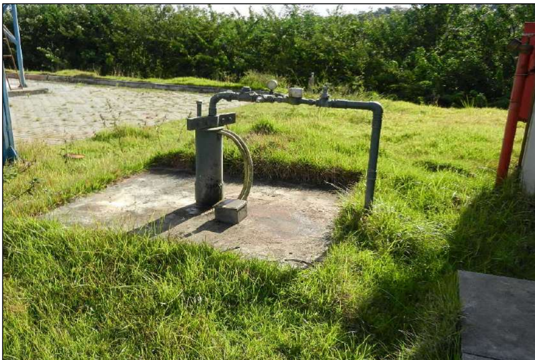
ITEM 1,133 - VISTA DA BOMBA SUBMERSA
