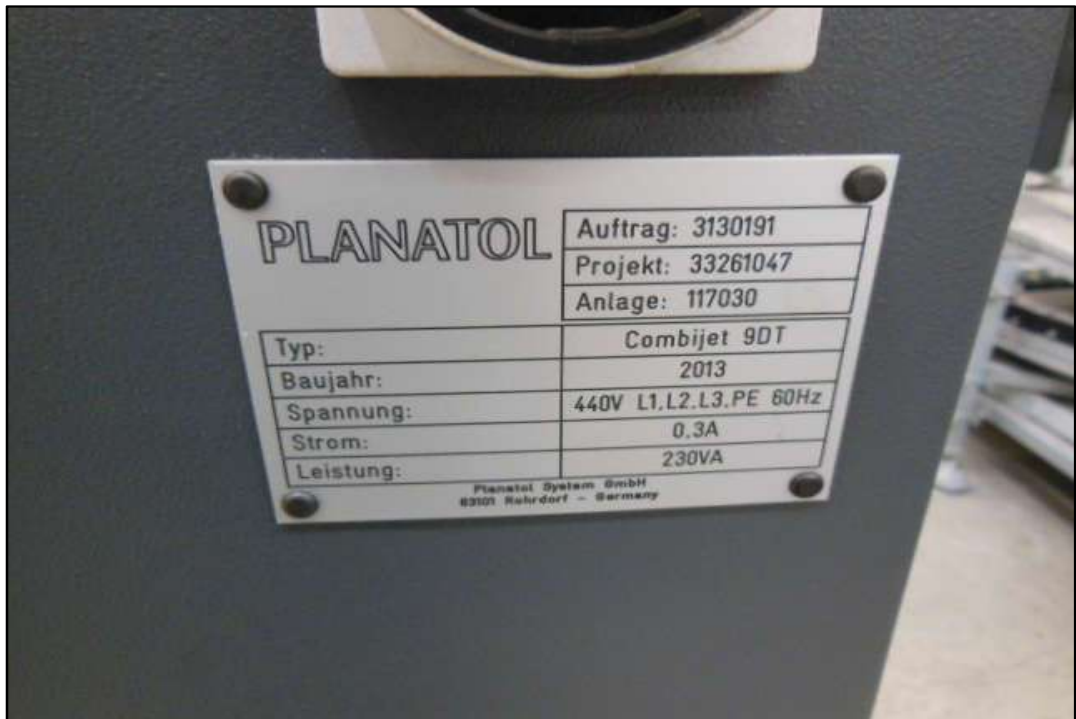
ITEM 1,033 - VISTA DA PLACA DE IDENTIFICAÇÃO DO PAINEL DE COMANDO E CONTROLE MARCA: PLANATOL MODELO: COMBIJET 9DT
