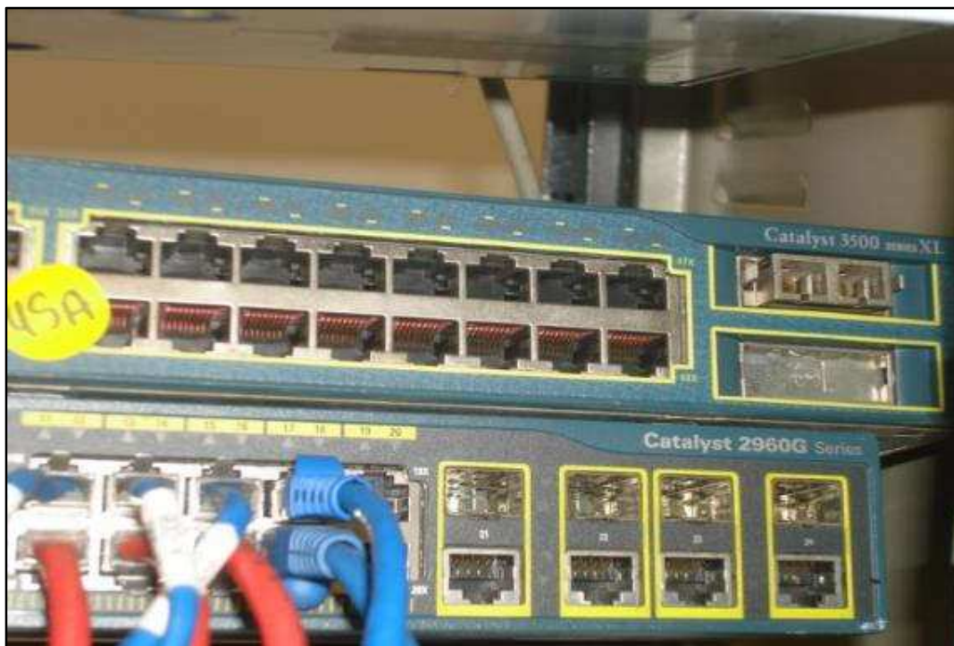
ITEM 0092 e ITEM 0093 - VISTA DO ROTEADOR MARCA: CISCO MOD: CATALYST 2960G SERIES COM 24 PORTAS E DO ROTEADOR MARCA: CISCO MOD: CATALYST 3500 SERIES XL COM 48 PORTAS
