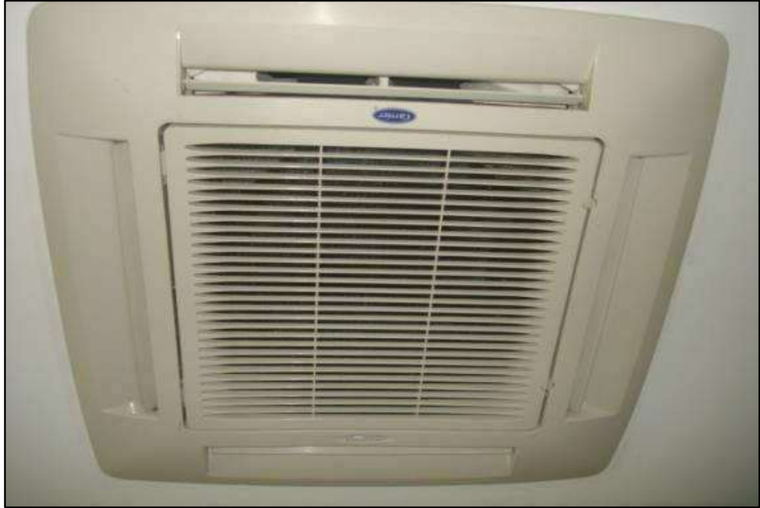
ITEM 1,305 - VISTA DO AR CONDICIONADO CASSETE CARRIER
