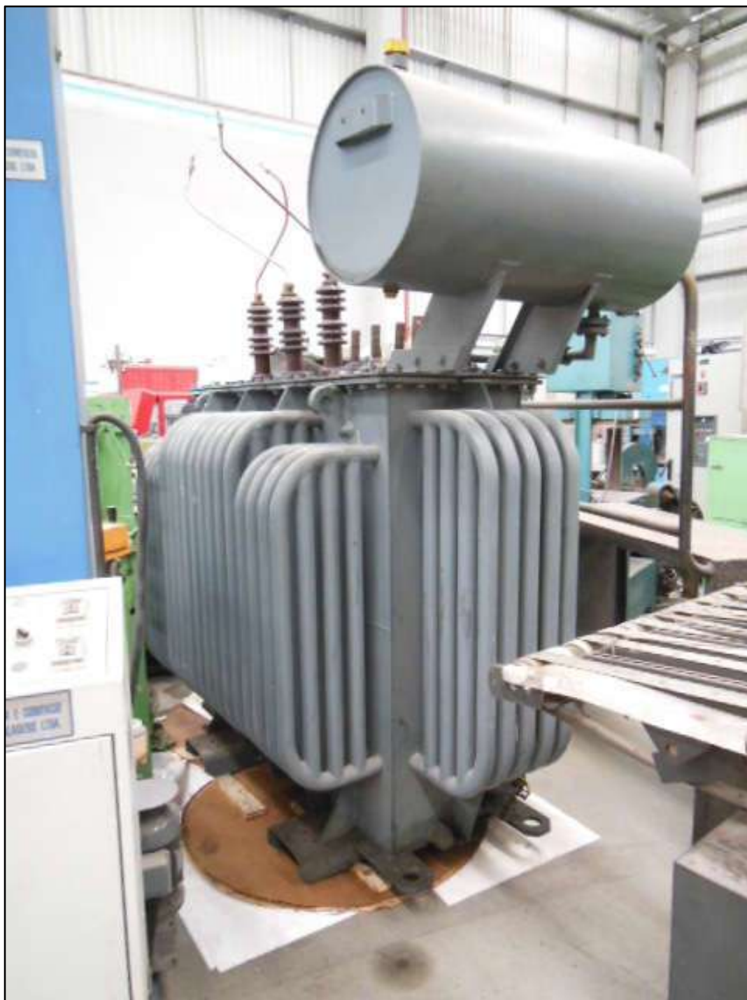
ITEM 1,064 - VISTA DO TRANSFORMADOR TRIFÁSICO A ÓLEO
