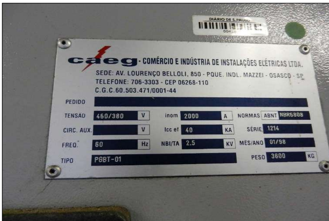
ITEM 1,123 - VISTA DO QUADRO DE COMANDO MARCA: CEAG TENSAO: 460/380V TIPO: PGBT-01 SERIE: 1214 COM 4 DISJUNTORES MARCA: ABB TIPO: SACE F1 2000 A, 4 VOLTIMETROS, 4 AMPERIMETROS E DEMAIS COMPONENTES
