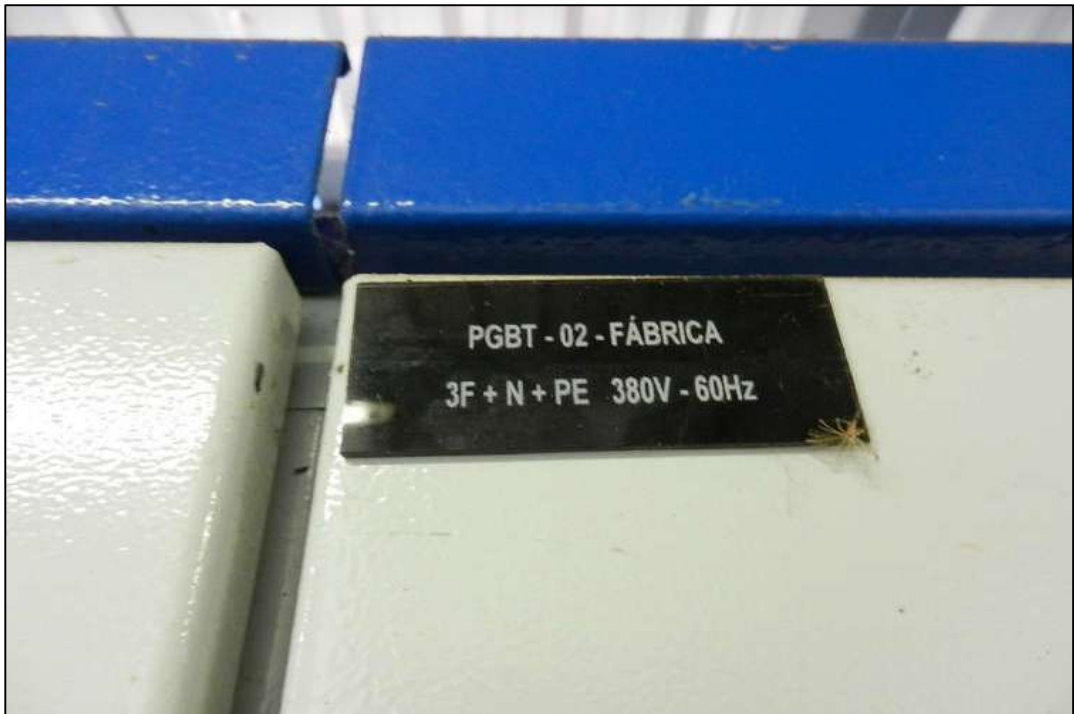
ITEM 1,126 - VISTA DO QUADRO DE COMANDO MARCA: CSW ENERGY (PGBT-02) FABRICA COM 6 MODULOS, 1 DISJUNTOR GERAL, CHAVES E DEMAIS COMPONENTES
