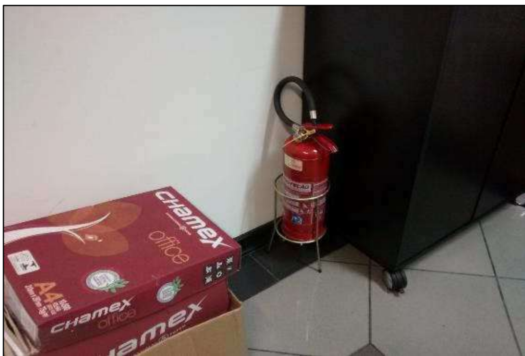
ITEM 1,209 - VISTA DO EXTINTOR DE INCÊNDIO
