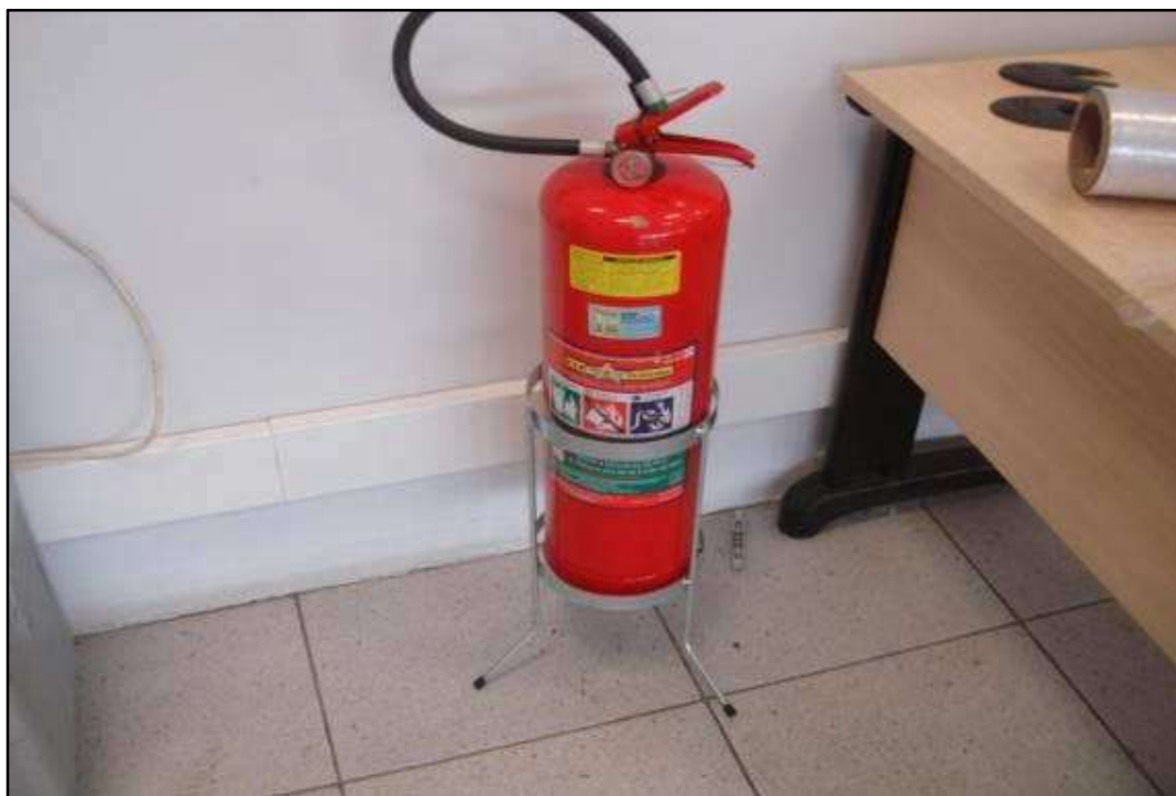
ITEM 0035 - VISTA DO EXTINTOR COM SUPORTE MARCA: CLP MOD: ÁGUA DIM: 10L
