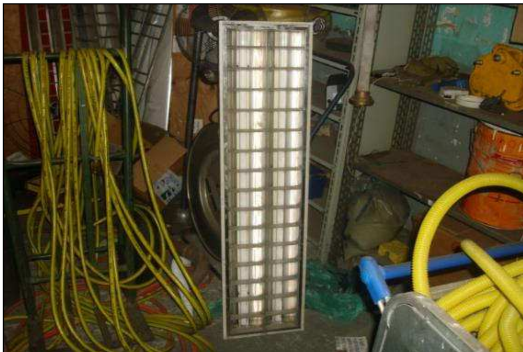
ITEM 1,851 - VISTA DAS CALHAS PARA LÂMPADAS
