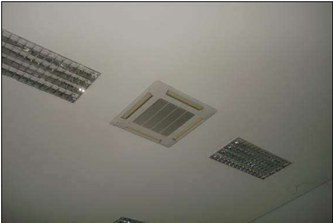
ITEM 0143 - VISTA DO AR CONDICIONADO SPLIT INVERTER MARCA: FUJITSU
