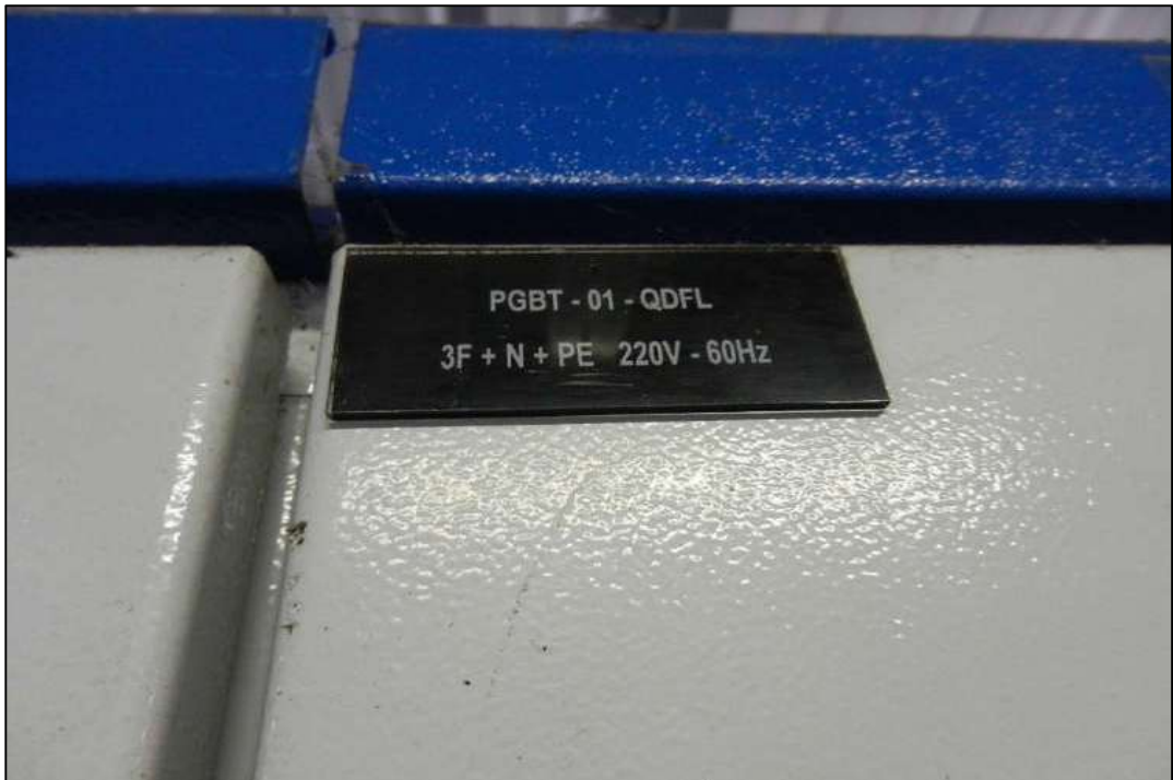
ITEM 1,127 - VISTA DO QUADRO DE COMANDO MARCA: CSW ENERGY (PGBT-01) FABRICA COM 5 MODULOS, E DEMAIS COMPPONENTES
