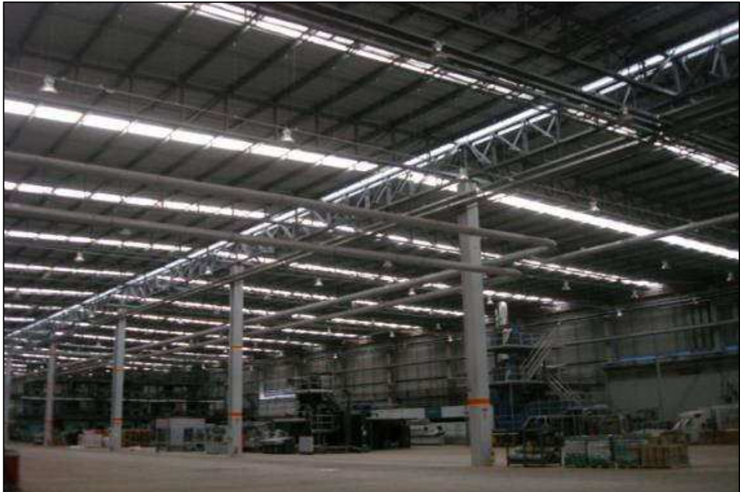
VISTA DOS DUTOS
