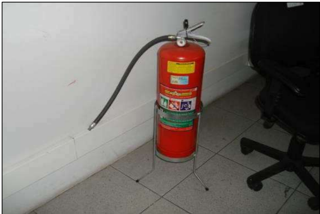
ITEM 0116 - VISTA DO EXTINTOR TIPO A 10 L
