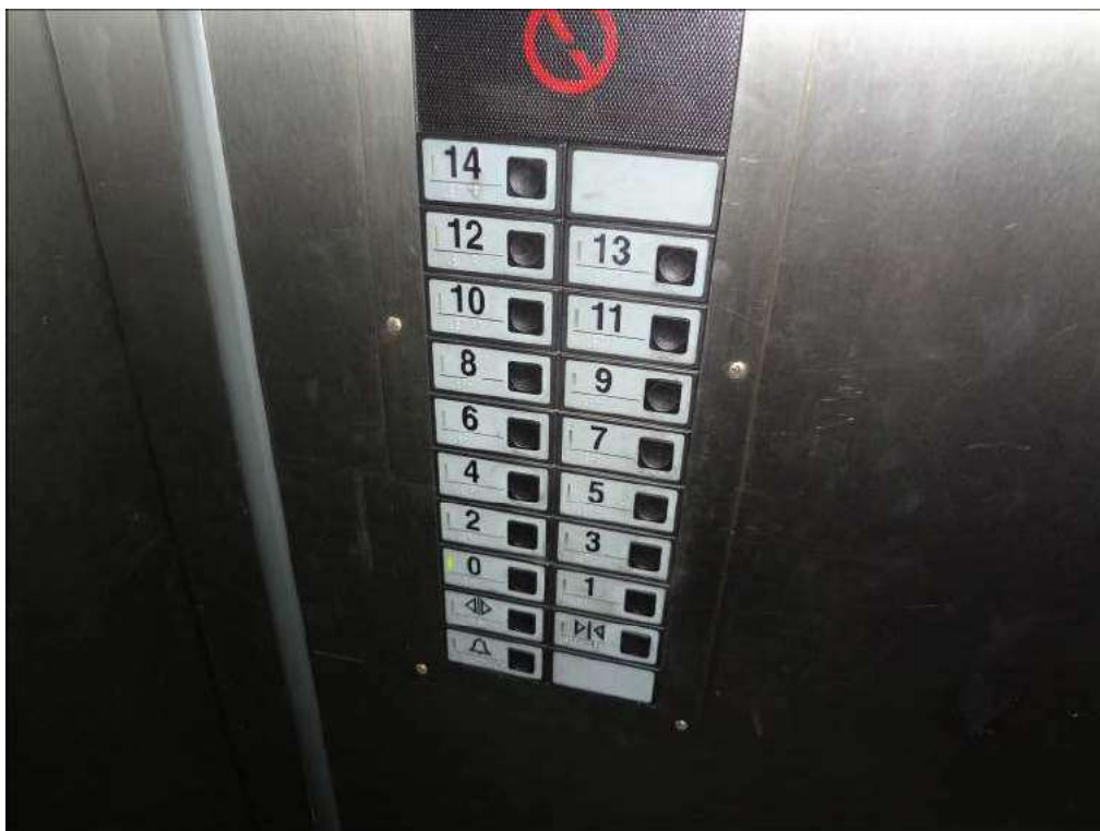
Foto 6 – Vista das botoeiras do elevador com 14 (quatorze) andares.
