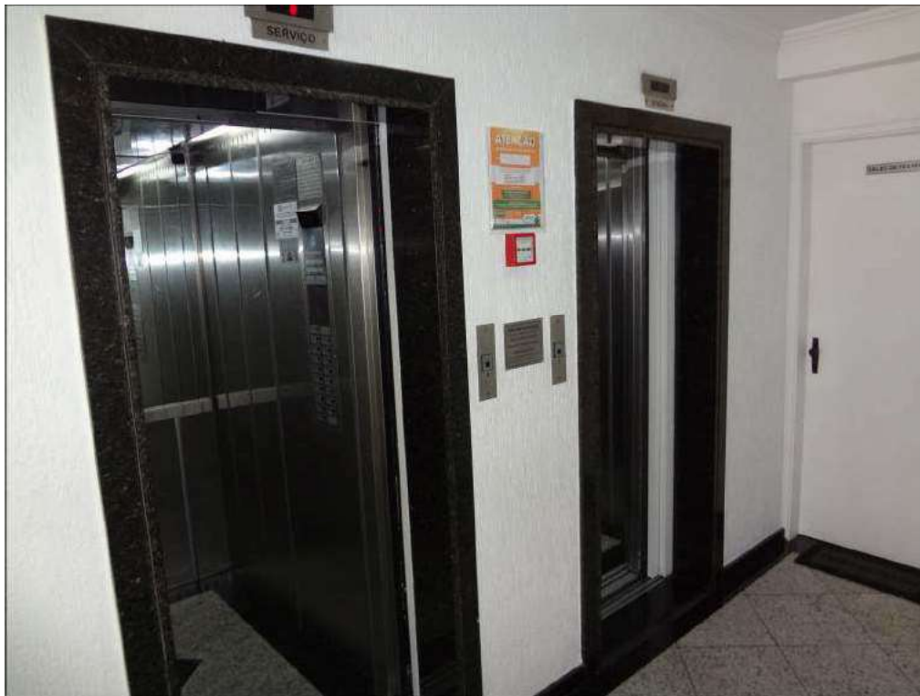
Foto 5 – Elevadores do Bloco B - Edifício Begônia.
