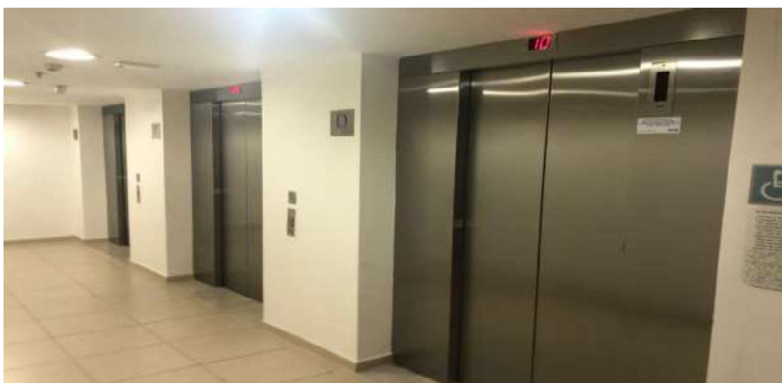
Elevadores de acesso as salas
