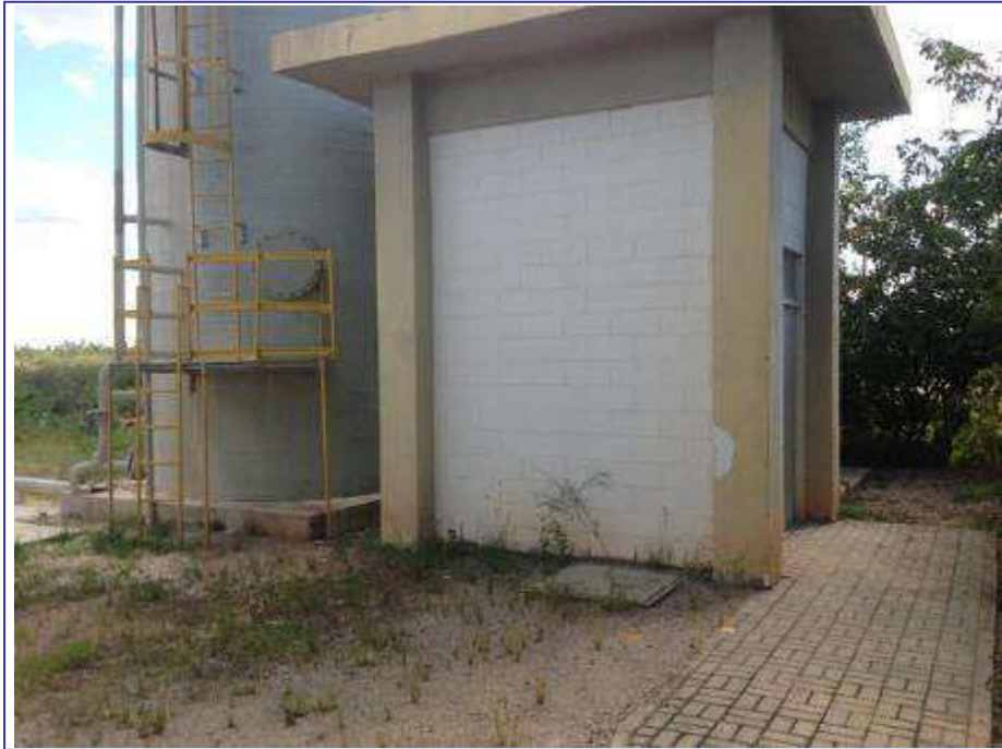
CASA DE BOMBAS
