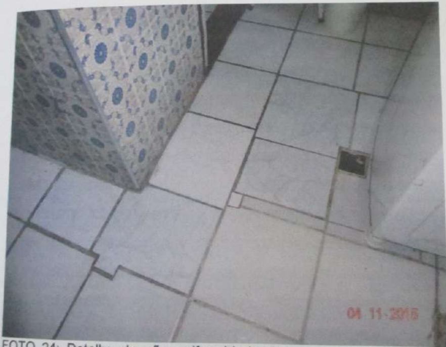
FOTO 24: Detalhe da não uniformidade das peças cerâmicas que revestem o piso da área de serviço.
