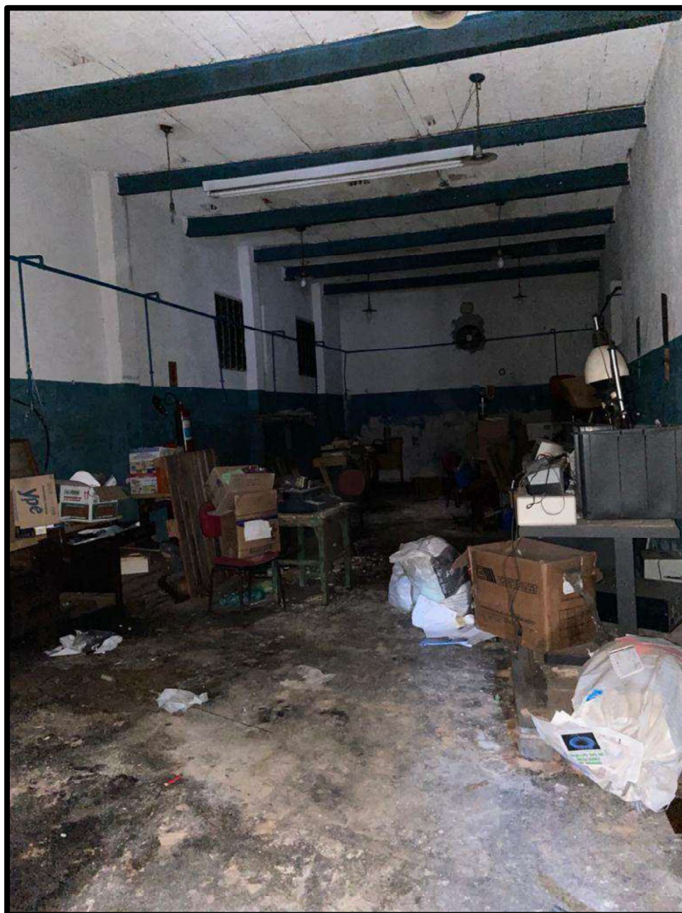
Foto nº 20 – Vista interna, denotando-se se tratar de edificação em estrutura de concreto armado e vigas metálicas com lajes pré.
