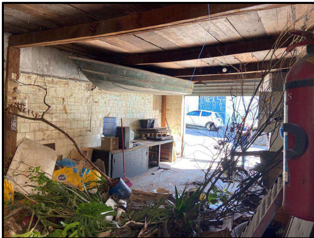
Foto nº 10 – Vista parcial do interior da edificação frontal, com acesso direto pelo logradouro de situação.
