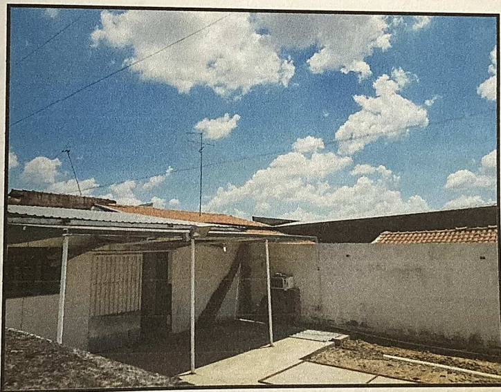
4. Vista do interior do terreno mostrando a edificação que é uma construção nos fundos.
