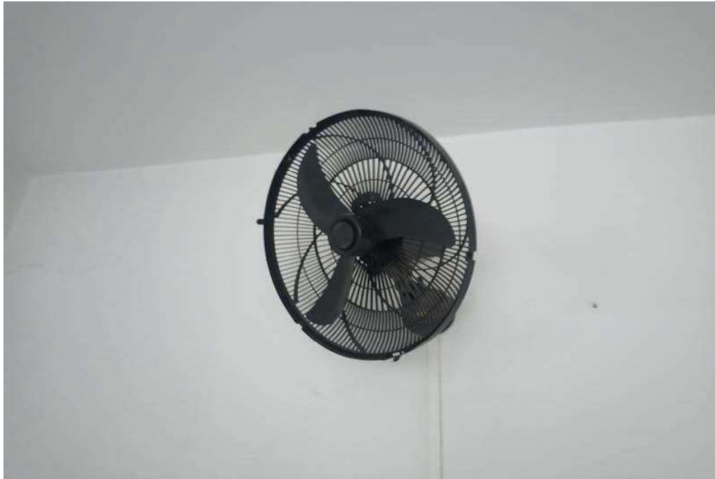
ITEM 2,005 - VISTA DO VENTILADOR DE PAREDE
