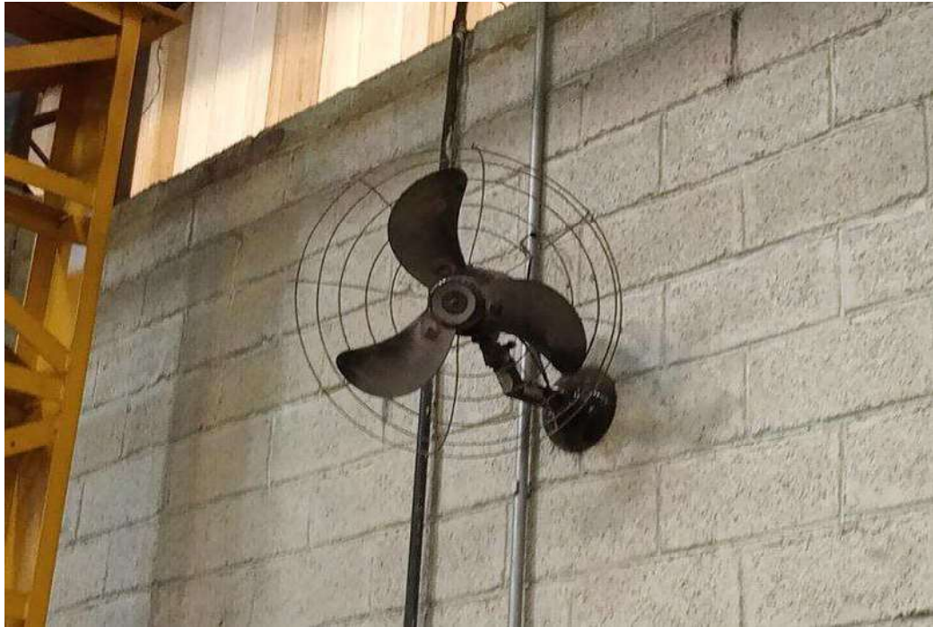
ITEM 2,001 - VISTA DO VENTILADOR DE PAREDE
