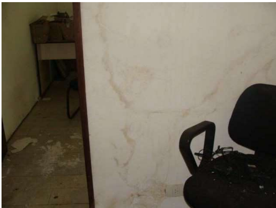
Foto 16. Detalhe para os focos de bolor e umidade na parede de divisa da sala 2 com a sala 3.
