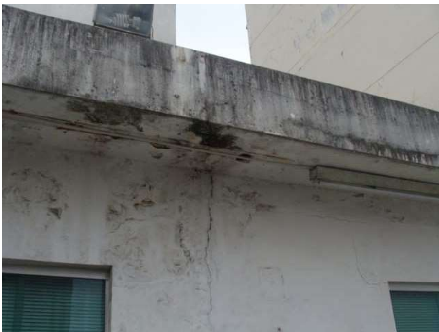
Foto 10. Detalhe para os focos de bolor e umidade generalizados, além de fissuras e trincas, na parede da fachada e no beiral da cobertura.
