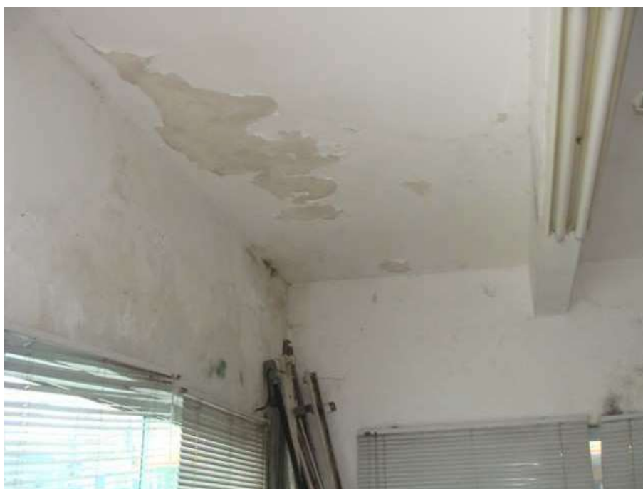
Foto 12. Detalhe para os focos de bolor e umidade, além de descascamento da pintura nas paredes e teto da sala 1.
