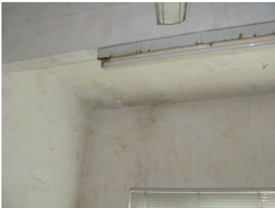
Foto 15. Detalhe para os focos de bolor e umidade, além de descascamento da pintura nas paredes e teto da sala 2.
