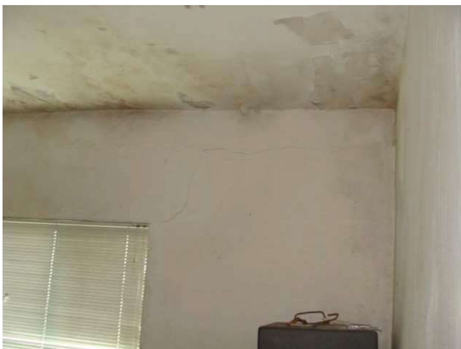
Foto 18. Detalhe para os focos de bolor e umidade e trincas, além de descascamento da pintura nas paredes e teto da sala 3.
