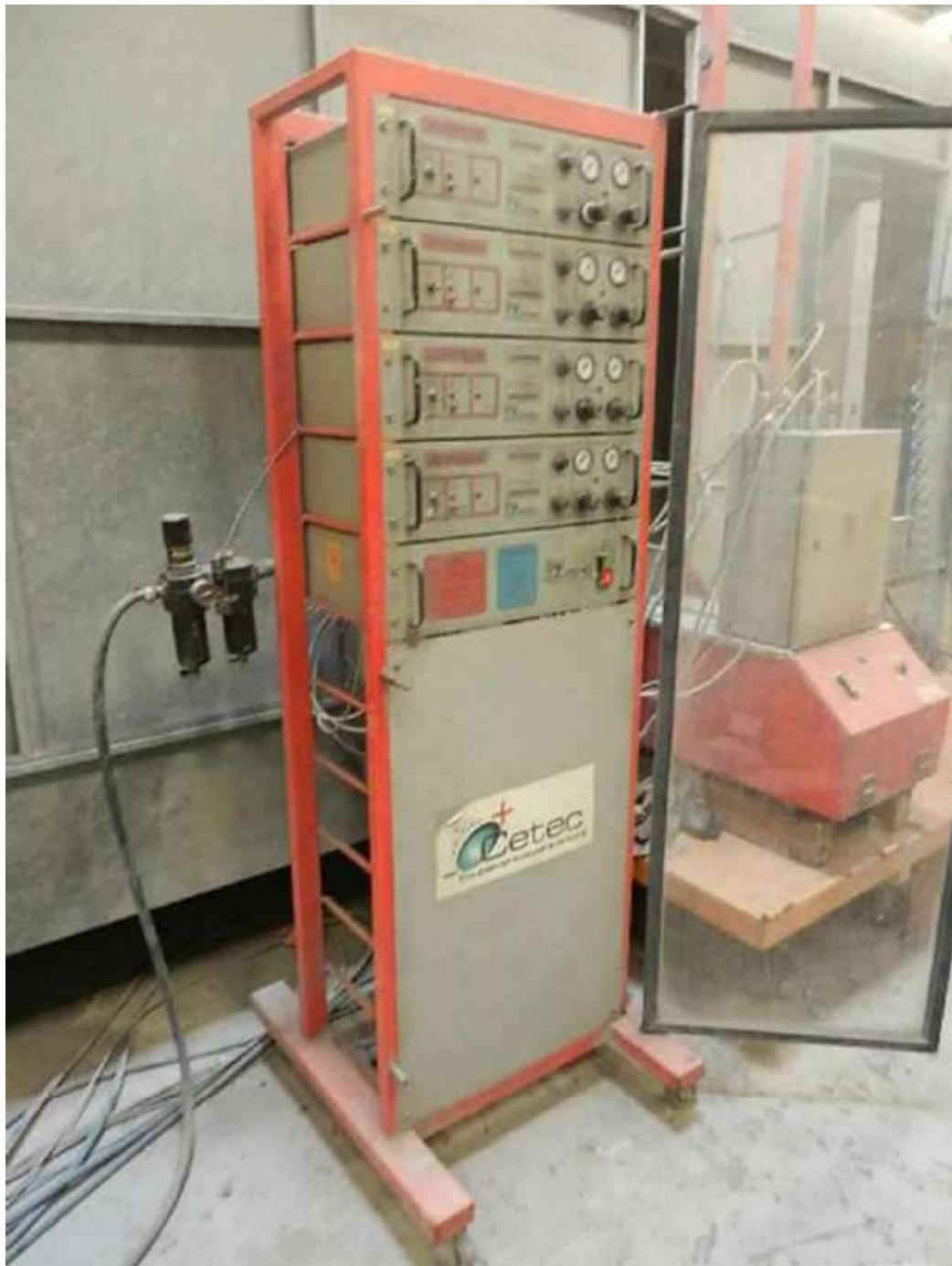
ITEM 1,038 - VISTA DA CABINE DE PINTURA MODELO: CPPE-ACGFD N° 2367-003 DIM: 1.600 X 700 MM COM 4 BICOS MODELO: AUTOPLUS DA LINHA DE PINTURA A PO MARCA: ERZINGER,
