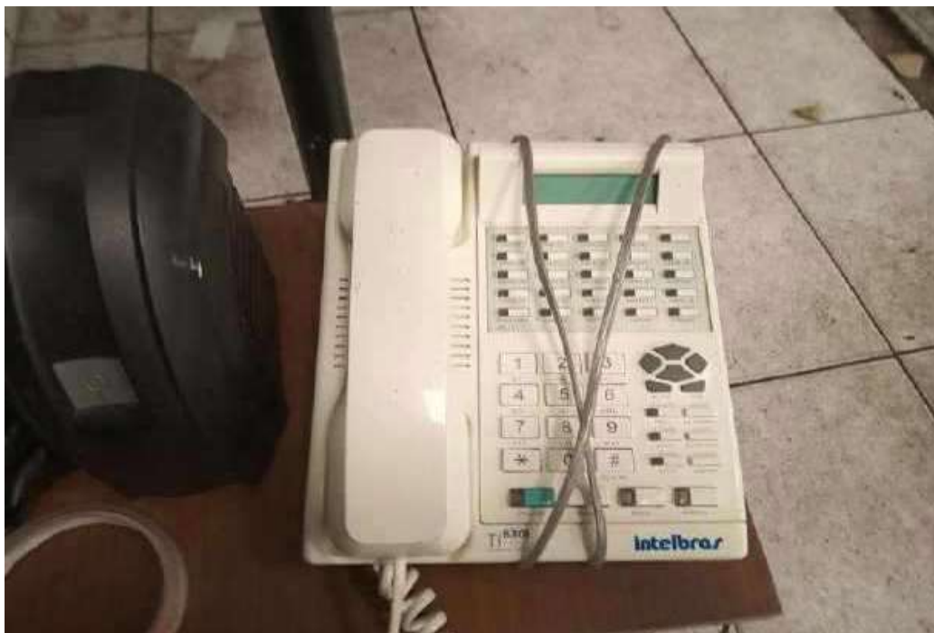
ITEM 2,008 - VISTA DO TELEFONE MARCA: INTELBRAS MODELO: TI 6301
