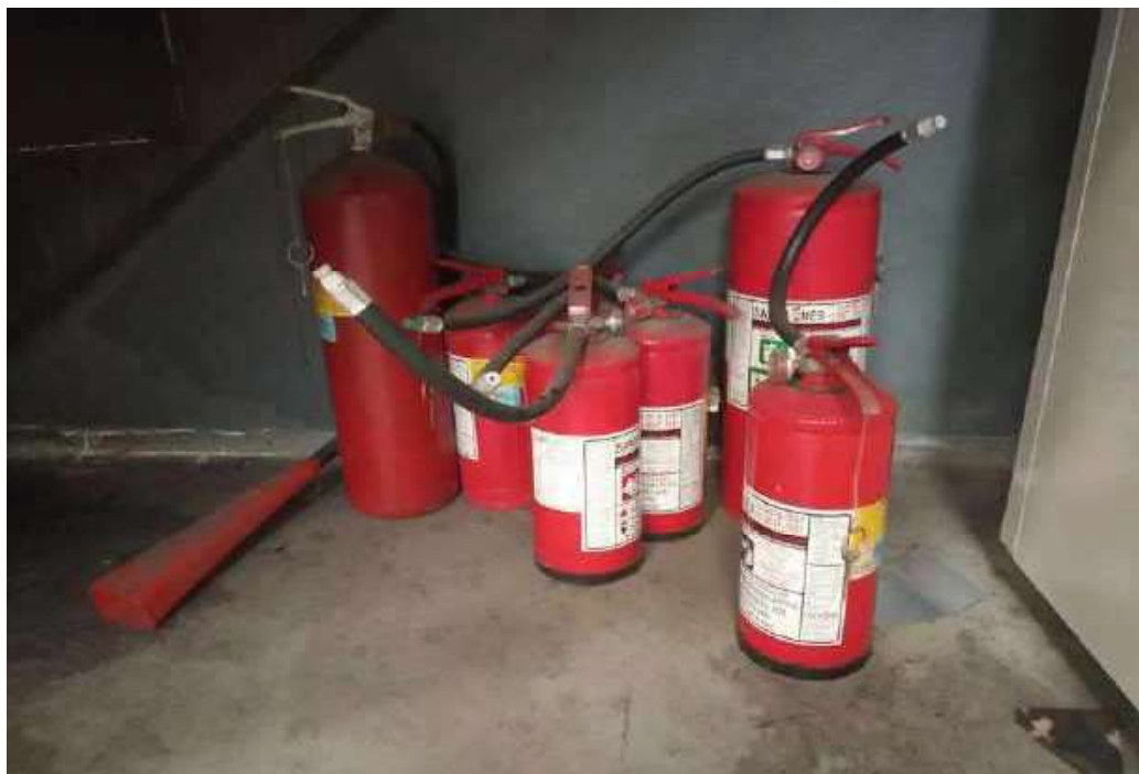
ITEM 4,001 - VISTA DO EXTINTOR
