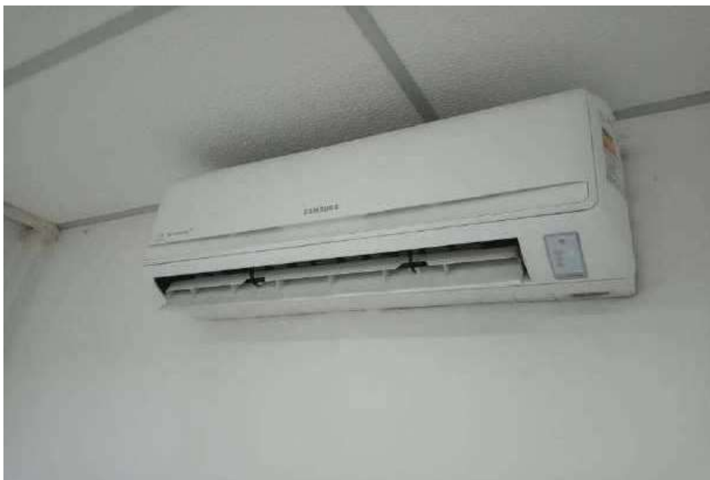
ITEM 2,025 - VISTA DO AR CONDICIONADO 9.000 BTUS MARCA: SAMSUNG MOD: AQ09UWBUNXAZ
