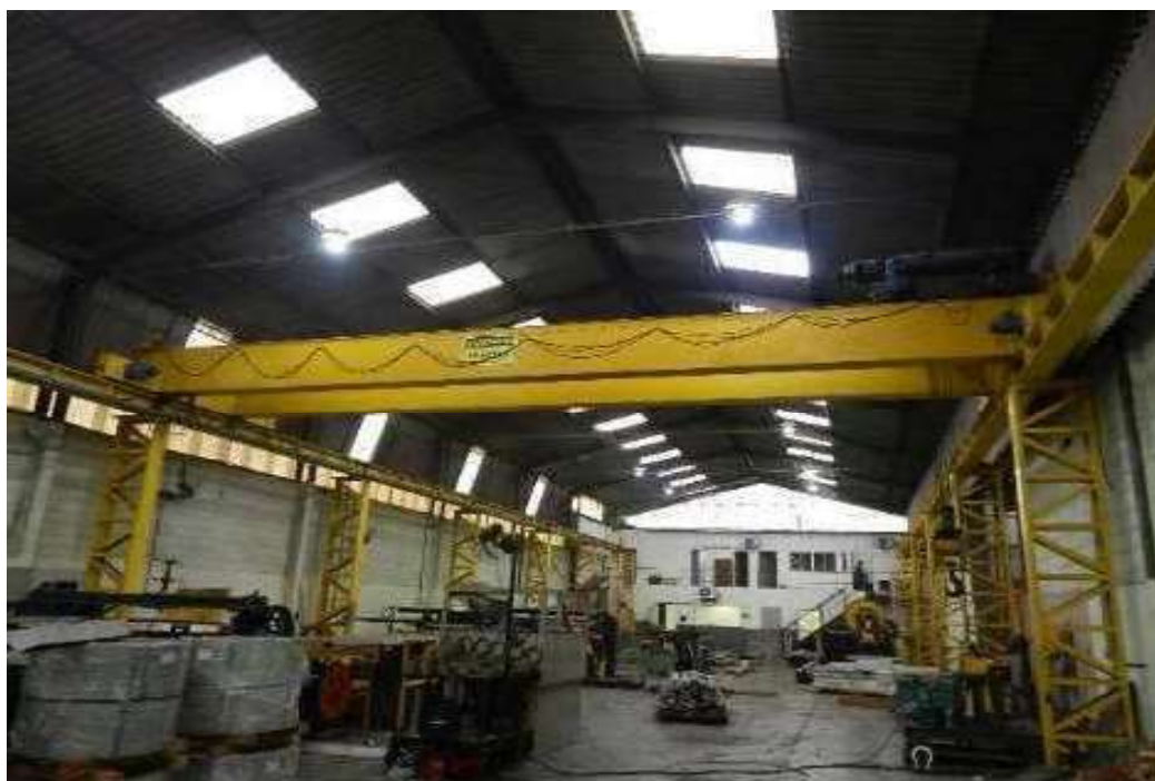
ITEM 1,037 - VISTA DA PONTE ROLANTE DUO VIGA CAP: 15 TON COM TALHA COM TROLEY MOTORIZADO COMANDO POR BOTOEIRA
