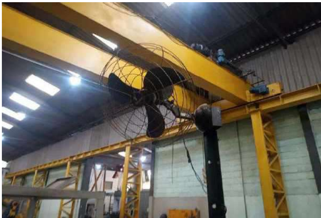
ITEM 2,003 - VISTA DO VENTILADOR DE PAREDE
