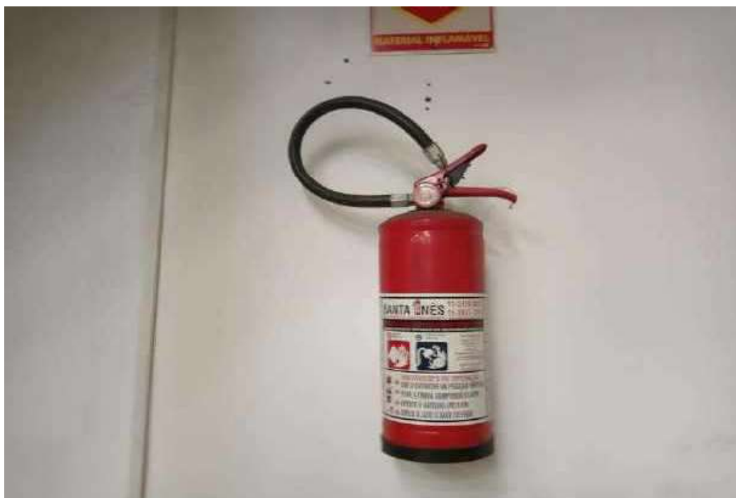
ITEM 4,001 - VISTA DO EXTINTOR
