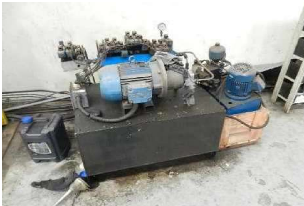
ITEM 1,024 - VISTA DA UNIDADE HIDRAULICA COM MOTOR ELETRICO DE 10 CV
