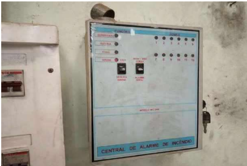
ITEM 4,003 - VISTA DO CENTRAL DE ALARME DE INCÊNDIO
