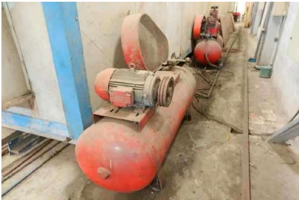
ITEM 1,038 - VISTA DOS COMPRESSORES DE AR MARCA: WAYNE DA LINHA DE PINTURA
