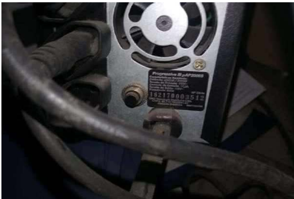
ITEM 3,047 - VISTA DA PLACA DE IDENTIFICAÇÃO DO ESTABILIZADOR MARCA: SMS MOD: PROGRESSIVE III AP200S
