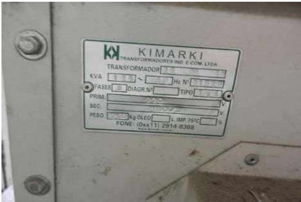
ITEM 1,027 - VISTA DA PLACA DE IDENTIFICAÇÃO DO TRANSFORMADOR ELETRICO CAP: 125 KVA MARCA: KIMARKI
