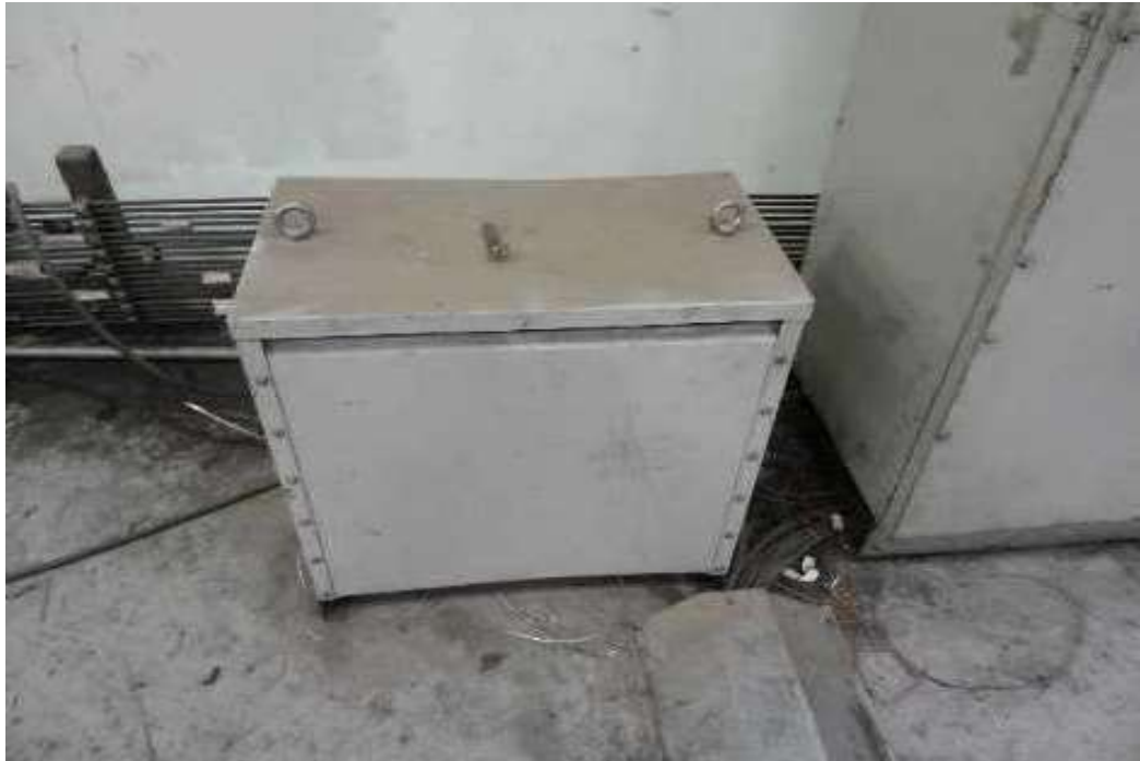
ITEM 1,027 - VISTA DO TRANSFORMADOR ELETRICO CAP: 125 KVA MARCA: KIMARKI
