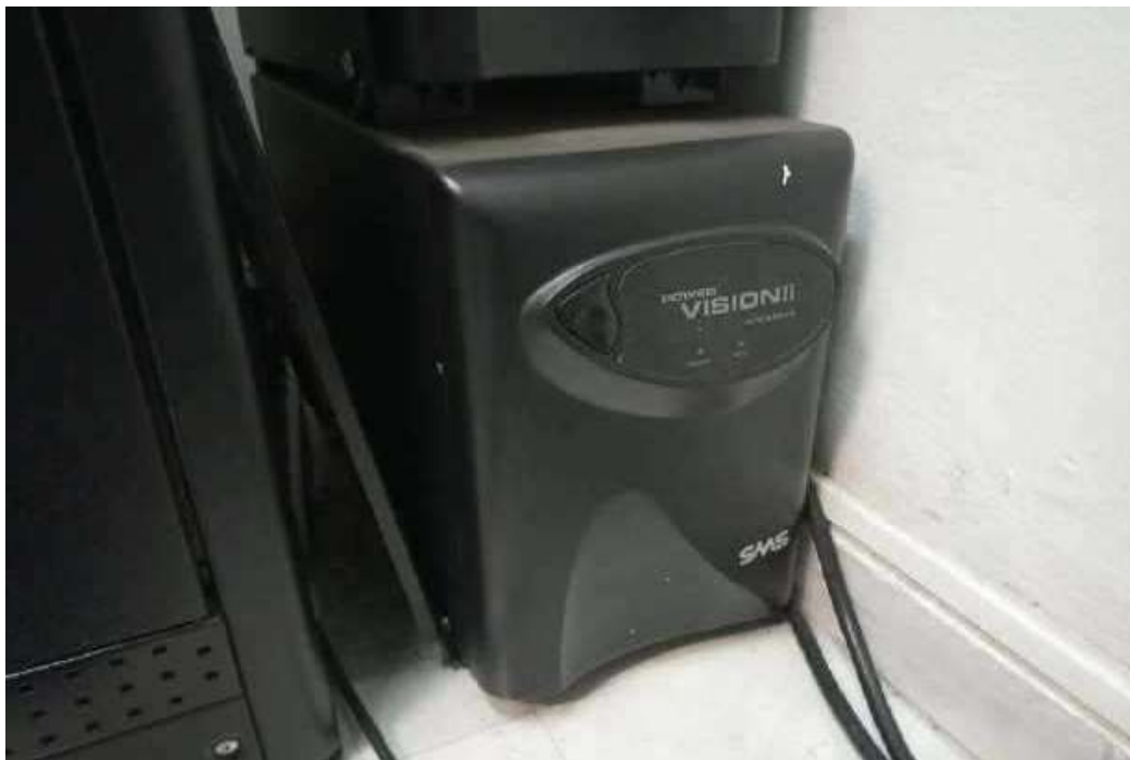
ITEM 3,041 - VISTA DO NOBREAK MARCA: SMS MOD: POWER VISION II
