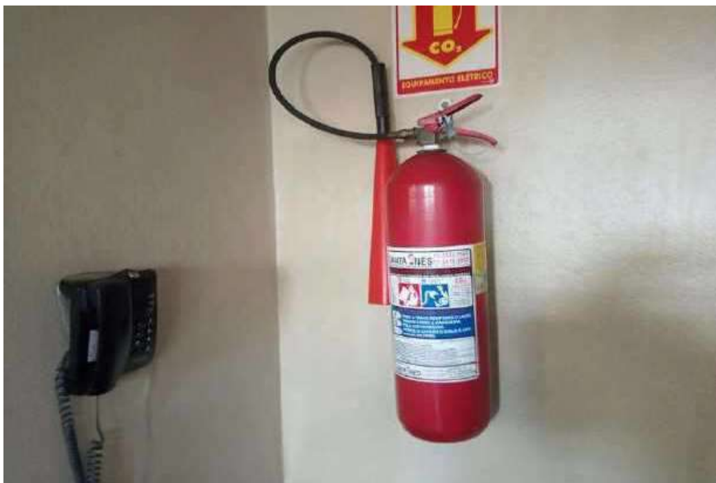
ITEM 4,010 - VISTA DO EXTINTOR
