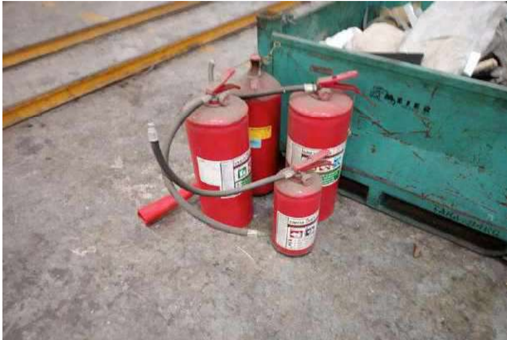
ITEM 4,002 - VISTA DO EXTINTOR
