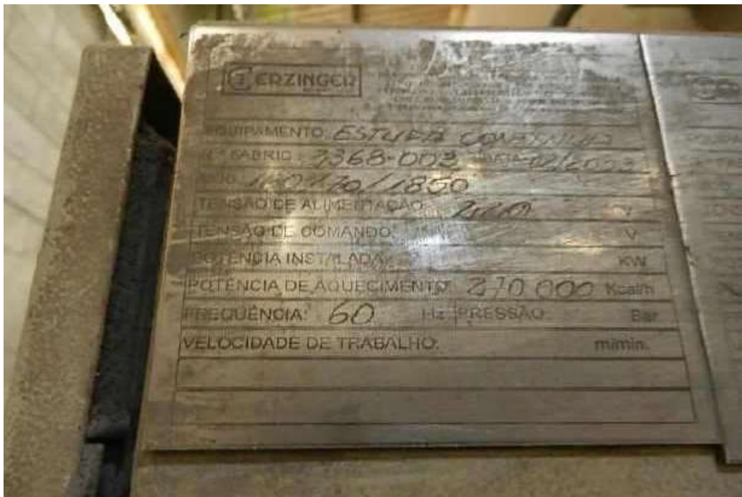
ITEM 1,038 - VISTA DA PLACA DE IDENTIFICAÇÃO DA ESTUFA PARA SECAGEM COM 2 CAMARAS MODELO: 160170/1850 N° FAB: 2368-003 DA LINHA DE PINTURA
