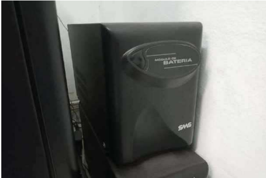
ITEM 3,040 - VISTA DO MODULO DO BATERIA MARCA: SMS
