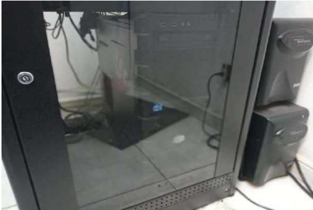
ITEM 3,042 - VISTA DO SERVIDOR COOLER MASTER XEON
