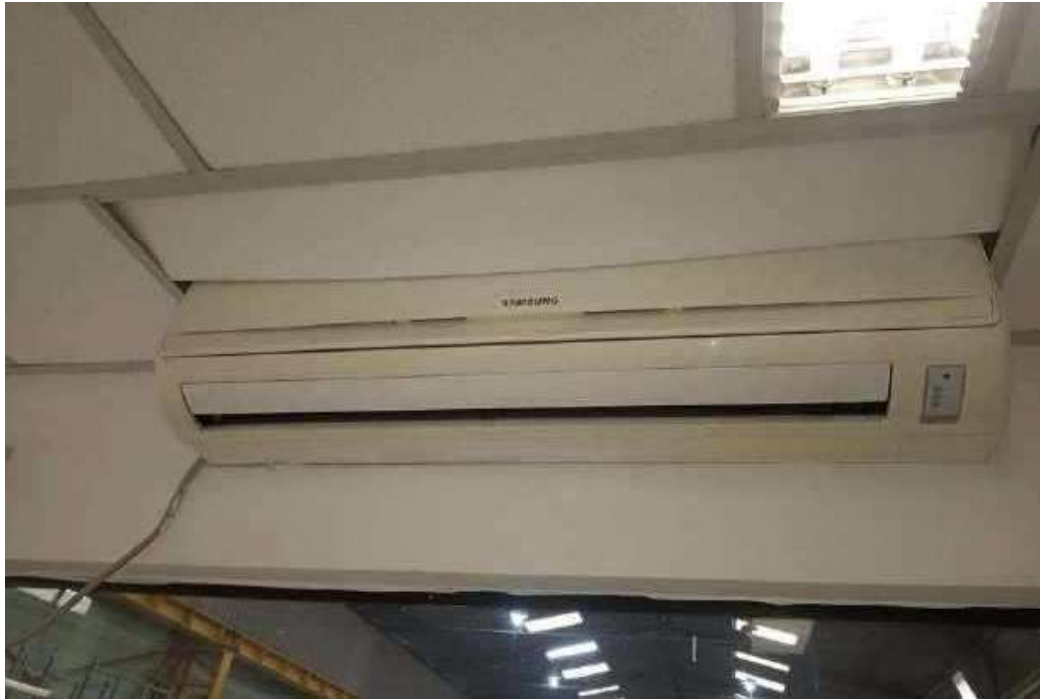
ITEM 2,014 - VISTA DO AR CONDICIONADO 24.000 BTUS MARCA: SAMSUNG MOD: AS24UBANXAZ
