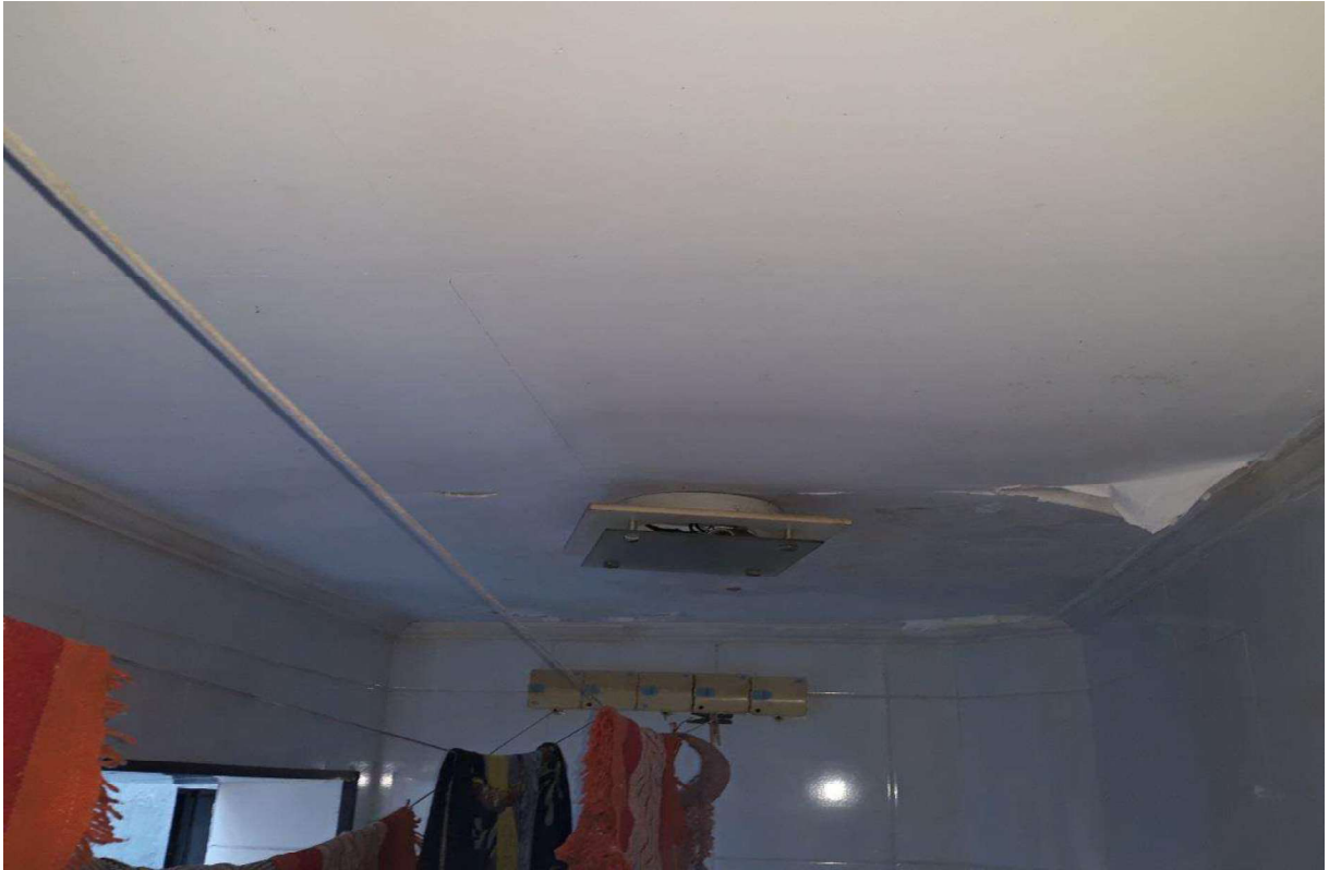
FOTO 14 – Vista parcial do interior do imóvel (lavanderia) onde se visualiza as manchas de umidade e bolor no forro de gesso, originários de provável infiltração do piso superior.
