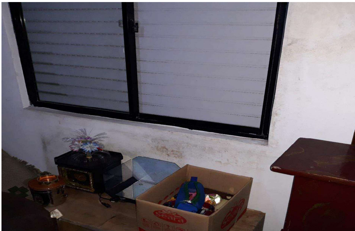
FOTO 13 – Vista parcial do interior do imóvel (dormitório "2") onde se visualiza as manchas de umidade e bolor no entorno da janela.
