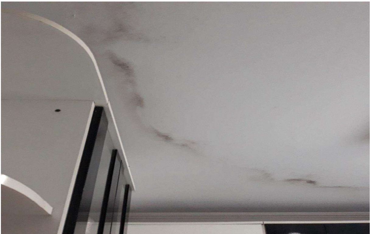
FOTO 15 – Vista parcial do interior do imóvel (cozinha) onde se visualiza as manchas de umidade e bolor na laje do teto, originários de provável infiltração pelo piso superior.
