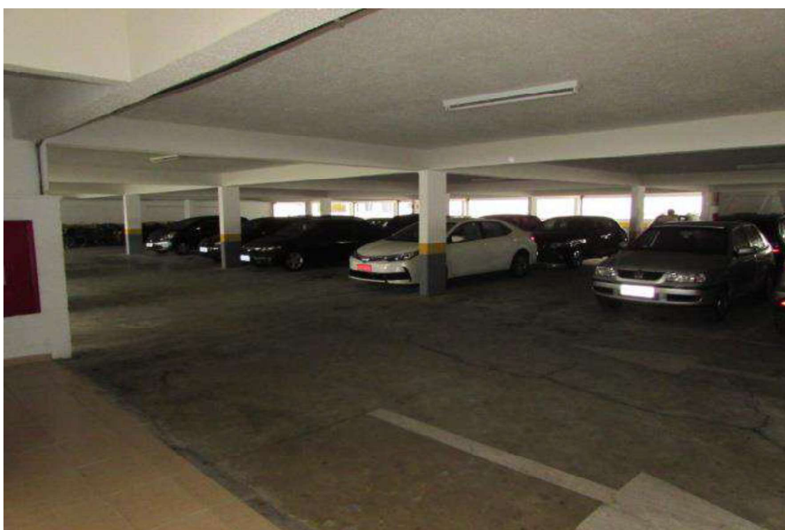
Foto 12 – Vista do estacionamento o qual a unidade avalianda nº 148 tem direito à uma vaga.
