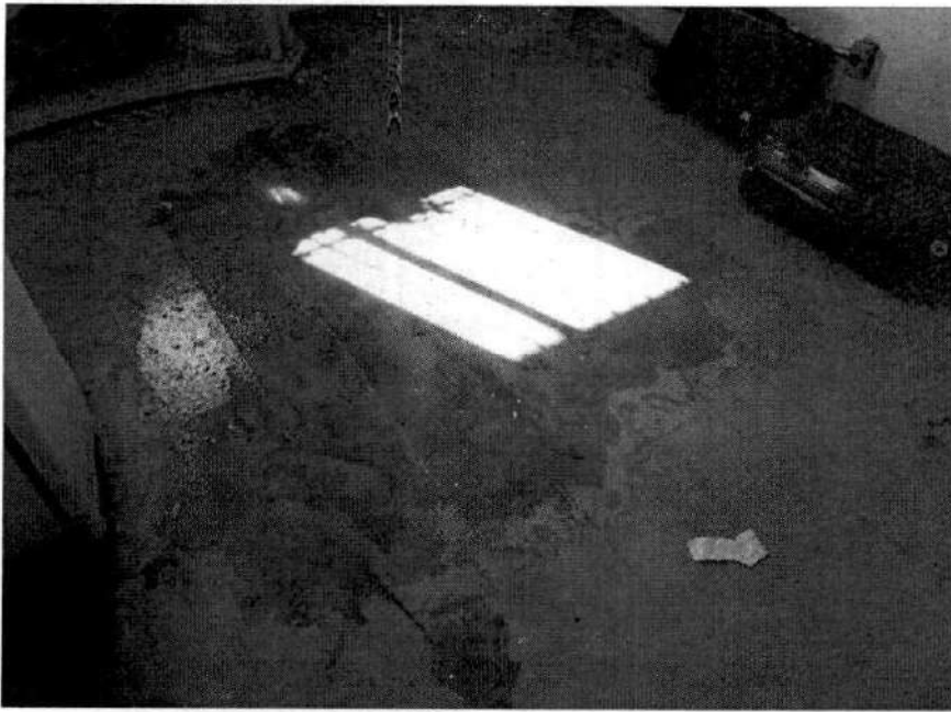
Foto 16 – vazamento no teto do quarto
