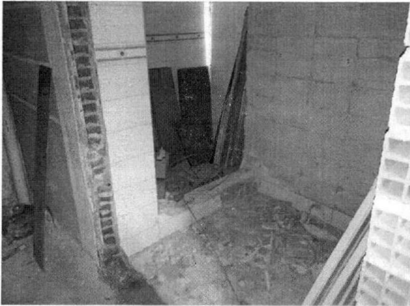
Foto 18 – detalhe de parede derrubada na obra
