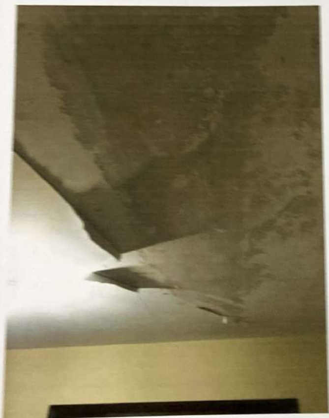
Detalhe do destacamento do revestimento no teto do dormitório 3.
