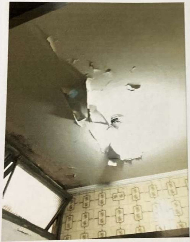
Detalhe do destacamento do revestimento do teto do banheiro da suíte.
