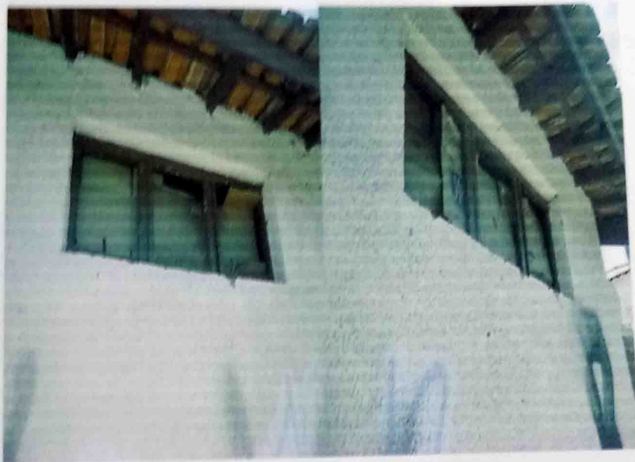
Fotos 5 – Detalhe de danos em vidros de janelas frontais.
