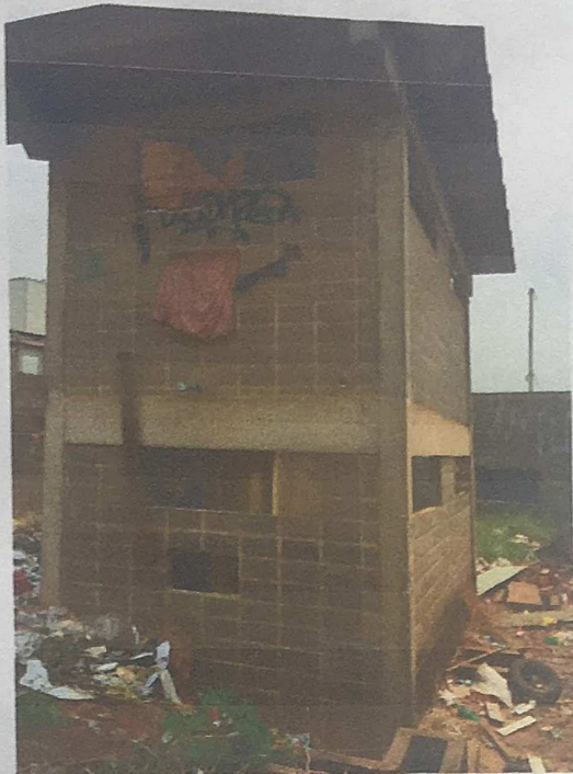
Foto 03 – Construção não considerada - Área "A"
