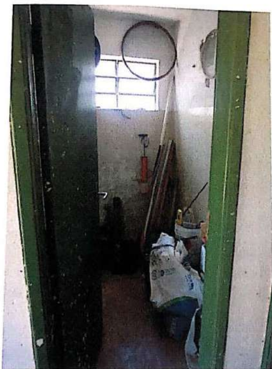
Foto N. 57 – 03ª Residência – WC Interno. Laje e Piso em Cimento Queimado. Péssimo Estado de conservação.
