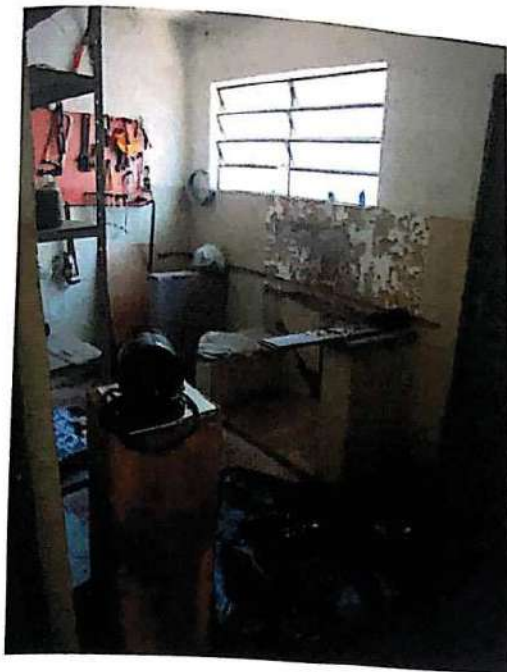
Foto N. 56 – 03ª Residência – Cozinha. Laje e Piso em Cimento Queimado. Péssimo Estado de conservação.
