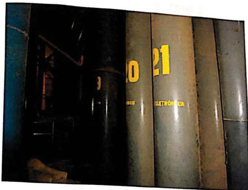
Fotos N.75 – Tubulações de Elevação (Elevadores) – 21 Unidades.
