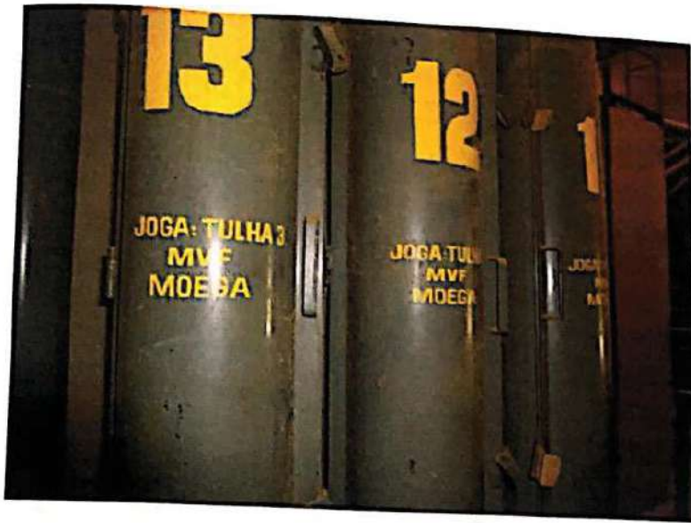
Foto N. 79 – Tubulações de Elevação (Elevadores) – das Tulhas para Moegas.
