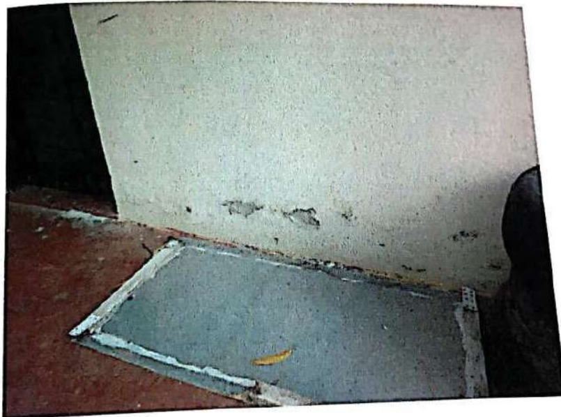
Fotos N. 65 e 66 – Umidades Externas junto às fundações/baldrames.
