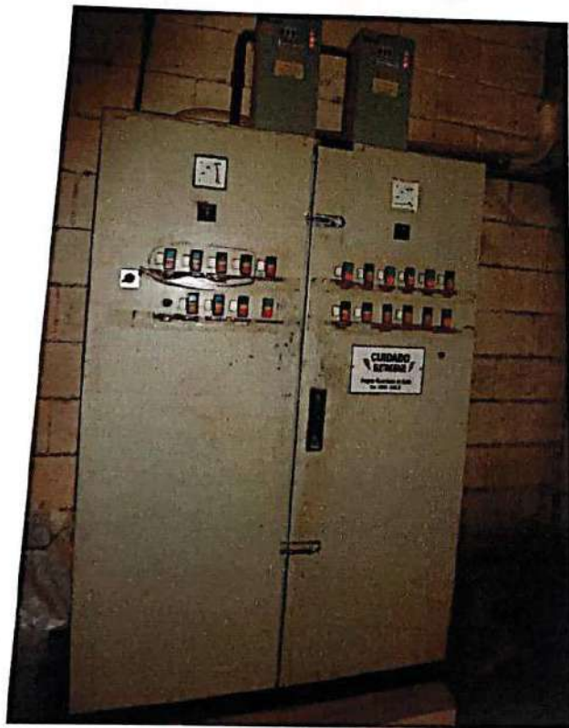
Foto N. 86 – Grande Painel Elétrico.
