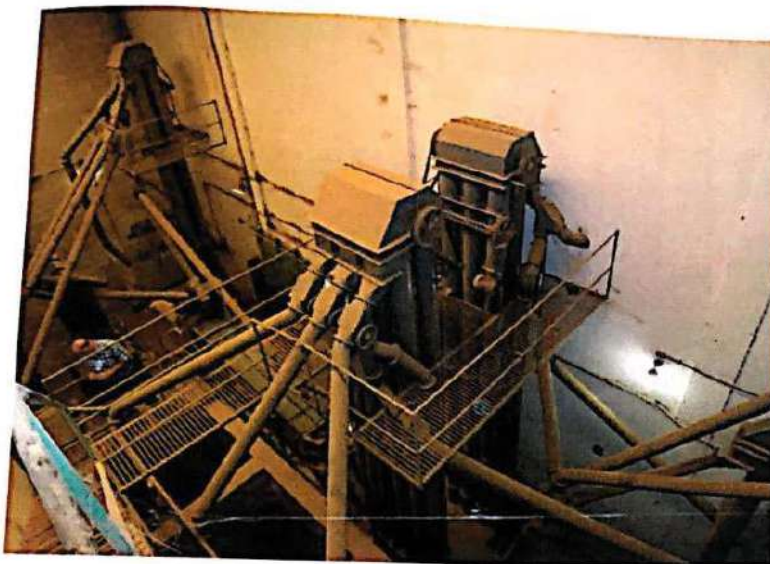
Fotos N.93, 94 e 95 – Tubulações e Maquinários Diversos.
