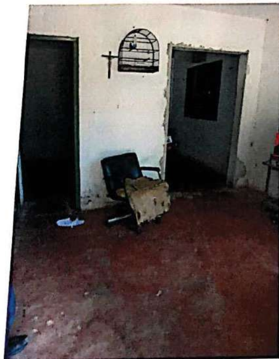
Foto N. 53 – 03ª Residência – Sala Interna. Laje e Piso em Cimento Queimado. Péssimo Estado de conservação.
