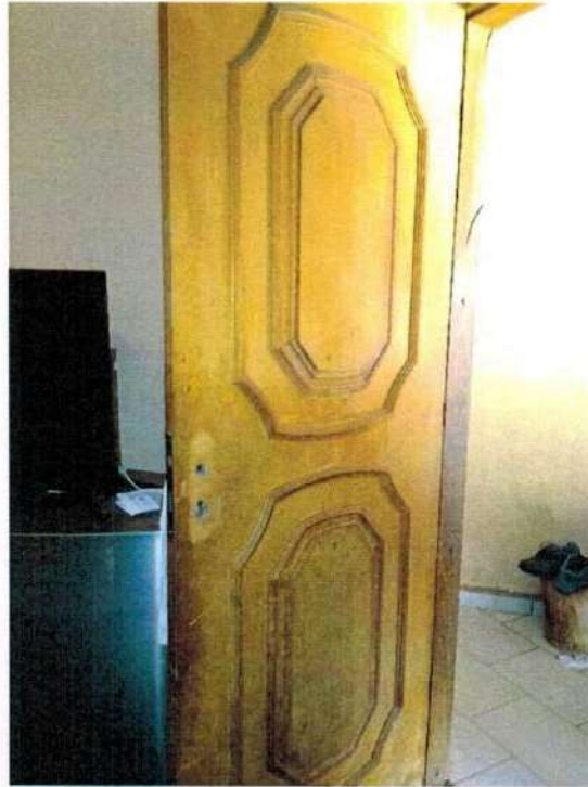
Porta da Sala. Necessita de manutenção/substituição.
