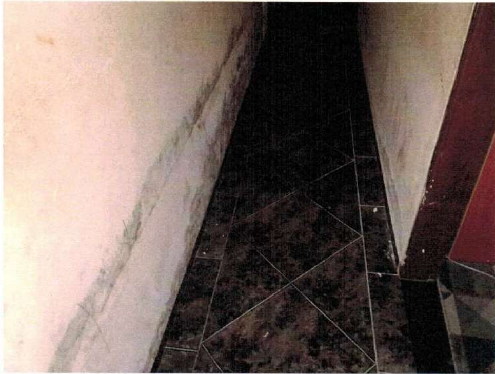
Paredes com Pontos de Umidades.
