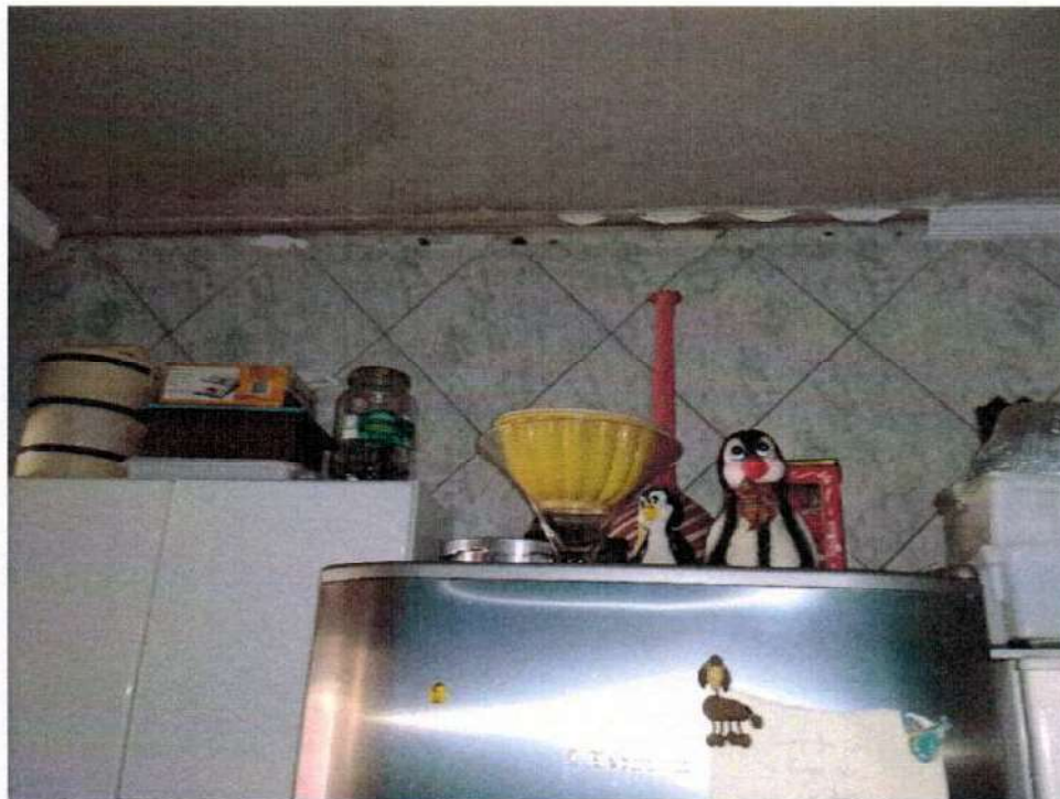
Gesso teto da cozinha. Necessitam de reparos.
