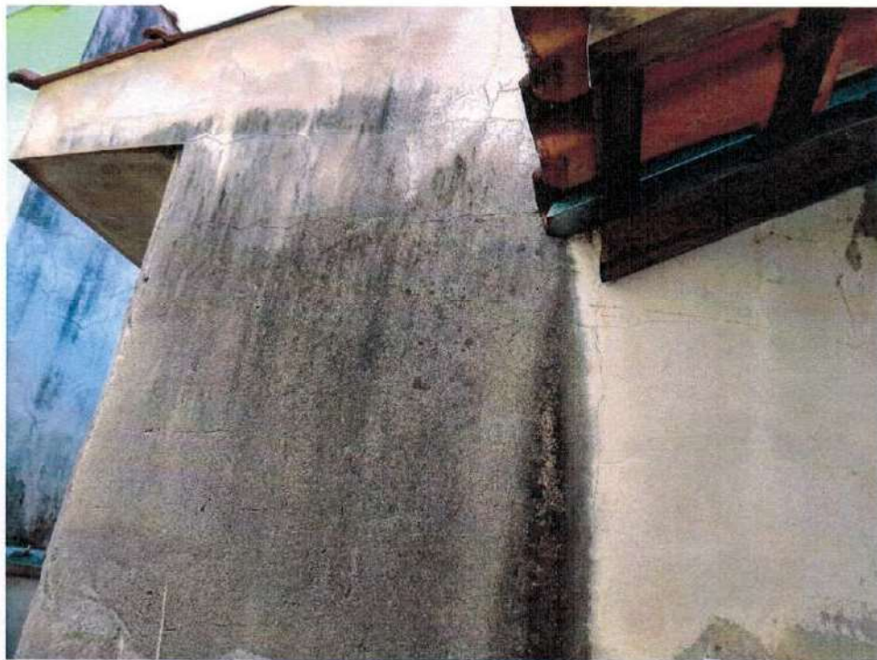
Área de Serviço. Pontos de Umidade.
