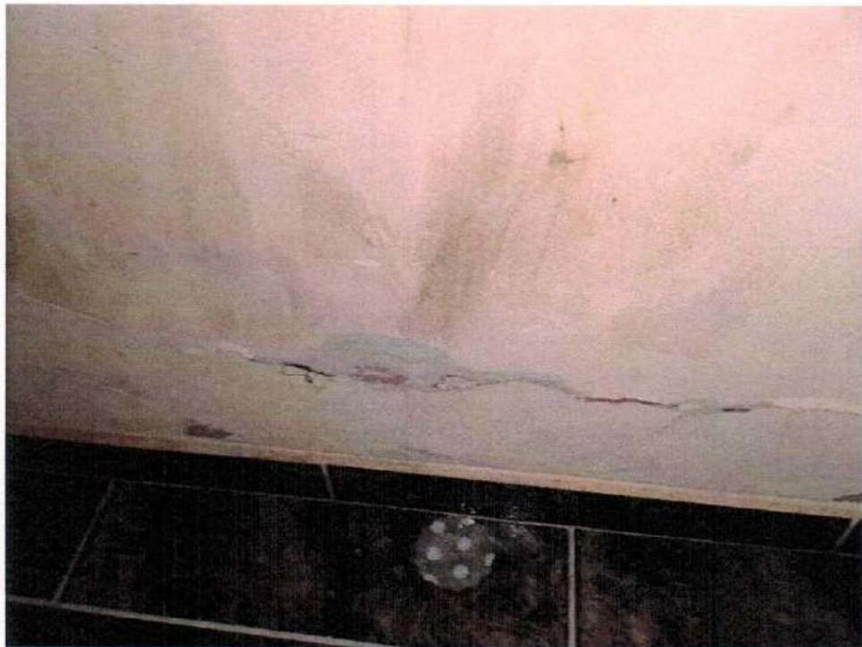
Umidades e Trincos no Reboco. Corredor Interno.
