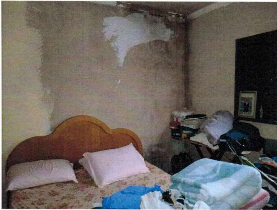
Quarto 2 (principal) Pontos de Umidade.
