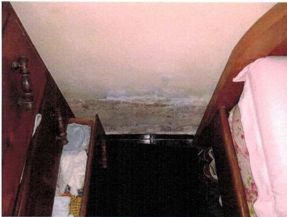
Quarto 2 (principal). Pontos de Umidade. Vista Parede Inferior.
