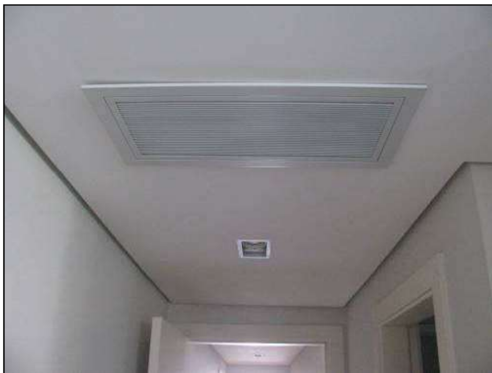
FOTO 19 VISTA DO DUTO DO AR CONDICIONADO.
