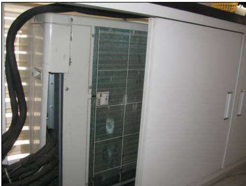
FOTO 30 VISTA DO EQUIPAMENTO DE AR CONDICIONADO CENTRAL.
