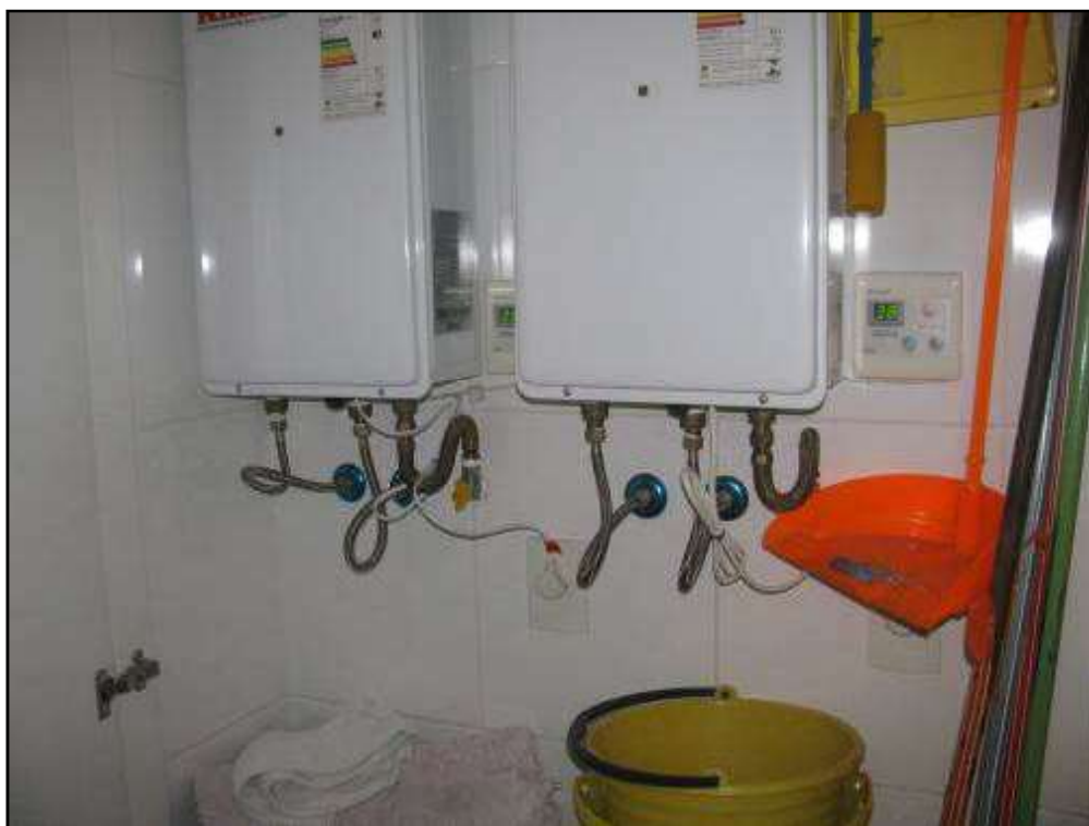
FOTO 29 VISTA DA ÁREA DE SERVIÇO COM 2 AQUECEDOR.
