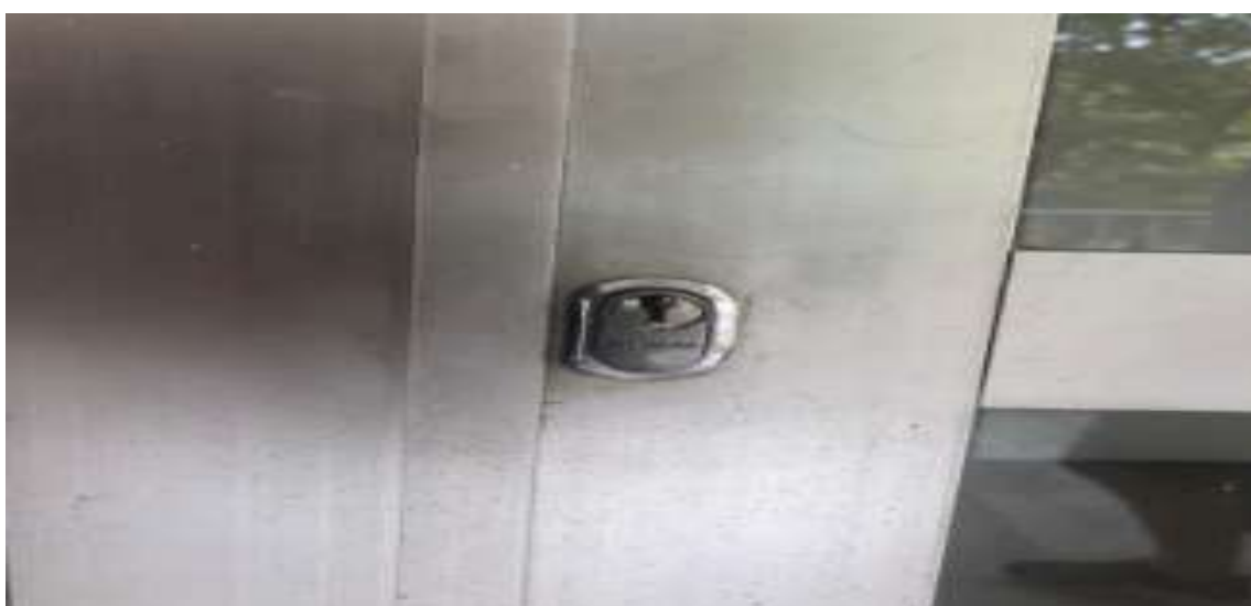
Miolo da fechadura intacto
