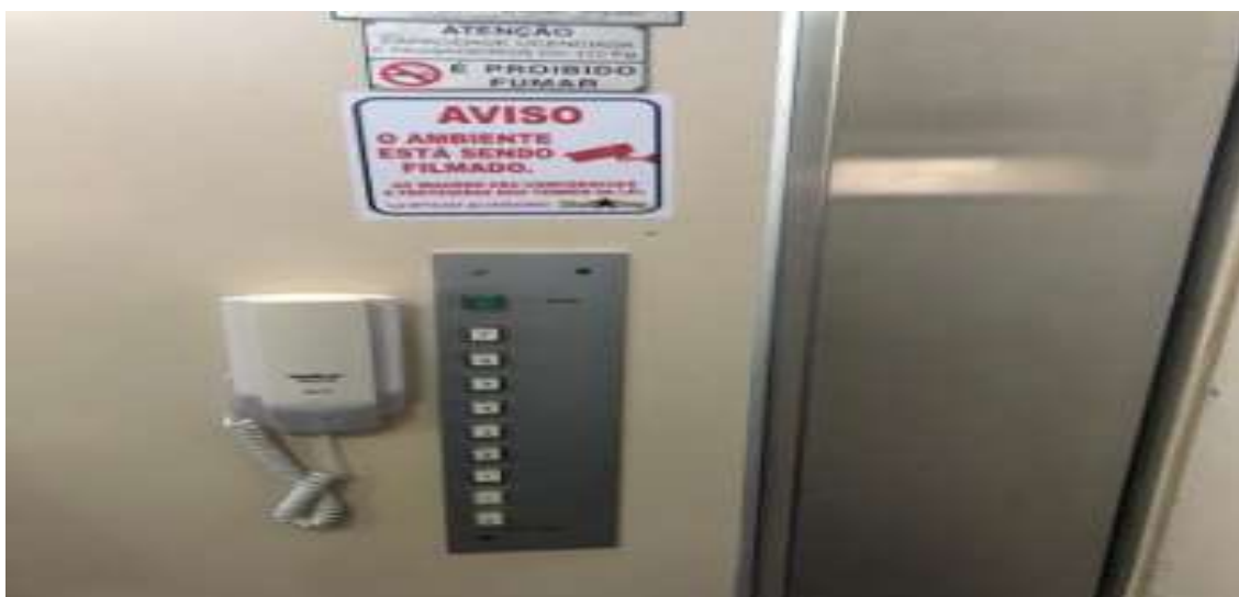
Visão interna do elevador
